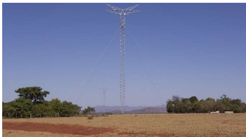
Figura 9 - Estrutura estaiada de linha de transmissão.
