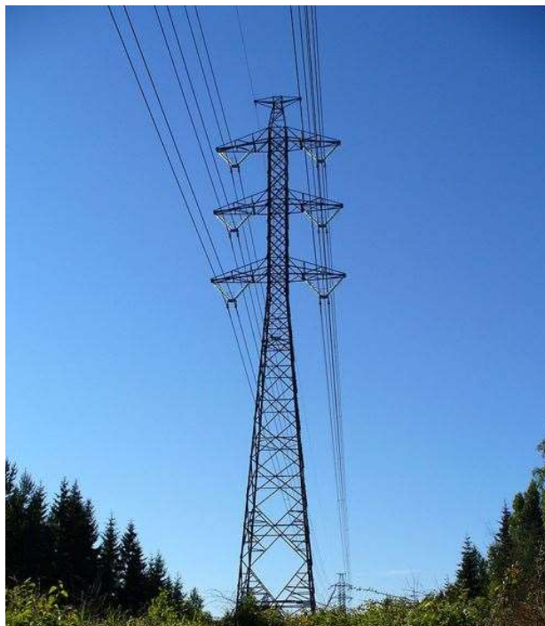
Figura 8 - Estrutura autoportante de linha de transmissão.
