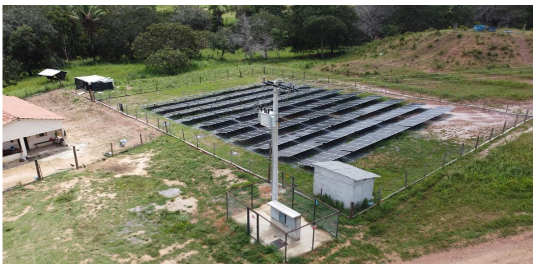
Figura 94. Usina Fotovoltaica concluída – detalhe da subestação.
