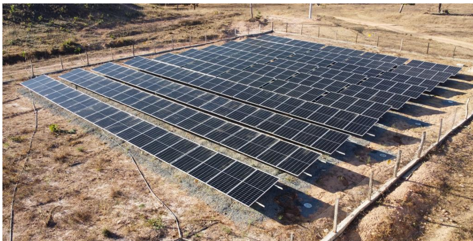
Figura 89. Usina Fotovoltaica concluída – vista aérea 1.
