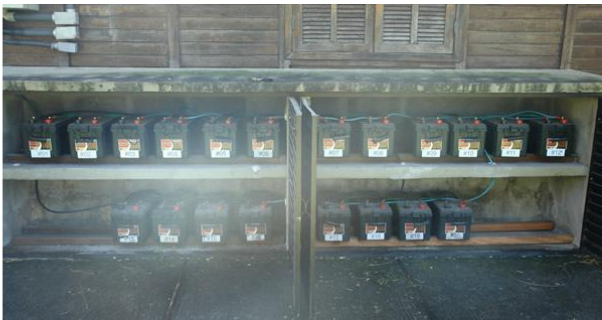
Figura 51. Banco de baterias.
