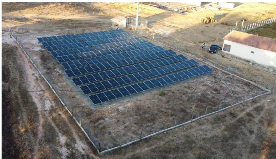
Figura 93. Usina Fotovoltaica concluída – detalhe do sombreamento 2.
