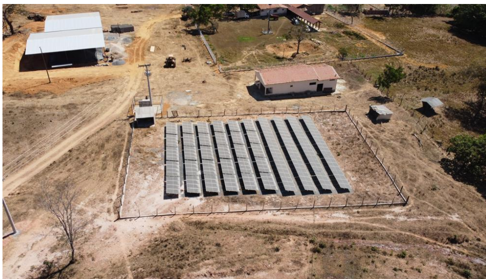
Figura 90. Usina Fotovoltaica concluída – vista aérea 2.
