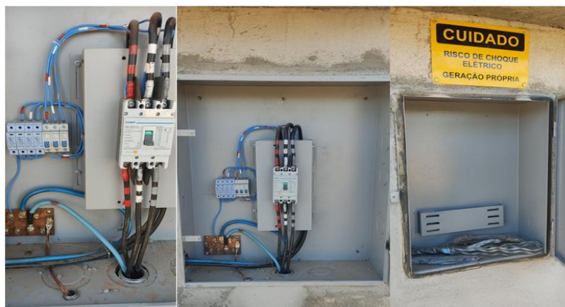
Figura 101. Subestação de 75kVA – detalhe do Quadro de Distribuição.
