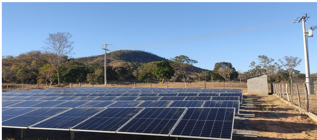
Figura 92. Usina Fotovoltaica concluída – detalhe do sombreamento 1.
