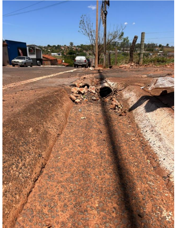
Figura 4.24 - Canaletas exercendo função de drenagem superficial em substituição a bueiros convencionais.
