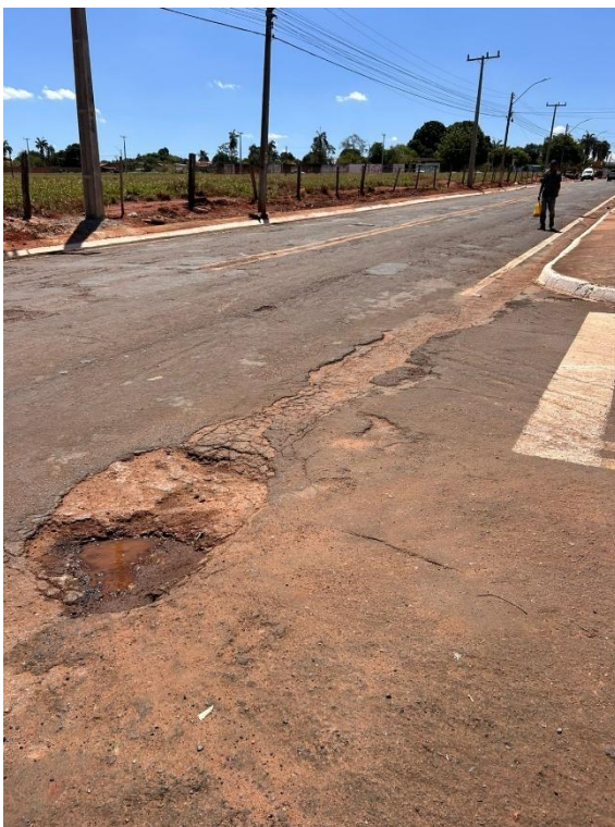
Figura 4.18 - Presença de buraco na pista.
