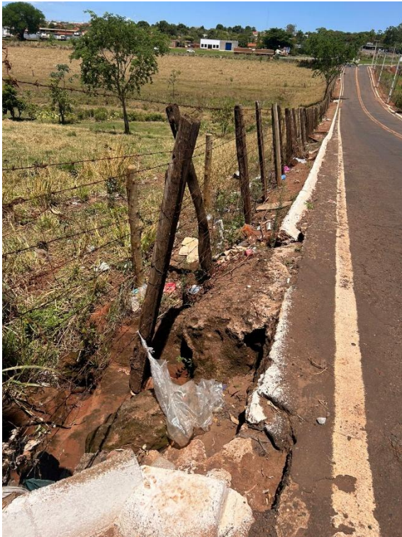
Figura 4.27 - Danos e deterioração no meio-fio em trecho urbano.
