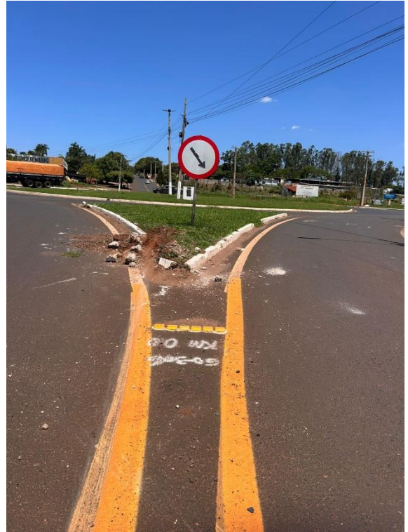
Figura 4.26 - Trecho com meio-fio danificado e falta de manutenção.
