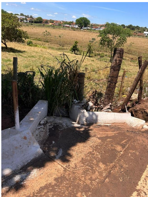
Figura 4.20 - Insuficiência do sistema de drenagem superficial em trecho urbano.
