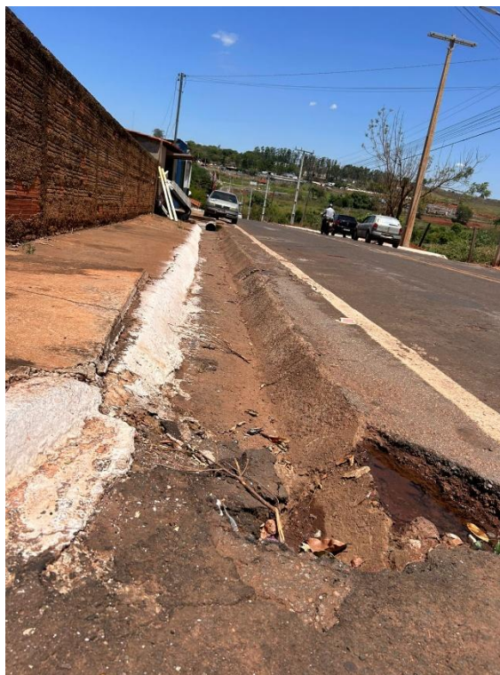
Figura 4.25 - Adaptação inadequada de canaletas para o escoamento de águas pluviais em via urbana.
