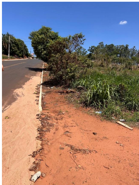
Figura 4.4 - Vegetação avançando sobre a calçada e comprometendo a circulação de pedestres.
