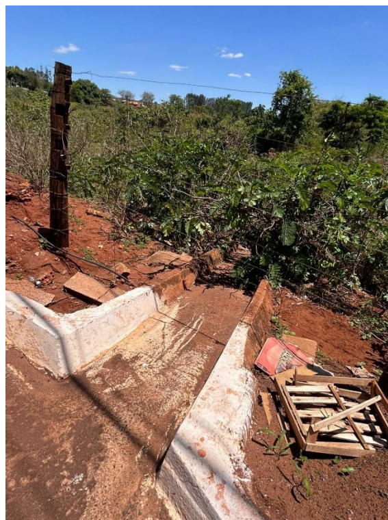
Figura 4.19 - Ausência de dispositivos adequados para o escoamento das águas pluviais.
