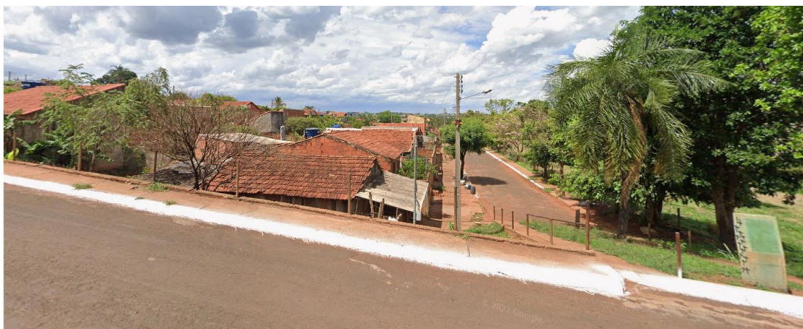
Figura 4.14 - Residências localizadas abaixo de via com desnível acentuado e ausência de barreira de contenção.
