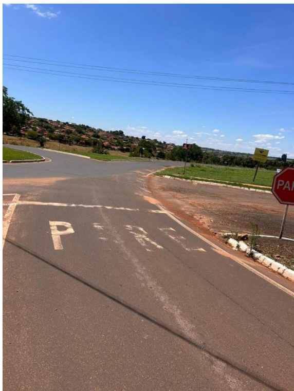
Figura 4.11 - Desgaste da sinalização horizontal
