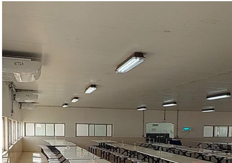
Figura 3 – Aparelhos de ar condicionado do tipo split utilizados para melhoria das condições de conforto térmico em refeitório de unidade frigorífica
