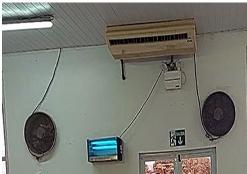
Figura 4 – Aparelho de ar condicionado do tipo split atuando de forma simultânea com exaustores em refeitório de unidade frigorífica
