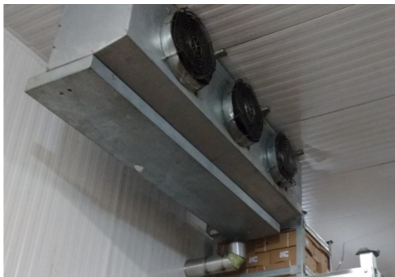
Figura 2 – Evaporador com seus ventiladores axiais
