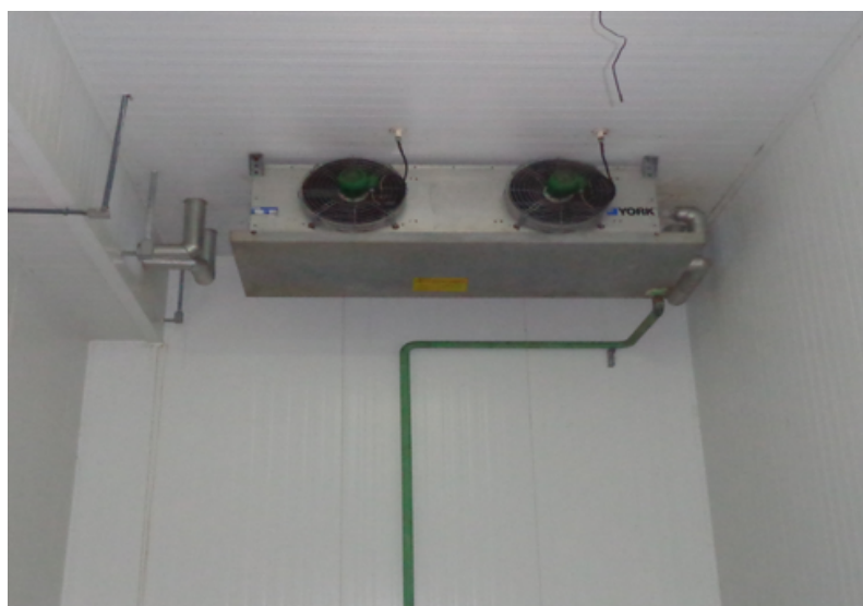
Figura 1 – Evaporador do sistema de refrigeração a base de amônia disposto dentro de ambiente produtivo
