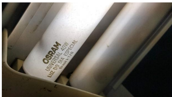
Figura 10: Lâmpada tubular fluorescente na edificação do Programa Saúde da Família.
