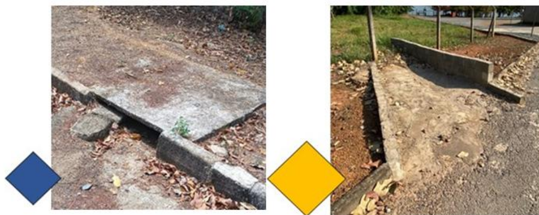
Figura 4. 22 – Dispositivos de drenagem levantados durante vistoria
