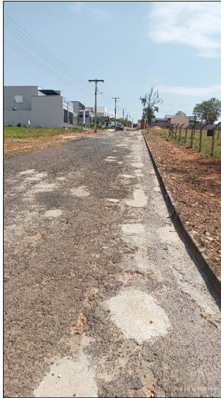
Figura 4. 4 – Registro de defeitos
