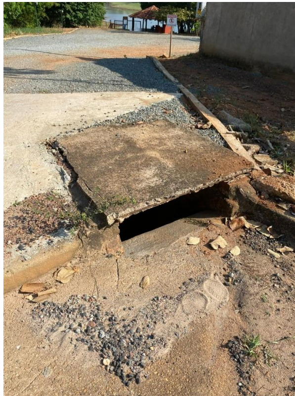
Figura 4. 7 – Dispositivo de drenagem
