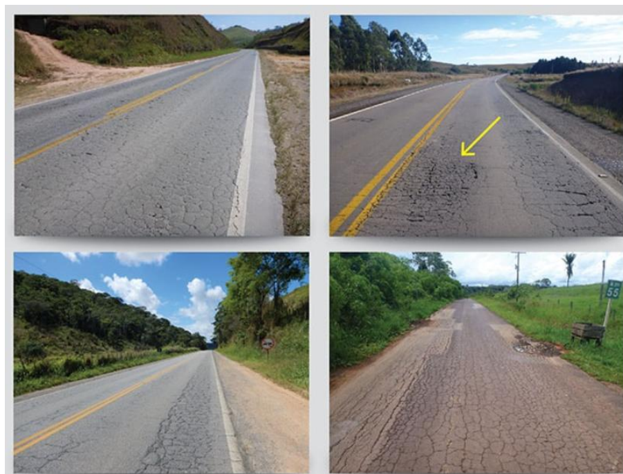
Figura 2. 13 – Trinca Couro de Jacaré
