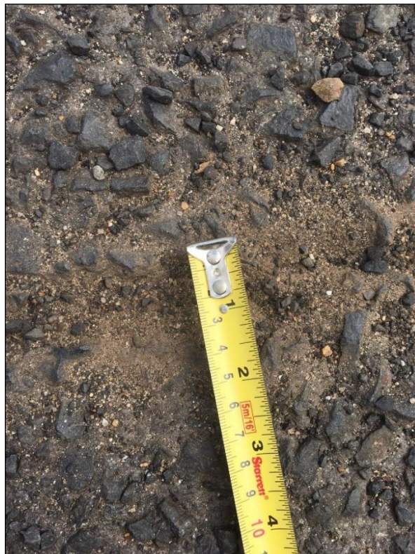
Figura 4. 5 – Medição dos defeitos
