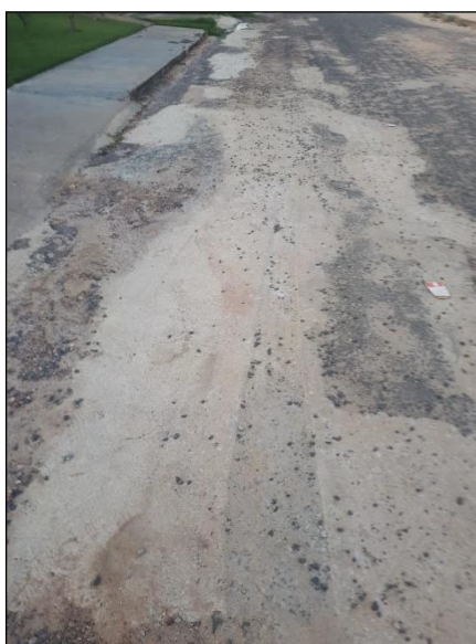
Figura 4. 10 – Remendo da Via
