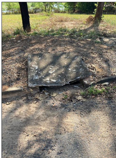
Figura 4. 20 – Dispositivo de drenagem
