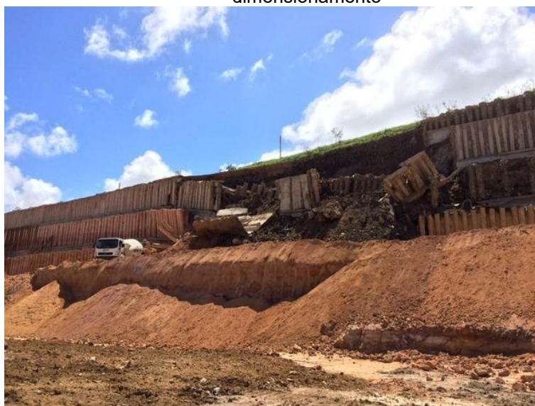
Figura 2.18 - Acidente em obra. Rompimento do talude por ausência ou mal dimensionamento
