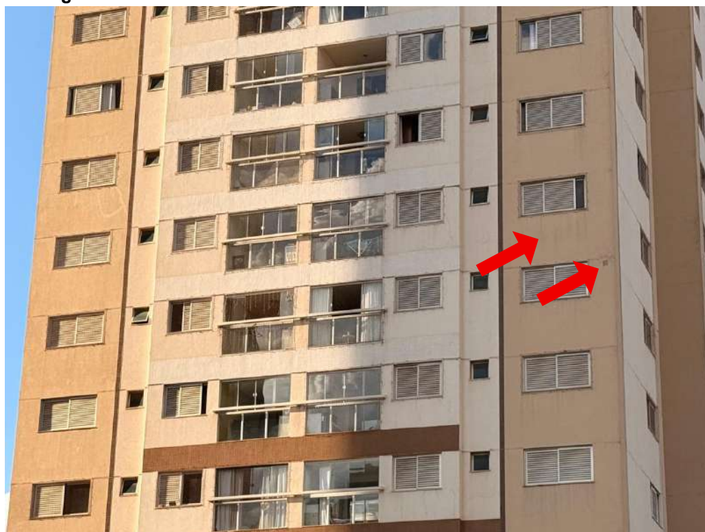
Figura D.3 – Faixa intermediária da fachada sul do edifício Pedra do Mar
