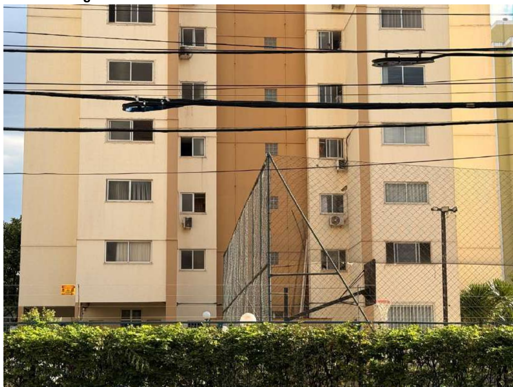
Figura K.2 – Faixa inferior da fachada norte do edifício Pérola
