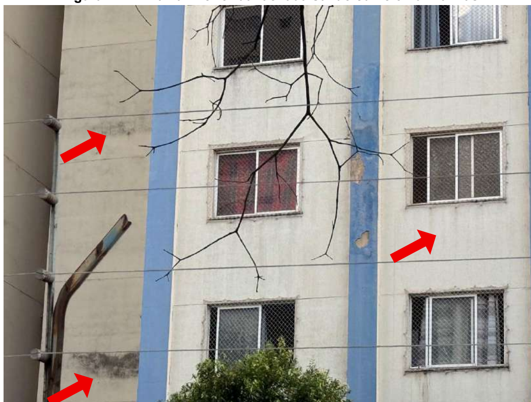
Figura L.12 – Faixa inferior da fachada sul do edifício Turmalinas
