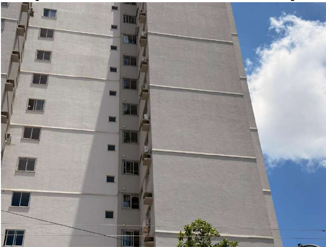
Figura H.12 – Faixa intermediária da fachada sul do edifício Rio Negro
