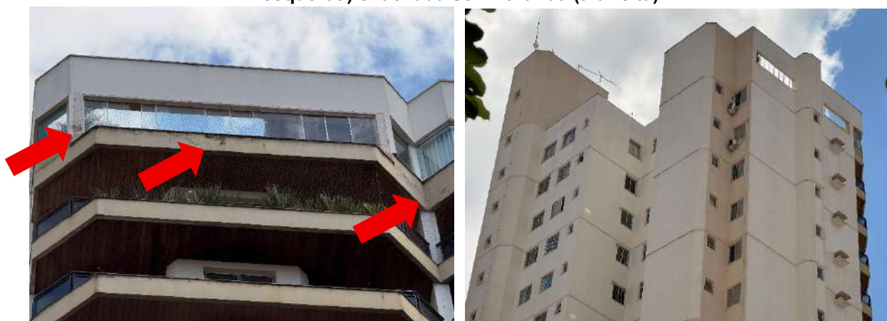
Figura 12 – Comparação de manifestações patológicas entre fachada com varanda (à esquerda) e fachada sem varanda (à direita)
