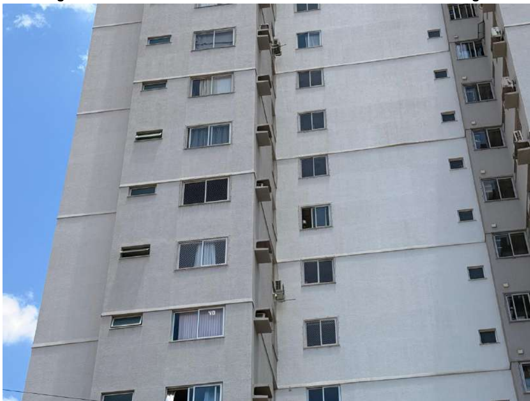
Figura H.11 – Faixa intermediária da fachada sul do edifício Rio Negro
