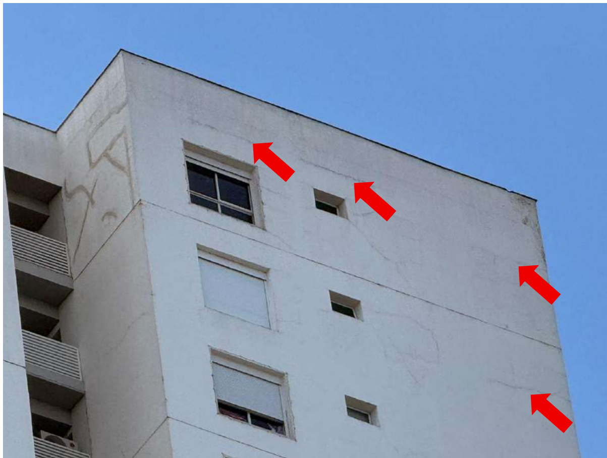
Figura 2 – Exemplo de fissura em revestimento
