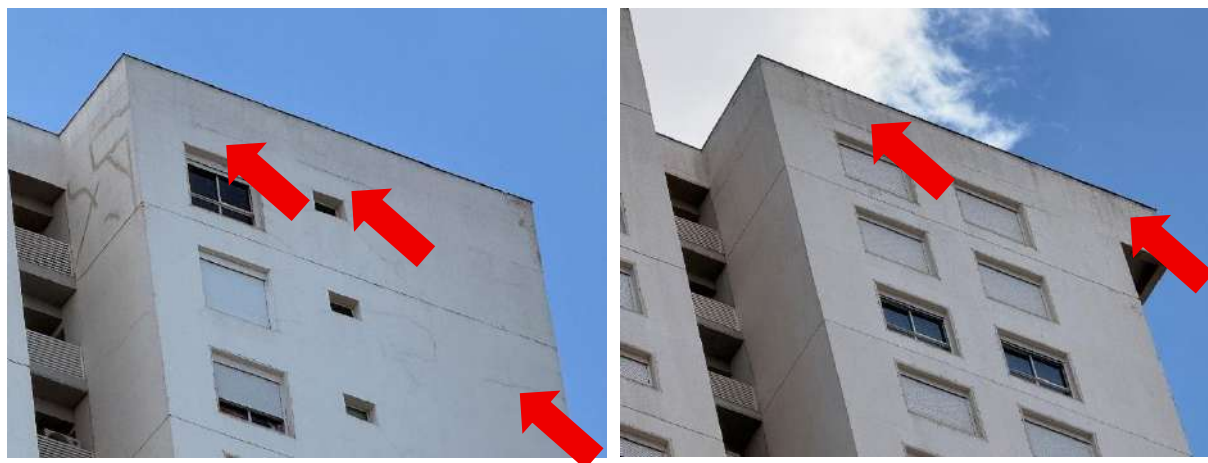
Figura 9 - Comparação entre as fachadas norte com mais fissurações (à esquerda) e a fachada sul com mais manchamentos (à direita) do edifício Gran Bueno
