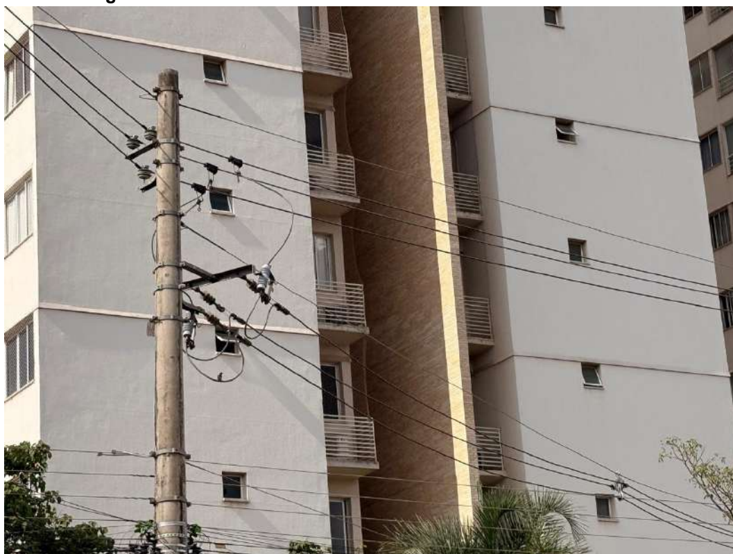
Figura J.9 – Faixa inferior da fachada sul do edifício Terra Mundi
