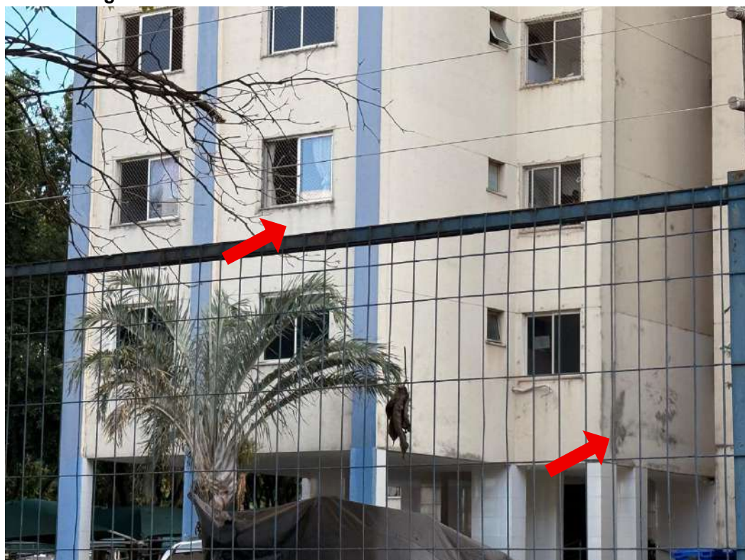
Figura L.11 – Faixa inferior da fachada sul do edifício Turmalinas
