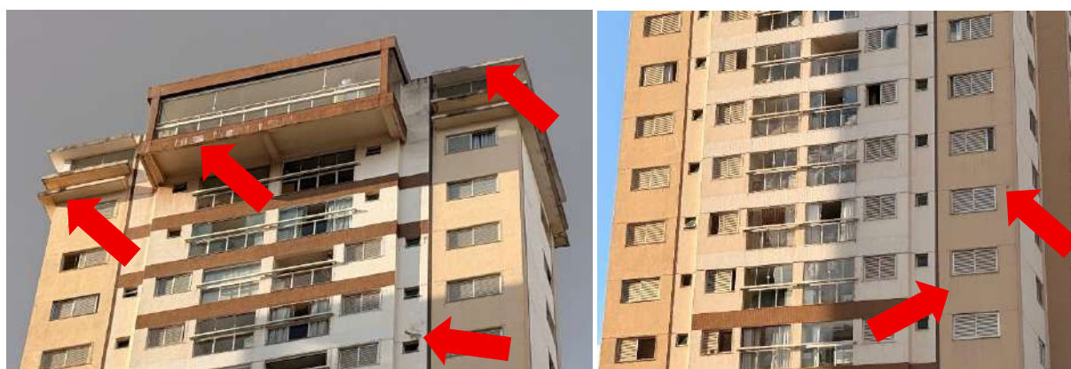
Figura 10 - Comparação entre a faixa superior (à esquerda) e a faixa intermediária (à direita) do edifício Pedra do Mar
