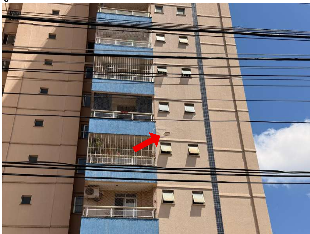
Figura F.19 – Celular: Faixa intermediária da fachada sul do edifício Dom Fernando
