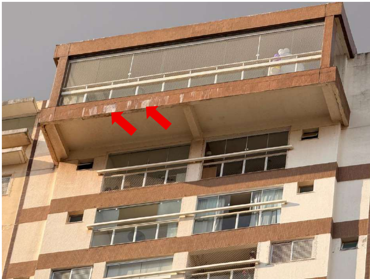
Figura 4 – Exemplo de eflorescência em revestimento
