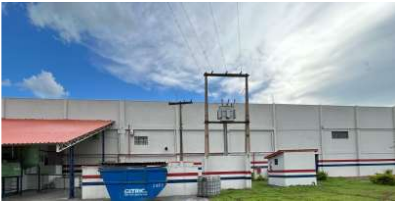
Figura 28 - Vista frontal do galpão industrial com rede de média tensão.
