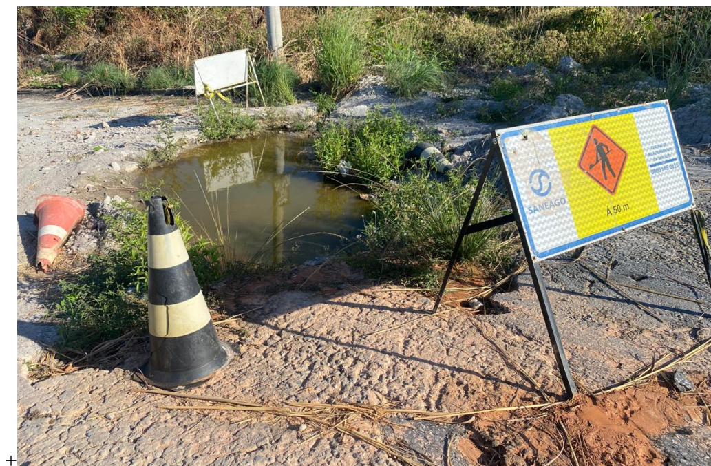
Figura 33: Retrato da obra mal-acabada.
