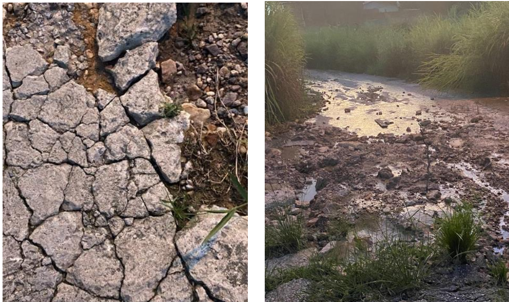
Figuras 29 e 30: Nascente brotando em meio ao asfalto.
