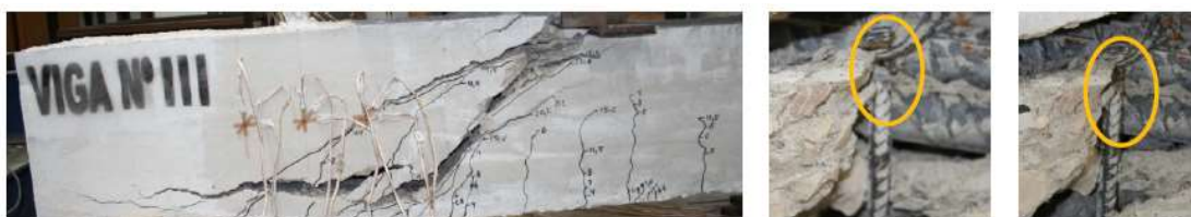
Figura 2.34 - Viga III - Escorregamento dos estribos
