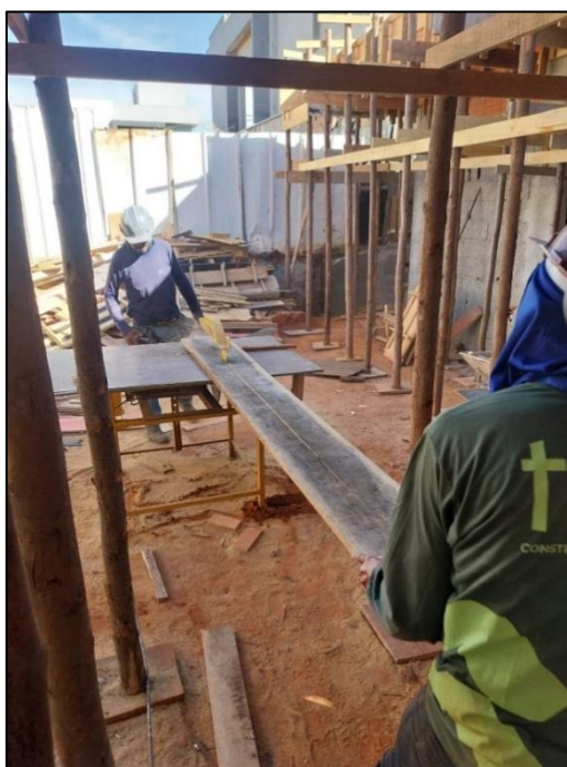
Figura 20 - Serra circular obra 1
