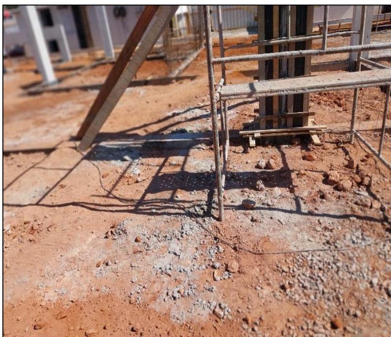
Figura 11 - Condutores elétricos obra 2
