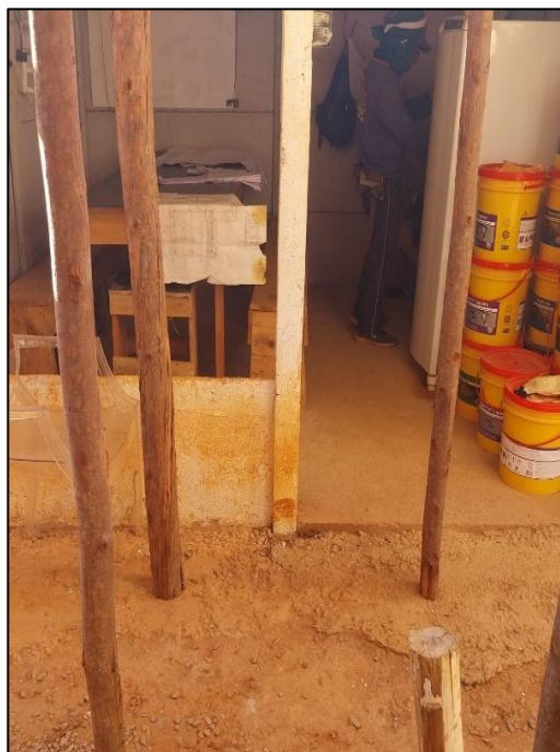
Figura 25 - Trabalhador sem o uso de calçado de segurança adequado
