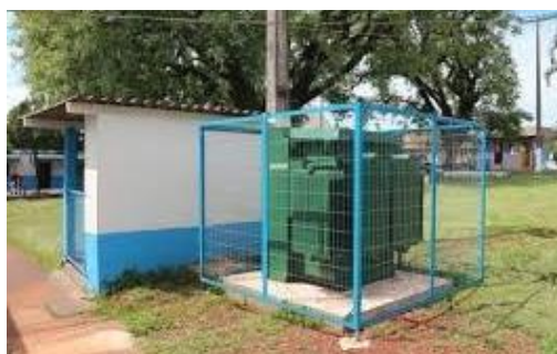
Figura 5: Subestação ao Tempo com Transformador em Pedestal.
