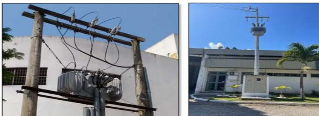
Figura 4: Subestação ao Tempo em Poste.
