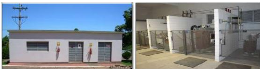
Figura 6: Subestação Abrigada – Cabine em Alvenaria.
