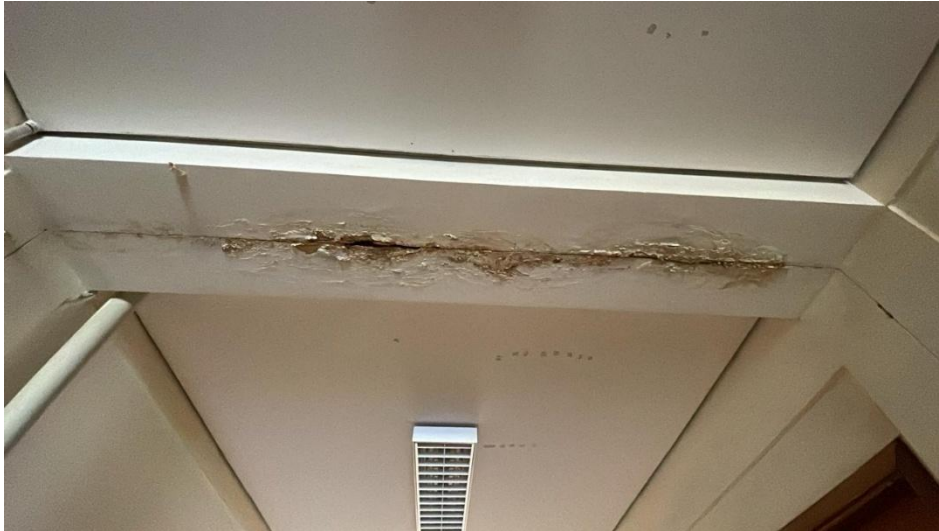
Figura 8 – Junta dilatação sem tratamento no Bloco 400
