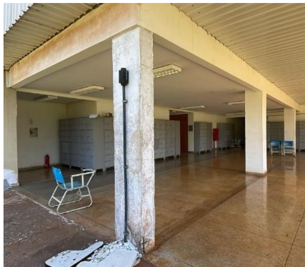
Figura 9– Exemplos de patologias encontradas na edificação
