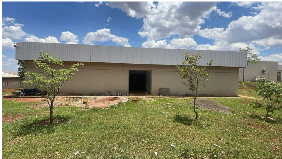
Figura 15 - Esquadria ausente comprometendo a segurança do usuário no Bloco 500
