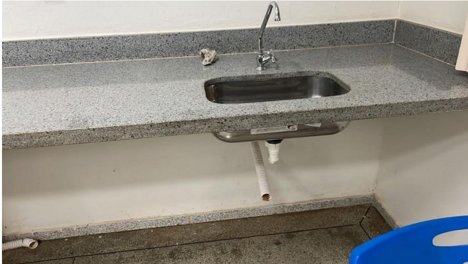
Figura 20 – Sifão danificado no Bloco 700
