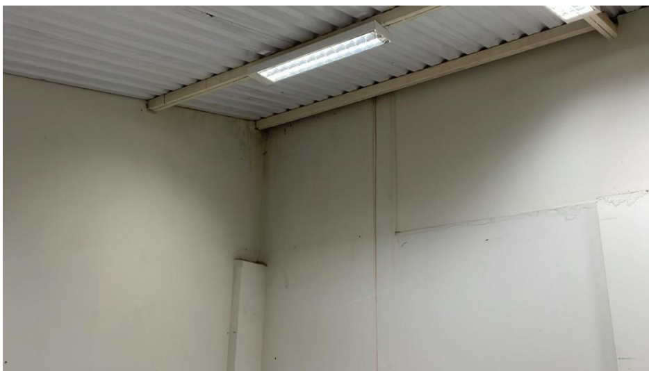
Figura 18 – Telhado com goteiras e falha na vedação no Bloco 700
