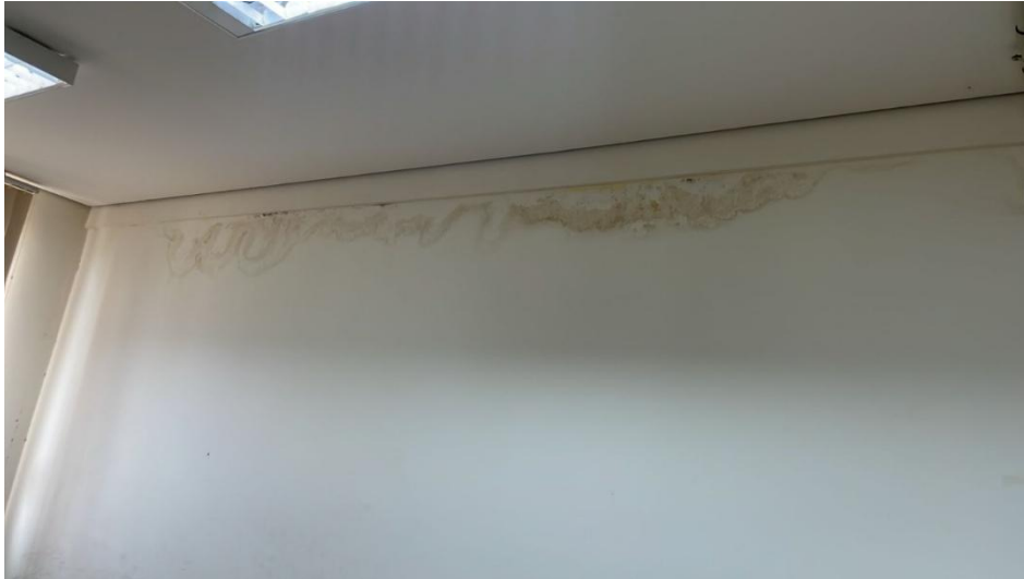
Figura 13 – Mancha de infiltração na cobertura do Bloco 500
