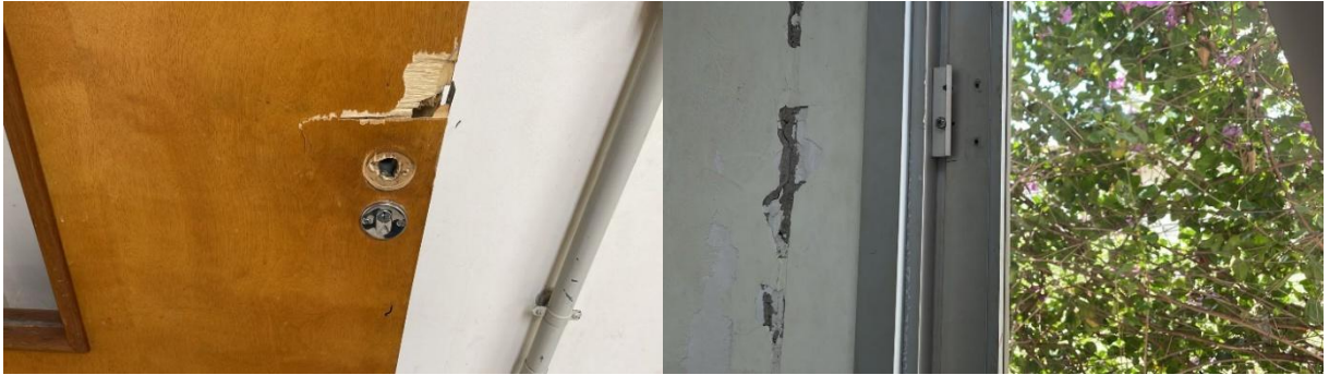
Figura 6 - Patologias encontradas em portas e janelas
