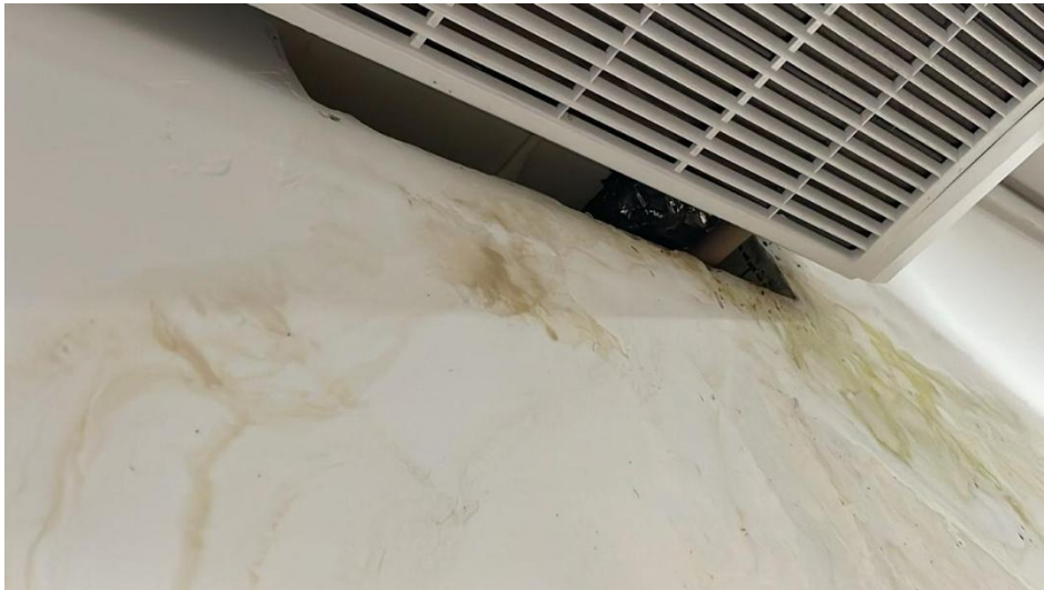
Figura 7 – Infiltração no Bloco 400
