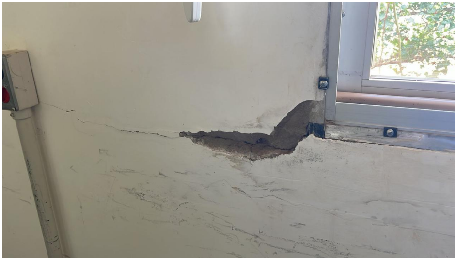
Figura 14 - Falha na estanqueidade do contramarco no Bloco 500 e o uso de cantoneira de nylon
