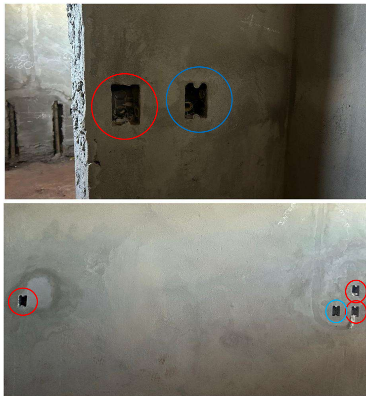
Figura 4. 15 – Caixas de passagem metálicas de pontos de automação e elétricos
