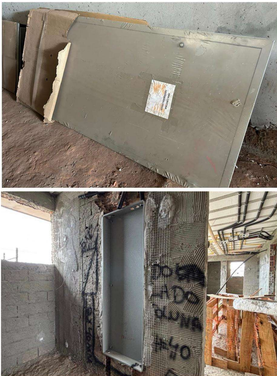
Figura 4. 18 Quadros de automação
