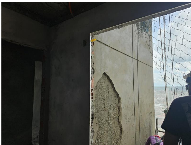
Figura 28 – Reboco deslocando, após um dia chuvoso
