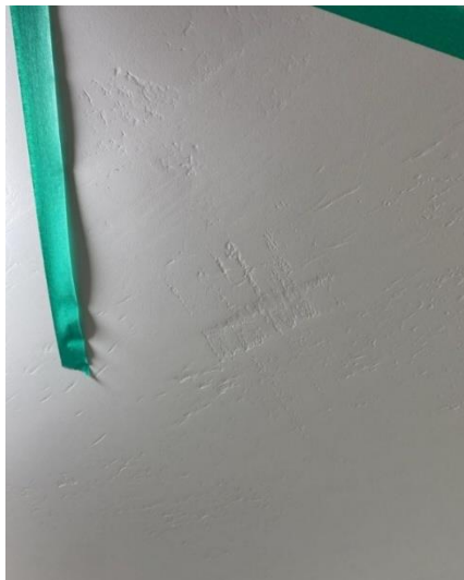
Figura 21 – Aspecto “Casca de laranja” apresentado pela obra
