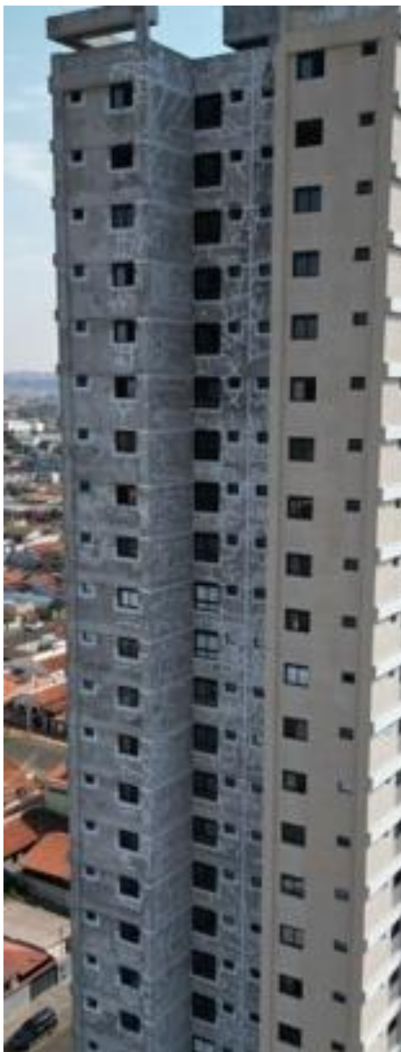
Figura 24 – Inconformidade aderência reboco (lado A)
