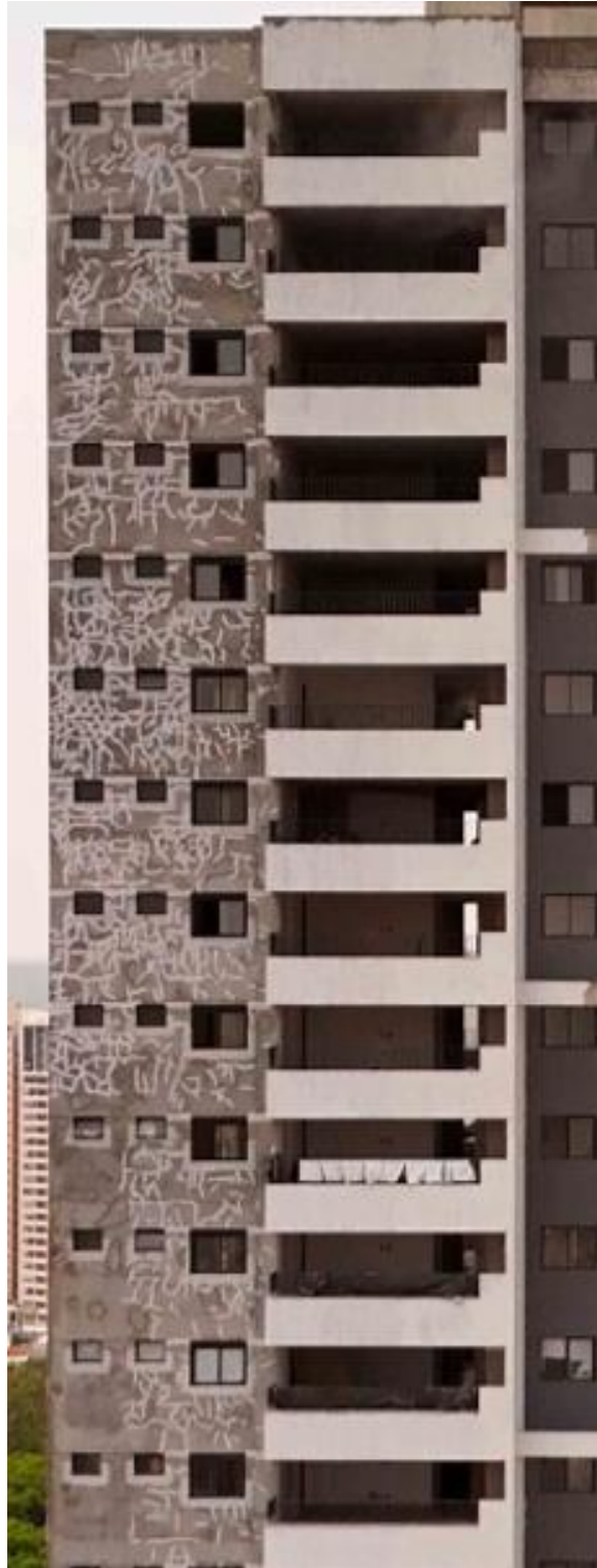
Figura 25 – Inconformidade aderência reboco (lado B)
