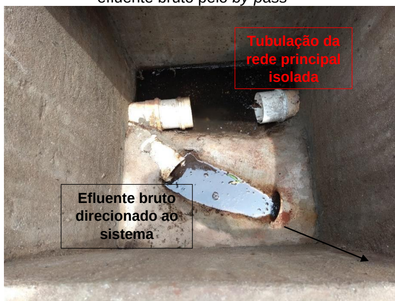
Figura 21 Caixa de passagem para o desvio de efluente bruto pelo by-pass
