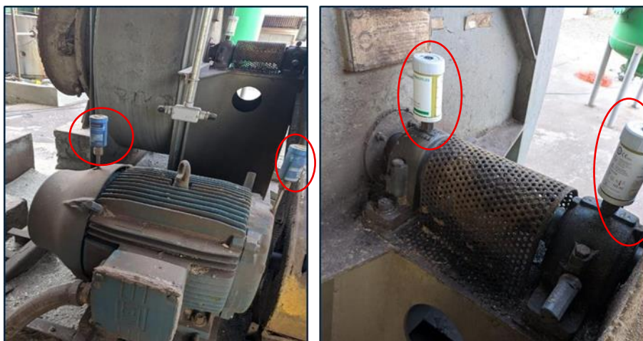
Figura 455 - Sistema de Lubrificação Instalado
