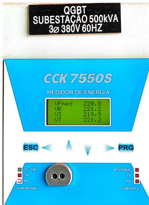
Figura 23 - Medidor da subestação do câmpus
