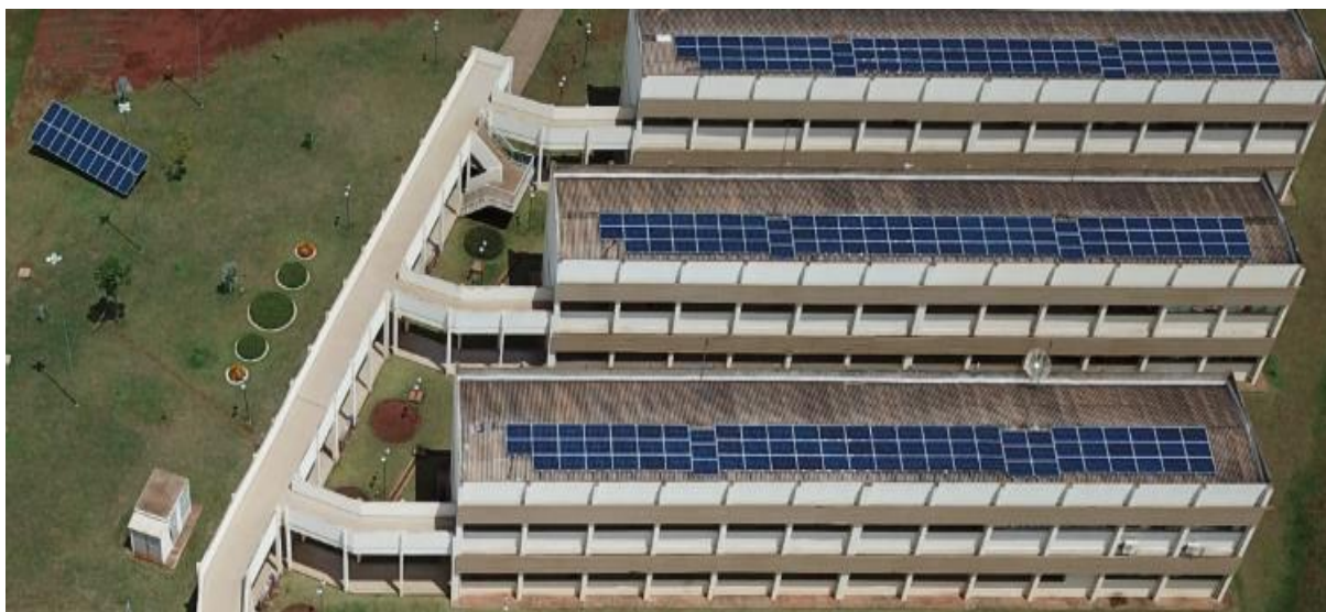
Figura 13 - Sistema fotovoltaico da Licitação 1 de 2017 do IFG – Itumbiara
