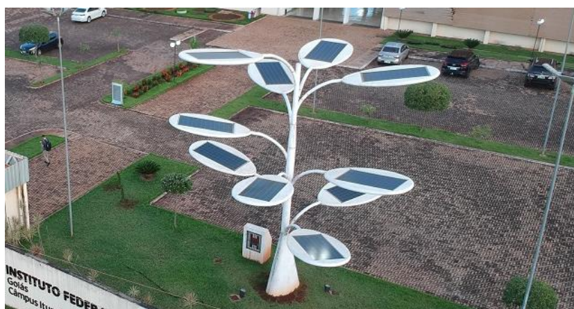
Figura 14 - Árvore solar do IFG – Itumbiara
