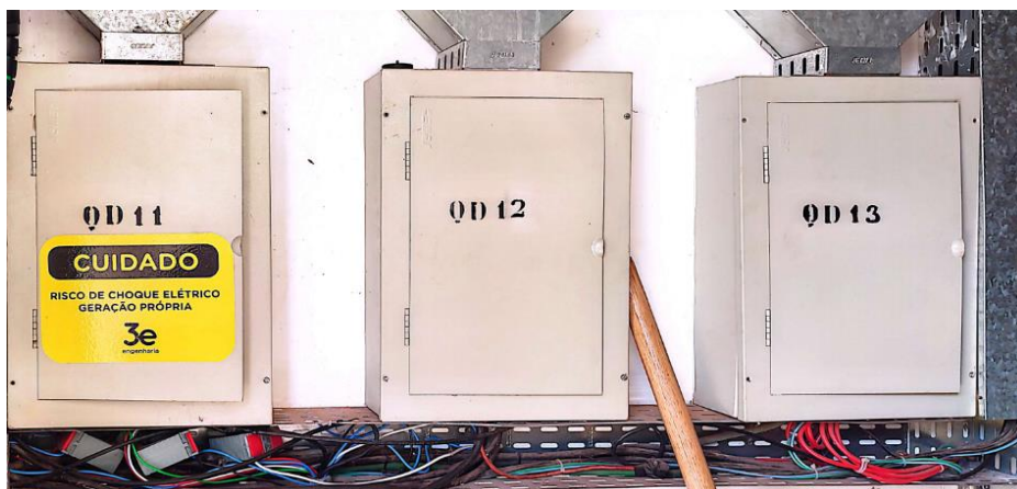
Figura 25 - Quadros de distribuição e logo abaixo os TCs utilizados nos blocos do câmpus
