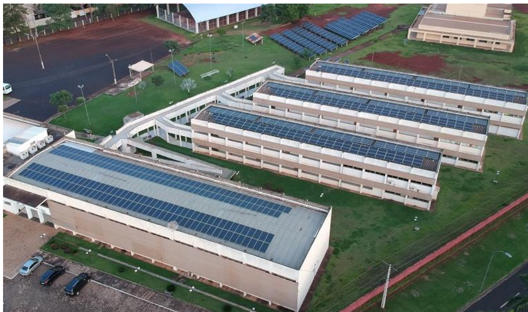
Figura 16 - Sistema fotovoltaico do câmpus após o projeto de P&D
