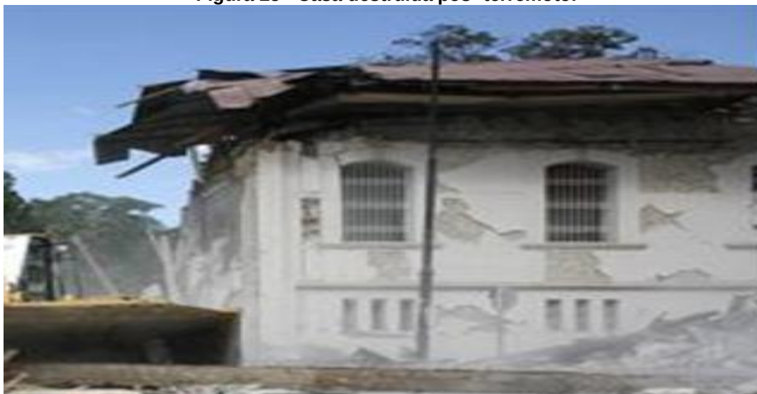
Figura 25 - Casa destruída pós- terremoto.
