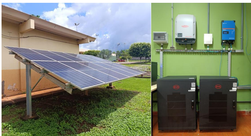
Figura 6 - Microrrede do Laboratório de Fontes Renováveis Fonte: Autoria própria
