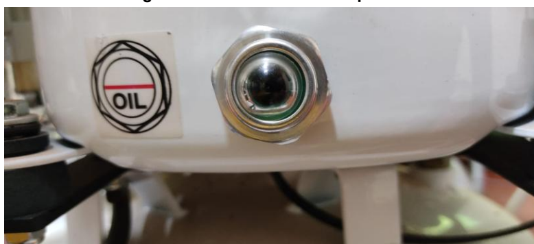
Figura 69: Nível do Óleo Compressor
