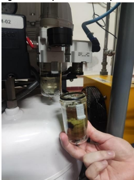
Figura 72: Recipiente Filtro Compressor
