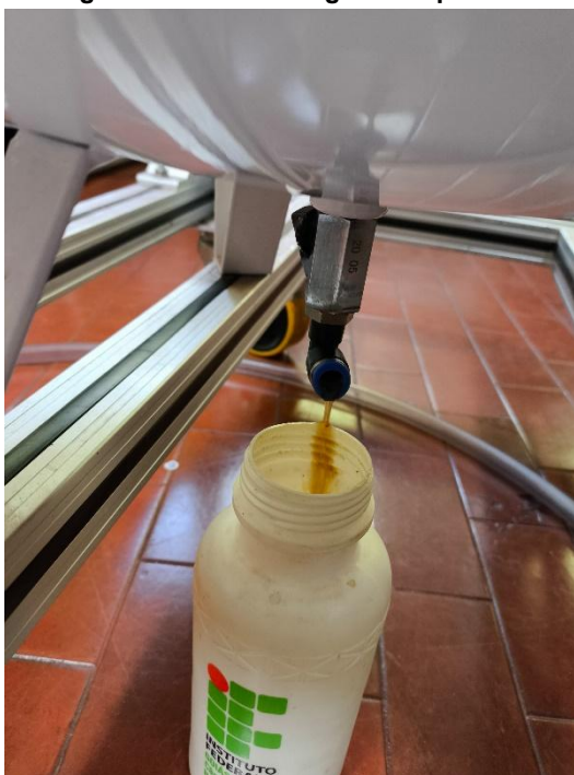
Figura 68: Dreno de água Compressor
