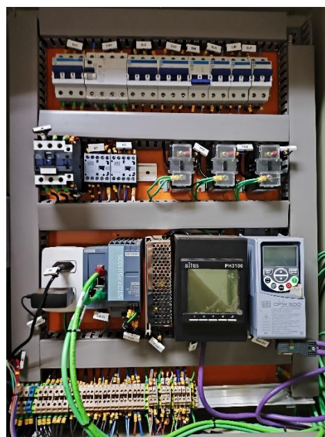
Figura 80: Conexões Pannel Elétrico
