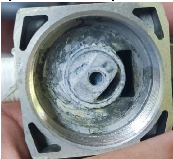
Figura 67: Detritos no Filtro Regulador da FV1
