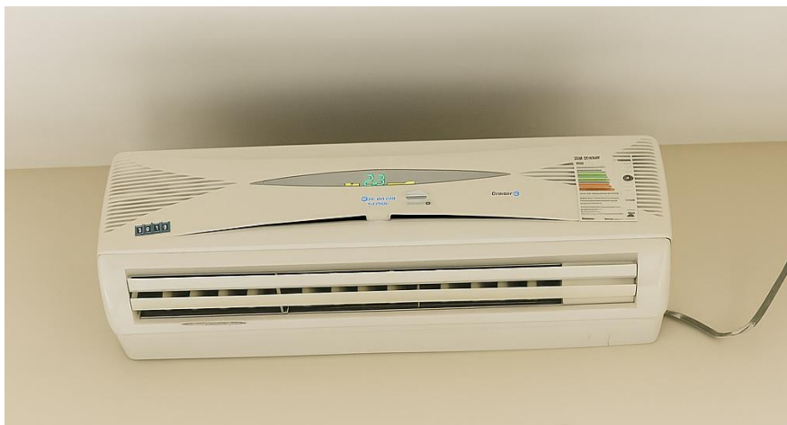
Figura 37- Ar condicionado utilizado nos testes
