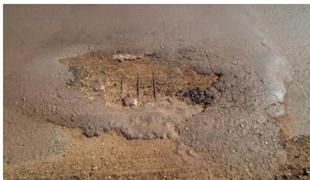
Figura 6.9 - Exposição de armaduras no pavimento de concreto da ponte.
