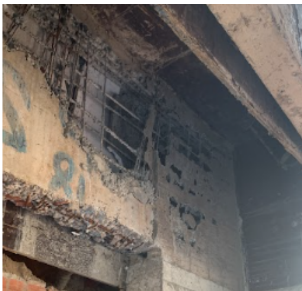
Figura 2.16- Viga e pilar de concreto com falha de concretagem, ausência de concreto para resistir os esforços de compressão conforme projeto.
