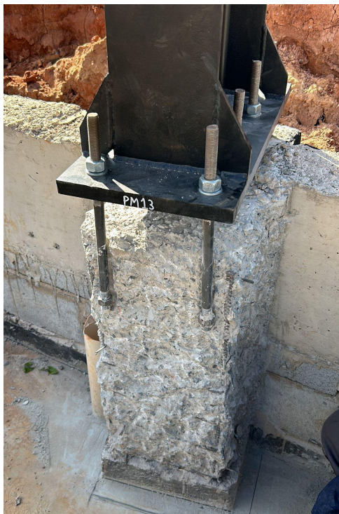
Figura 2.15- Pilar de concreto com área insuficiente para recebimento de pilar metálico, sem ter ancoragem dos chumbadores no concreto.
