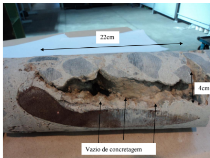
Figura 8.2 - Vazio de concretagem identificado com extensão de 22cm X 4cm, P6-L.
