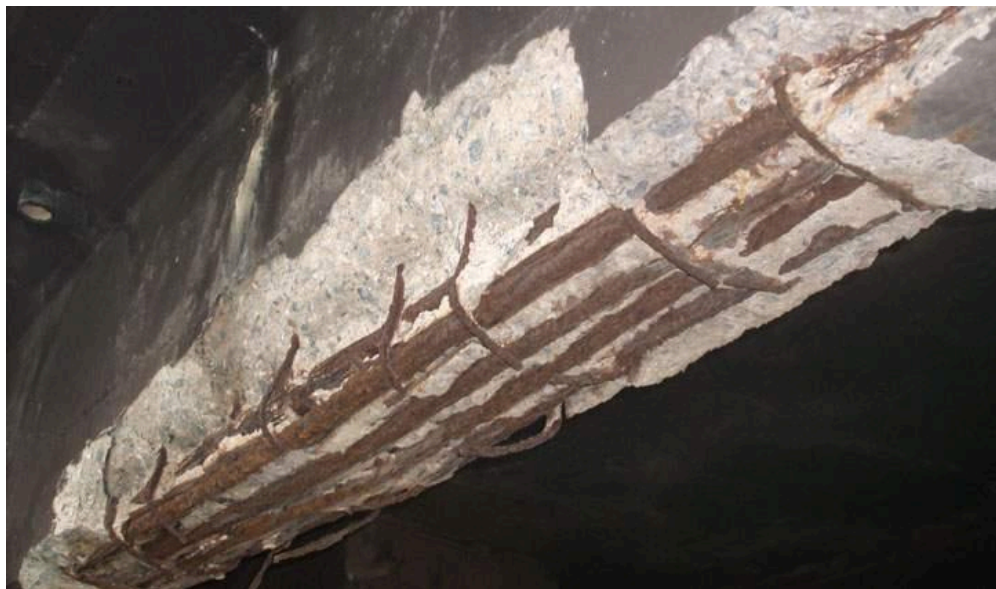
Figura 2.2 - Corrosão de armadura longitudinal por íons de cloreto.
