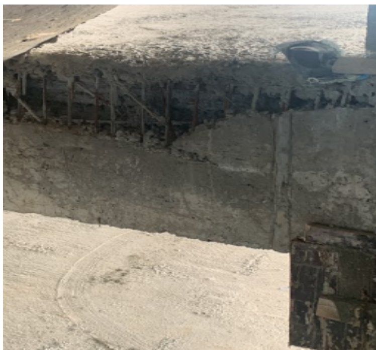
Figura 2.4 - Nicho de concretagem em viga com a presença de vazios na peça de concreto.
