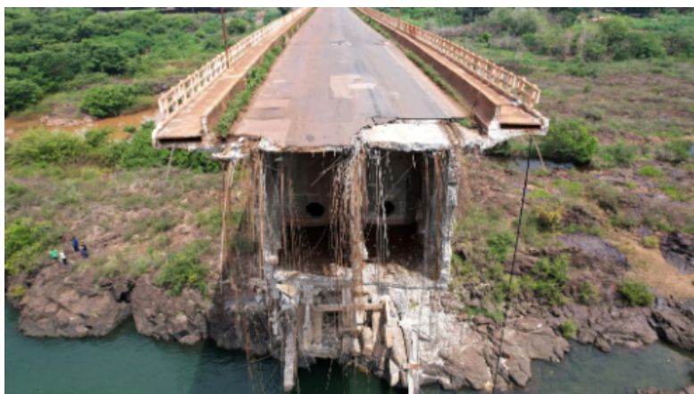
Figura 7.4 - Imagem da ponte após sua ruptura, é possível ver os cabos de protensão sem indícios de ruptura por tração, com indício de perda de aderência dos cabos ao concreto.
