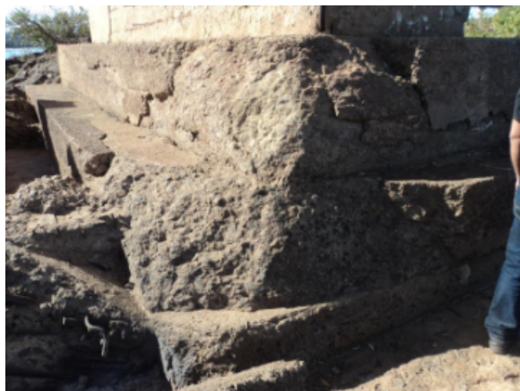
Figura 6.5 - Danos observados no bloco do P7, com significativa variação da geometria do bloco.
