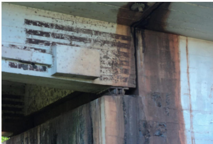
Figura 6.10 -Sinais de umidade e corrosão da armadura nos apoios, uma presença de uma mancha provinda da oxidação do aço.
