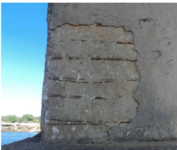
Figura 6.8 - Deslocamento da argamassa de cobrimento e exposição das armaduras longitudinais do pilar P7.
