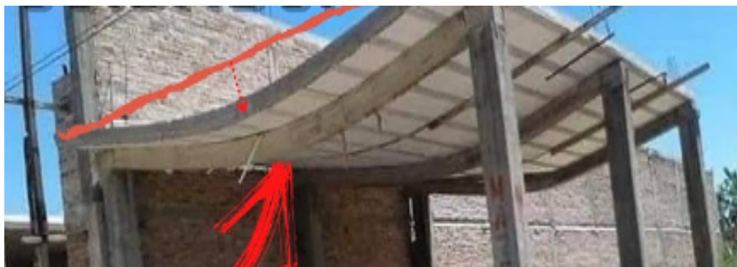
Figura 2.3 - Flechas acentuadas em vigas de concreto.
