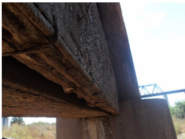
Figura 6.6 - Deslocamento do concreto e exposição da armadura com sinais de oxidação.
