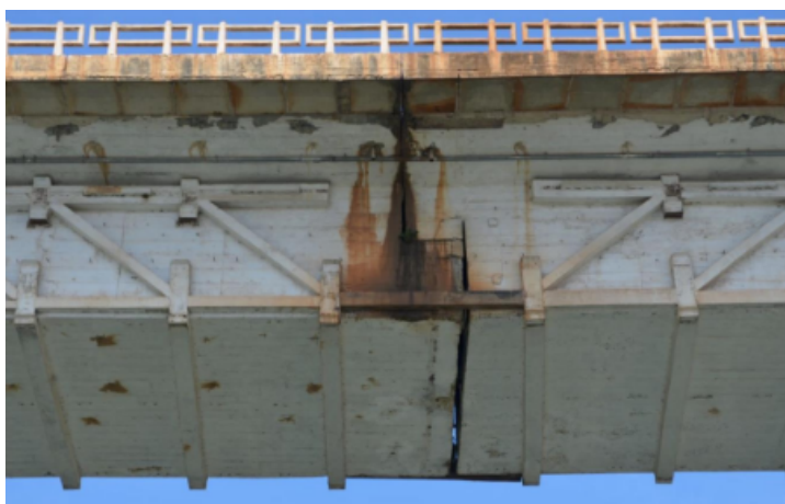
Figura 6.2 - Sinais de corrosão nos apoios centrais, do meio do balanço sucessivo ponto mais crítico da estrutura.
