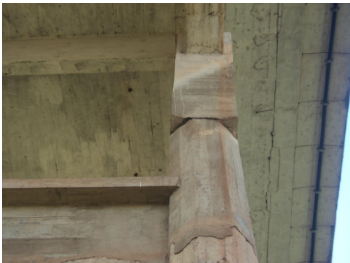
Figura 6.7 - Deslocamento da camada de cobertura de argamassa identificada no pilar do apoio P13 e inclinação observada a olho nú entre pilar octogonal e capitel.
