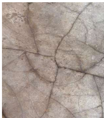
Figura 17: Fissura no piso
