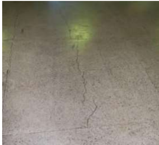
Figura 5: Fissura no piso
