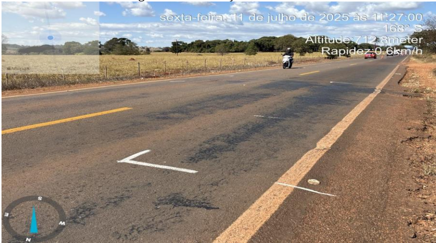
Figura 4.1: Ondulação na Rodovia
