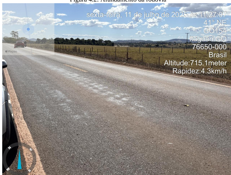
Figura 4.2: Afundamento da rodovia
