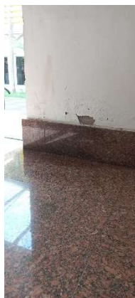
Fotografia 42 – Bolhas na tinta da parede, com destacamento situadas ao lado do acesso direto ao Foyer Multiuso 2 (Cor no gráfico: rosa).
