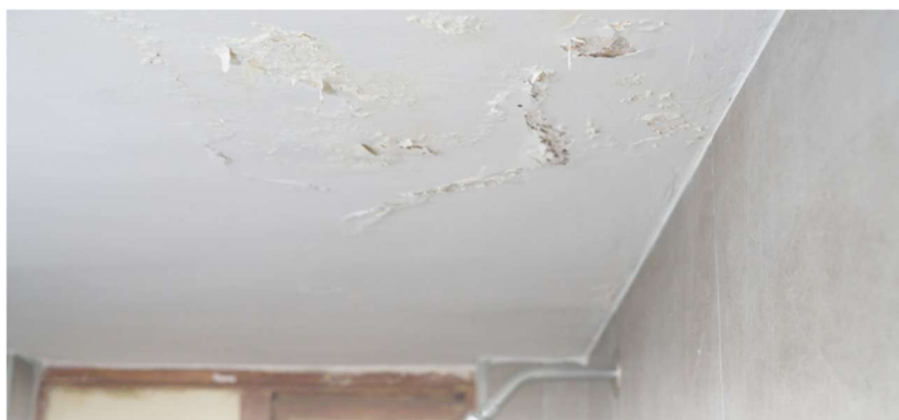
Figura 39 – Deterioração do forro de gesso devido a umidade, causando destacamento da pintura.
