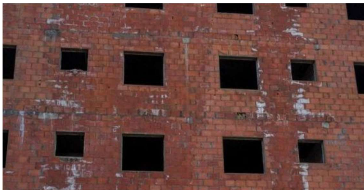
Figura 21 – Manchas de eflorescência devido a presença de umidade.
