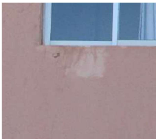
Figura 44 – Eflorescência sobre superfície pintada da fachada.
