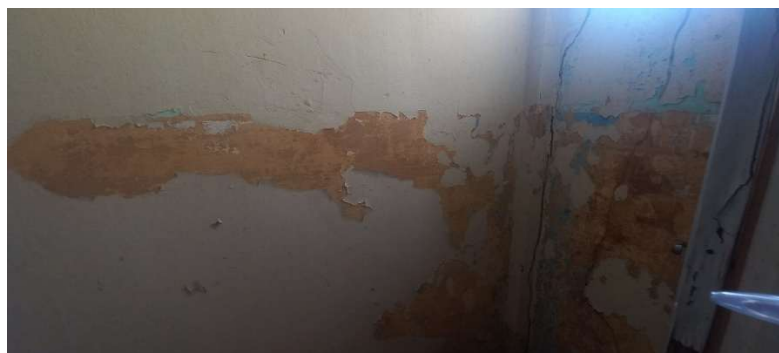
Fotografia 68 – Destacamento/Descascamento da pintura do depósito lateral (Cor no gráfico: rosa).
