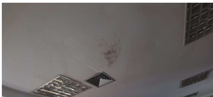
Fotografia 10 – Presença de manchas amarelas e bolor no forro devido presença de umidade (Cor no gráfico: azul).
