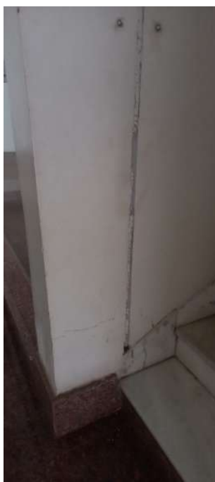
Fotografia 35 – Ausência de tratamento da junta de dilatação, causando fissuras próximas, tanto paralelas à junta quanto perpendicularmente, ao final - próxima a escada de acesso a casa de força, no sentido perpendicular a outra junta destacada acima. (Cor no gráfico: preto).
