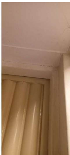
Fotografia 61 – Fissura no encontro do forro e a parede (Cor no gráfico: alaranjado).
