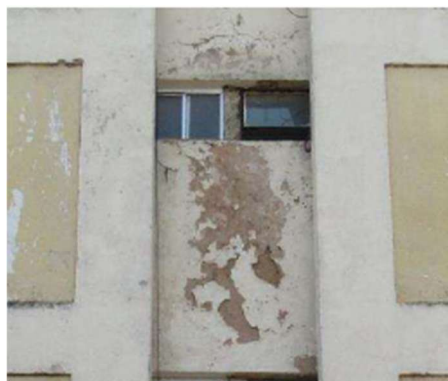
Figura 41 – Pulverulência no revestimento argamassado da fachada pela infiltração de água das chuvas pelas fissuras.
