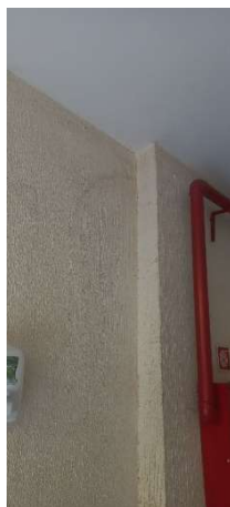
Fotografia 64 – Fissura irregular na parede do pátio das salas de dança e música (Cor no gráfico: verde claro).
