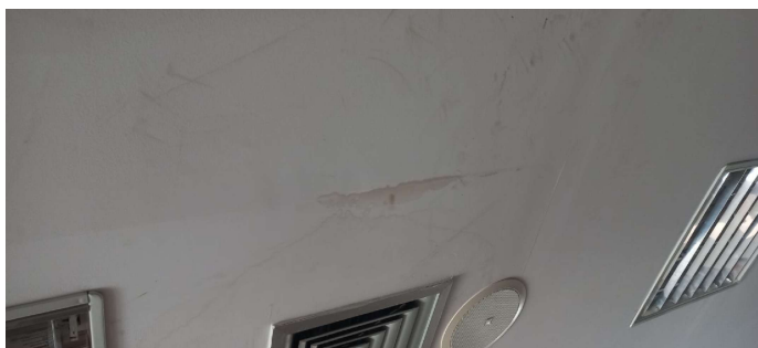
Fotografia 11 – Forro manchado com aspectos amarelo devido a presença de umidade (Cor no gráfico: azul).
