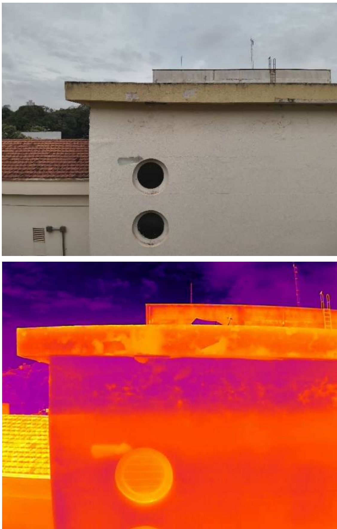
Figura 70 – A: Trecho da platibanda da Fachada Norte. B: Representação termográfica da Figura 70 A.
