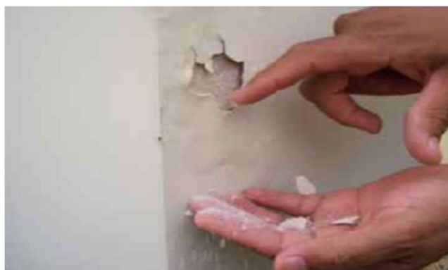
Figura 32 – Liberação de pó devido descascamento por calcinação.
