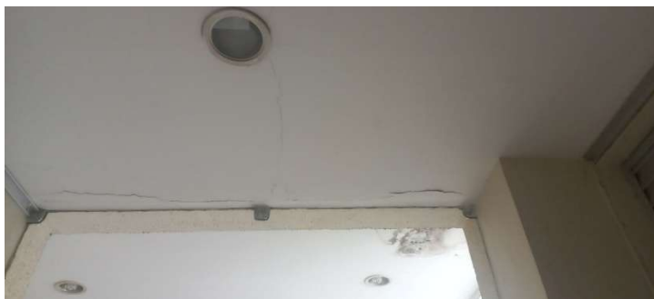
Fotografia 48 – Fissuras no forro próximo a porta de acesso ao vestíbulo (Cor no gráfico: verde claro).
