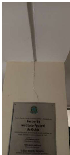
Fotografia 41 – Fissuras com cerca de 1 mm no pilar que passa pela junta de dilatação sem tratamento (Cor no gráfico: preto).
