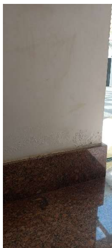
Fotografia 45 – Bolhas na tinta com presença de fissuras, região ao lado do acesso direto ao Foyer Multiuso 2 (Cor no gráfico: rosa).
