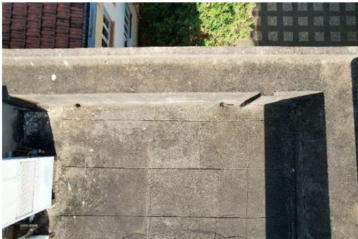
Figura 61 – A: Cobertura do Teatro IFG – Campus Goiânia e regiões no vértice da Fachada Norte com Oeste às 08:00. B: Mesma figura com as fissuras da superfície manualmente destacadas.
