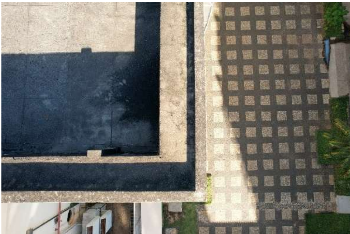
Figura 60 – A: Cobertura do Teatro IFG – Campus Goiânia e regiões no vértice da Fachada Norte com a Leste, às 08:00. B: Mesma figura com as fissuras da superfície manualmente destacadas.
