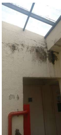
Fotografia 72 – Presença de bolor e trincas na parede (Cor no gráfico: azul).
