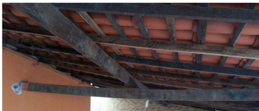
Figura 48 – Estrutura de madeira com flecha.
