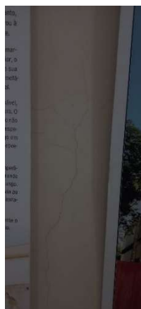
Fotografia 14 – Fissuras mapeadas com espessura de 0,35 mm mapeadas na superfície da parede com acabamento em tinta (Cor no gráfico: alaranjado claro).
