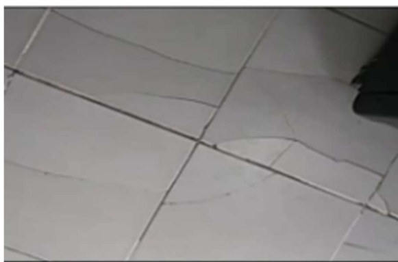
Figura 33 – Trincas e descolamento das placas cerâmicas.
