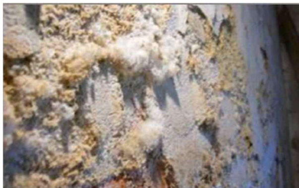
Figura 31 – Eflorescência sobre superfície pintada.
