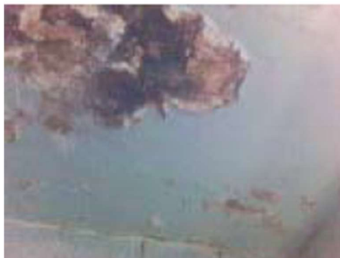
Figura 40 – Deterioração do forro de gesso devido a presença de umidade.
