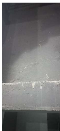
Fotografia 57 – Viga da lateral do palco do teatro com lascado em sua parte superior (Cor no gráfico: branco).
