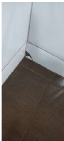
Fotografia 22 – Placa cerâmica quebrada e destacada da parede no banheiro feminino (Cor no gráfico: branco).
