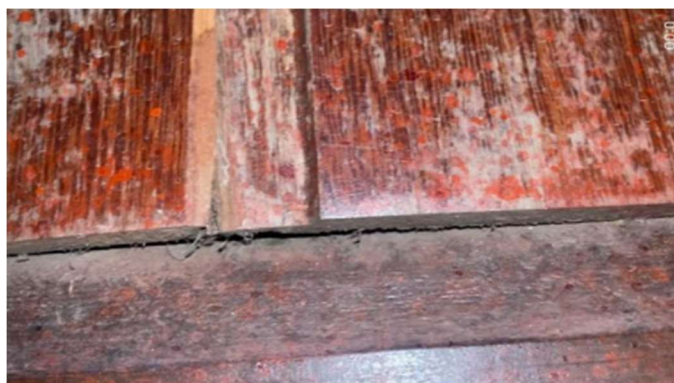
Figura 38 – Deterioração da superfície da peça do piso de madeira.
