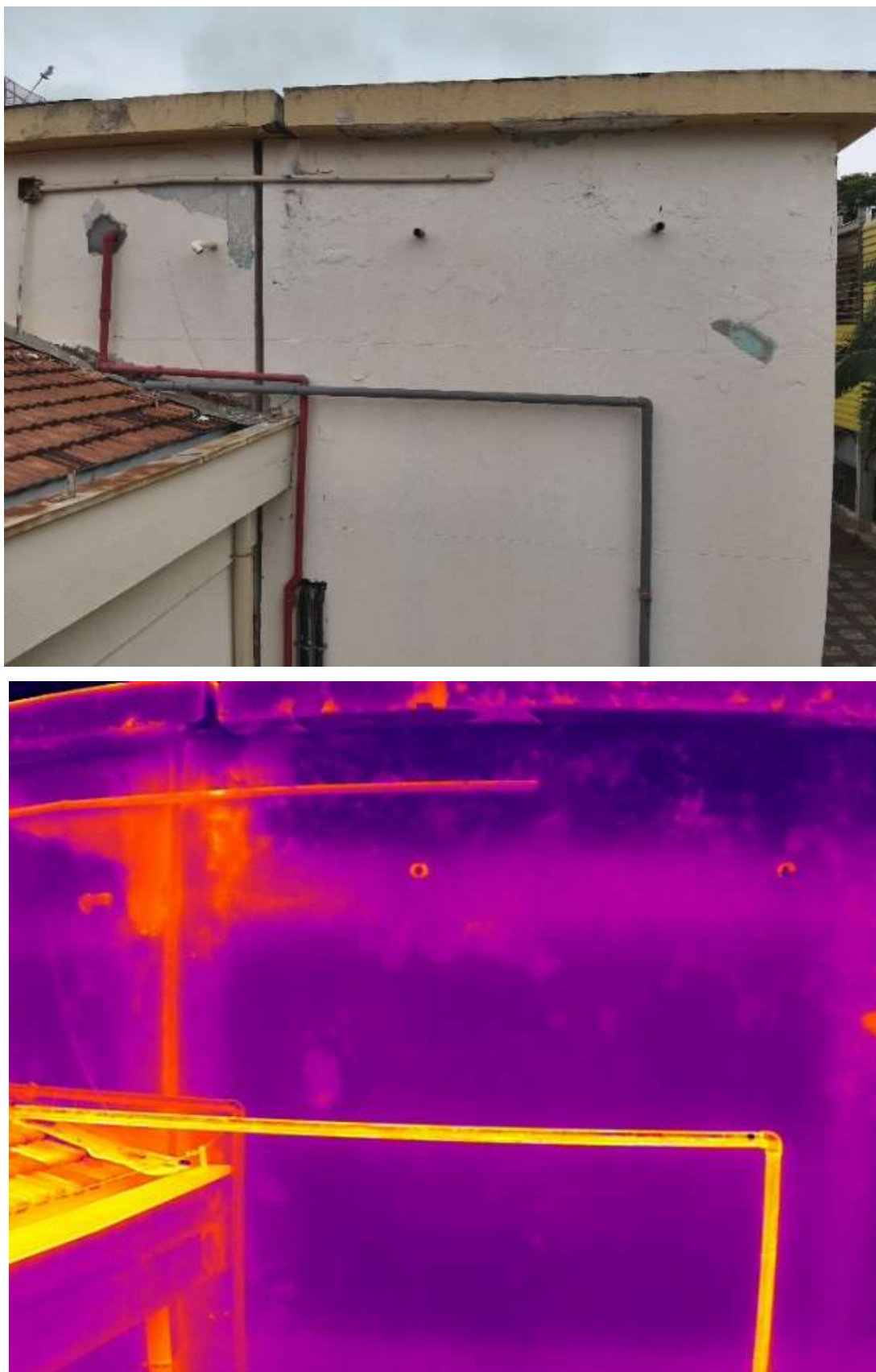
Figura 75 – A: Visão da Fachada Norte por cima da entrada do Teatro pelo Foyer Multiuso 2. B: Representação termográfica da Figura 75.
