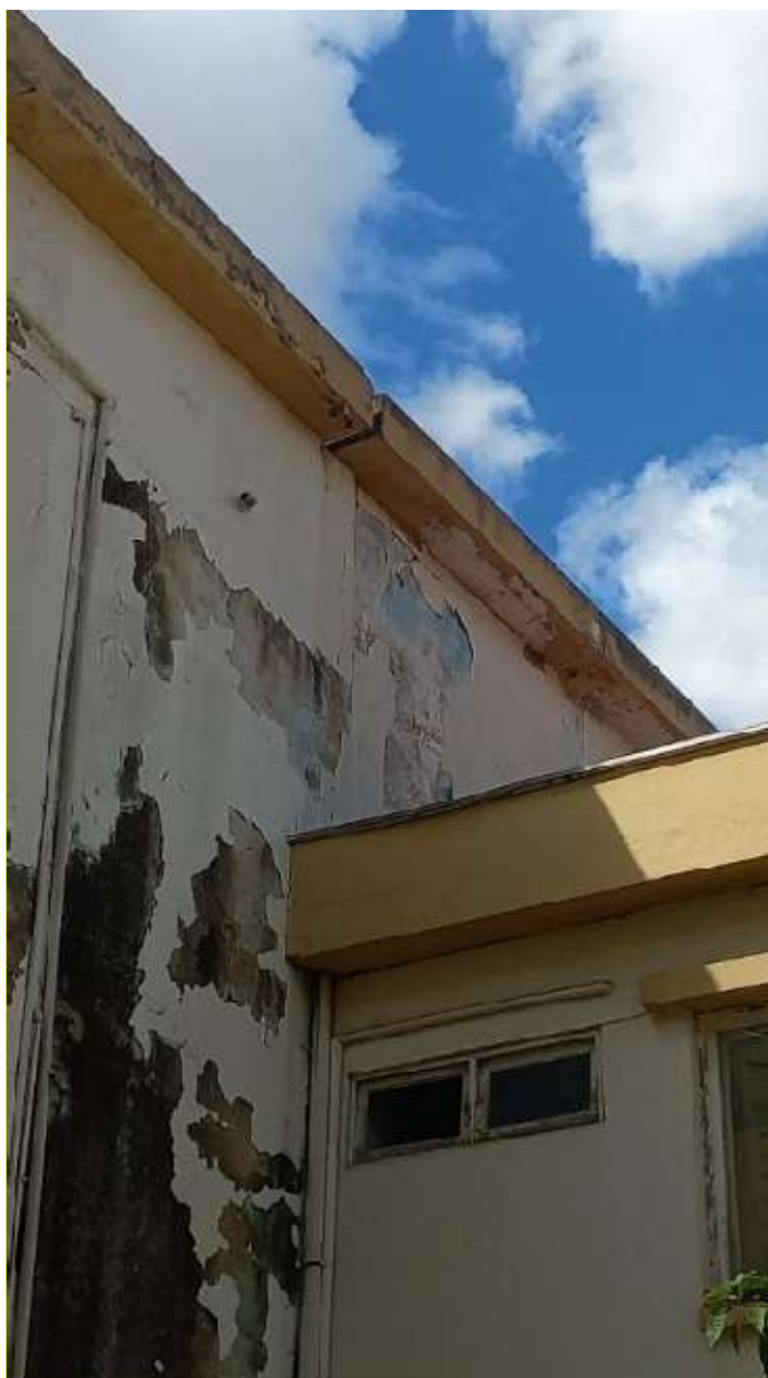
Figura 76 – Degradação da Fachada Oeste.
