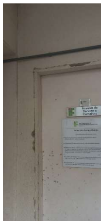
Fotografia 63 – Fissura na parede totalmente em volta da porta de madeira (Cor no gráfico: alaranjado).
