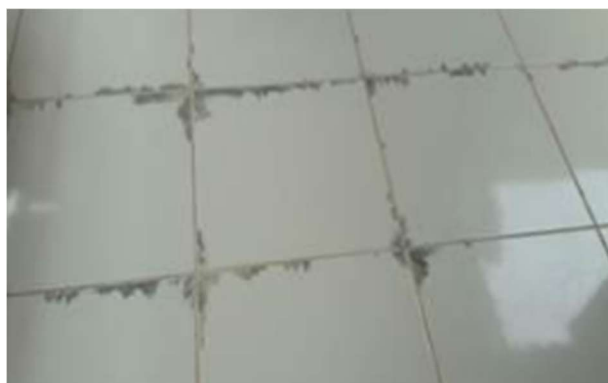
Figura 36 – Presença de bolores nas juntas das placas cerâmicas.
