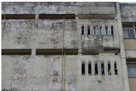
Figura 42 – Manchas na superfície da fachada devido a presença de fungos.
