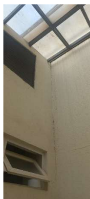
Fotografia 76 – Fissuras verticais no encontro das paredes (Cor no gráfico: alaranjado).
