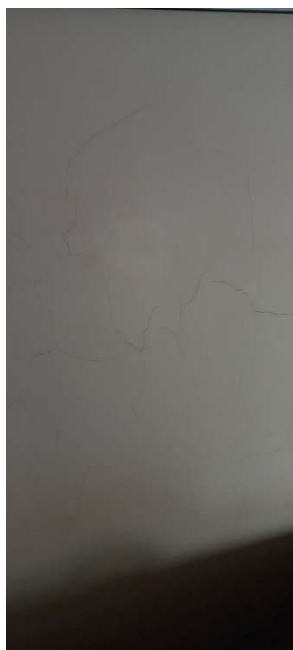
Fotografia 12 – Fissuras com espessura de 0,25 mm mapeadas na superfície da parede com acabamento em tinta (Cor no gráfico: alaranjado claro).
