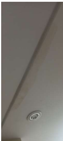
Fotografia 39 – Manchas amareladas no forro próximo a junta de dilatação (Cor no gráfico: verde).
