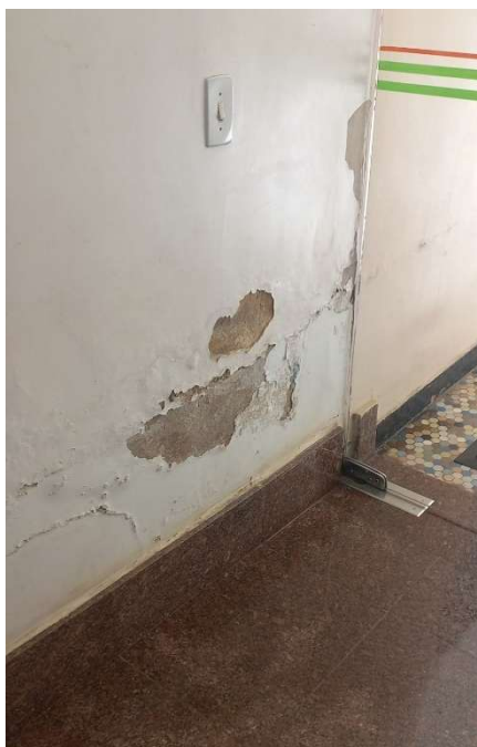
Fotografia 29 – Bolhas na pintura da parede com destacamento, próximo à entrada da circulação para o Foyer 2, em decorrência de umidade externa (Cor no gráfico: rosa).
