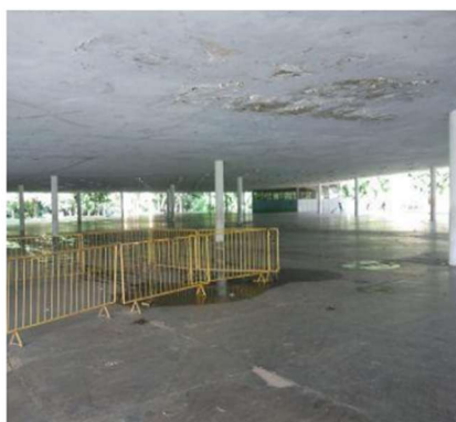
Figura 47 – Presença de manchas e bolhas na superfície inferior da cobertura.
