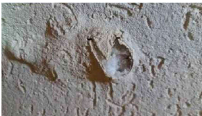
Figura 27 – Bolhas causadas por empolamento.
