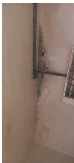
Fotografia 73 – Presença de bolor em toda região do forro com fissura e deslocamento do acabamento em tinta (Cor no gráfico: azul).
