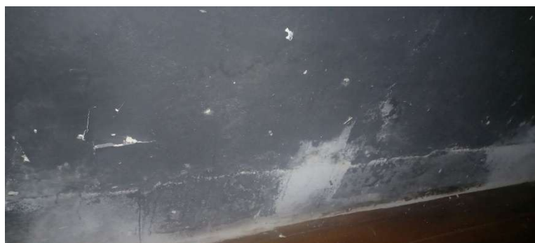
Fotografia 53 – Descascamento e manchas esbranquiçadas (eflorescência) na parede por trás do telão do Teatro, ou seja, uma parede de vedação externa (Cor no gráfico: verde).
