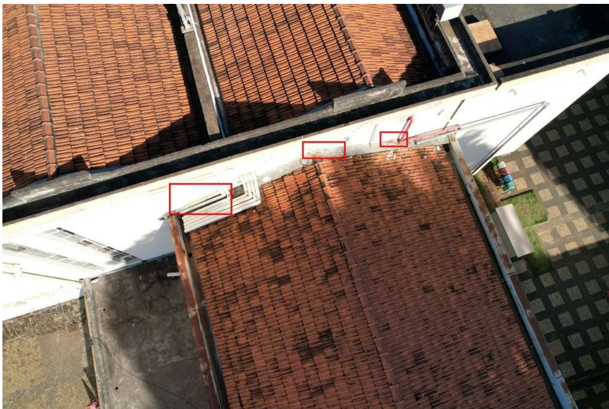
Figura 65 – Vista aérea da cobertura do Teatro IFG Campus Goiânia registrada por volta das 08:00 na região de divisa entre o Bloco do Teatro e os sanitários do Térreo, com destaque para falha de vedação do rufo em sua junção com a superfície da fachada.
