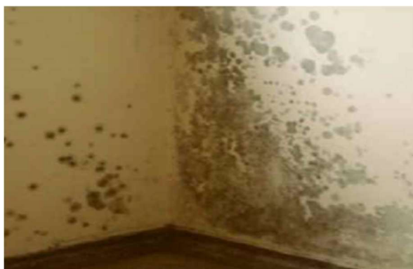
Figura 30 – Presença de bolor em parede.
