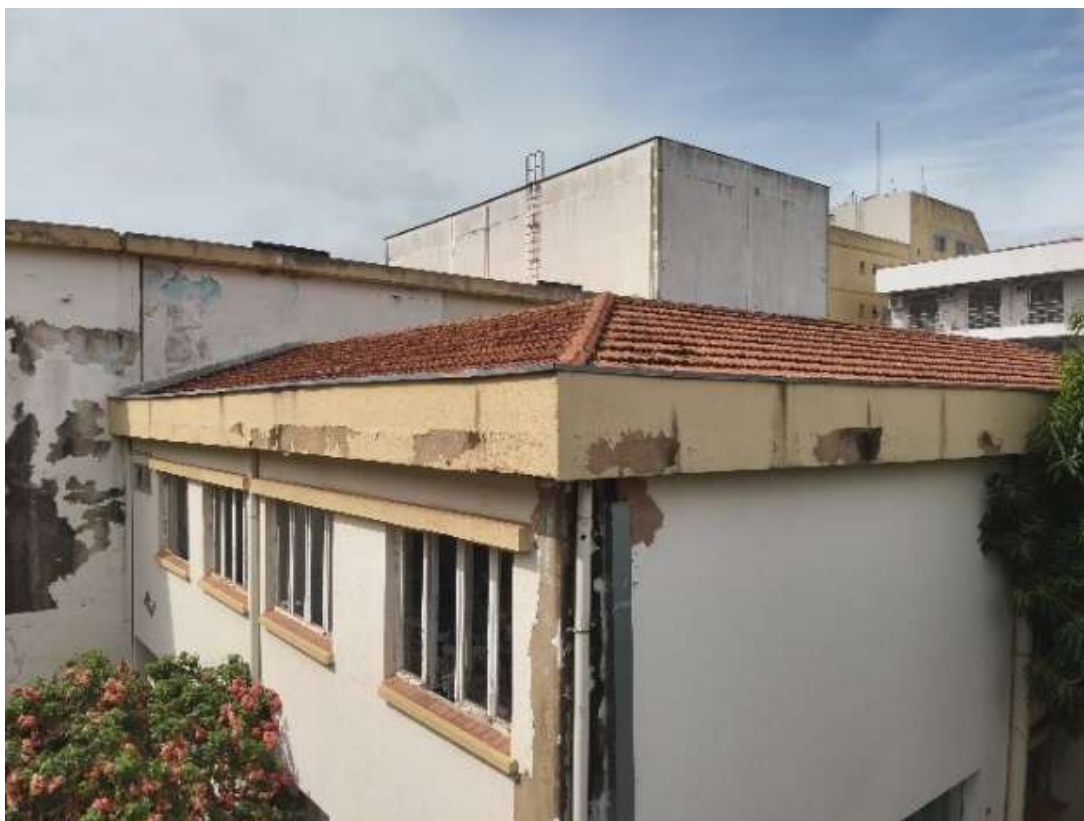
Figura 73 – A: Visão de parte da Fachada Norte e Oeste referente a sala de dança. B: Representação termográfica da Figura 73 A.
