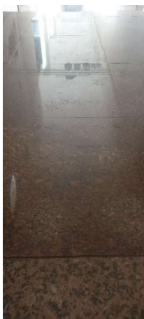
Fotografia 31 – Placas cerâmicas do piso descascando devido o uso e operação (Cor no gráfico: roxo).
