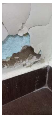
Fotografia 16 – Destacamento da tinta e do reboco apresentando aspecto pulverulento, na circulação próximo aos sanitários do Foyer (Cor no gráfico: rosa e azul claro).
