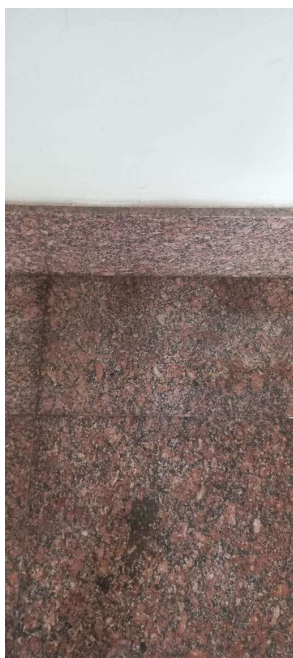
Fotografia 13 – Placas cerâmicas do piso com manchas de umidade e som cavo (Cor no gráfico: amarelo e roxo claro).
