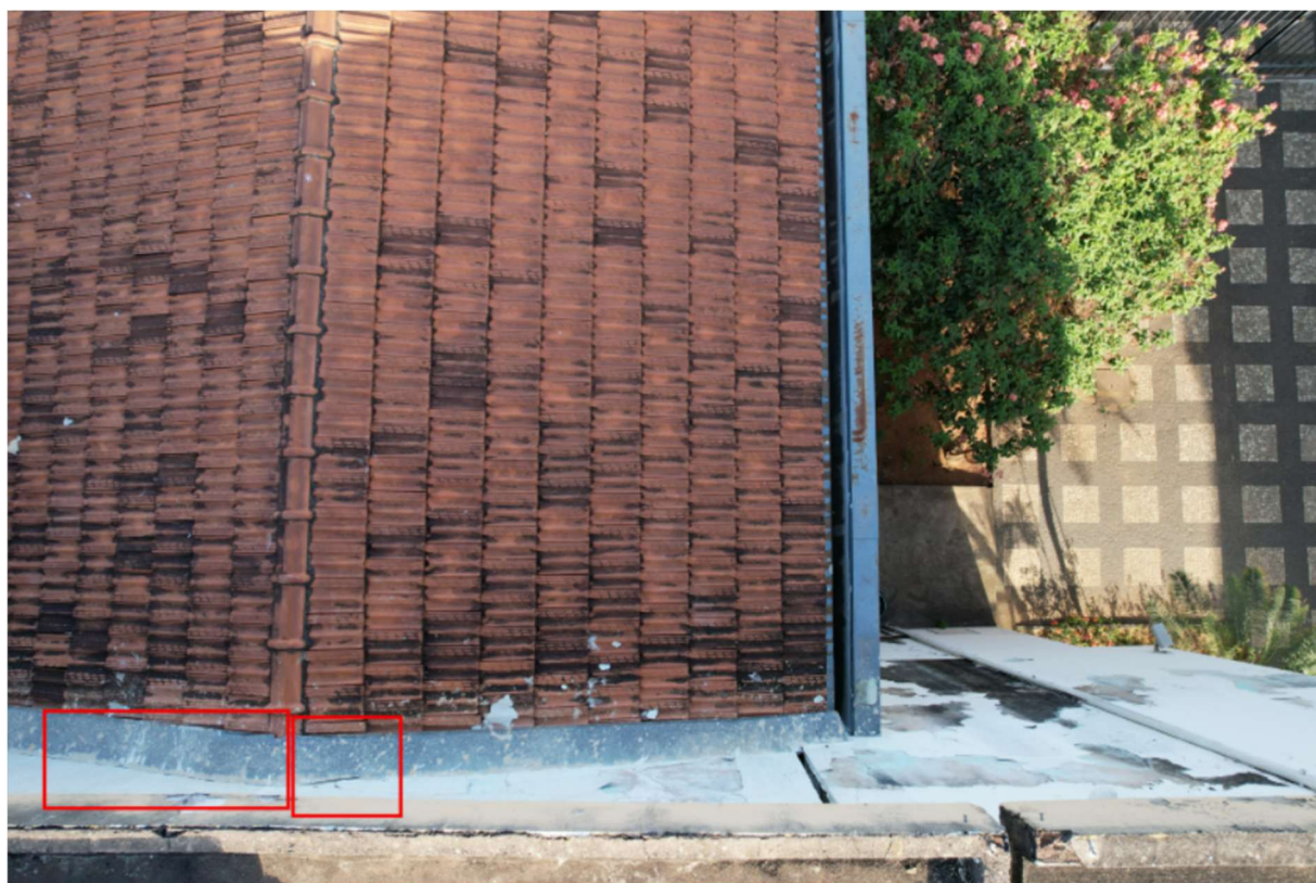
Figura 64 – Vista aérea da cobertura do Teatro IFG - Campus Goiânia registrada por volta das 08:00 da região de divisa entre o Bloco do Teatro e o Bloco das salas de música e dança, com destaque para falha de vedação do rufo em sua junção com a superfície da fachada.
