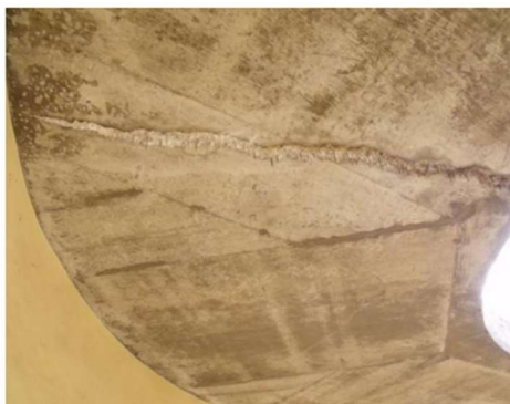
Figura 46 – Aparição de estalactites na parte inferior da cobertura devido à eflorescência.
