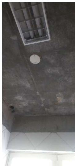
Fotografia 84 – Eflorescência na laje da região dos sanitários (Cor no gráfico: verde).
