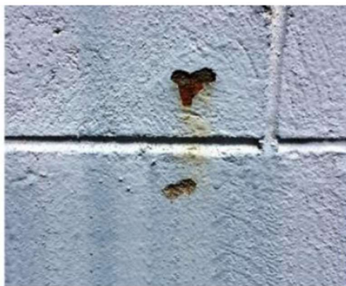
Figura 23 – Vesícula em reboco.
