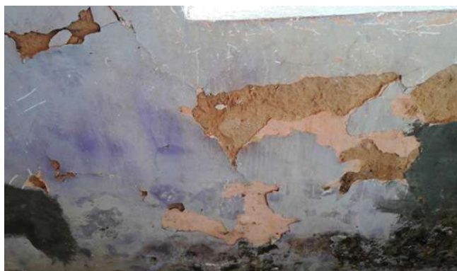
Figura 26 – Descolamento por empolamento.
