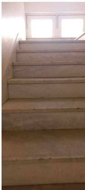
Fotografia 36 – Fissuras devido ao uso e operação nas pedras das escadas que vai à casa de força (Cor no gráfico: branco).
