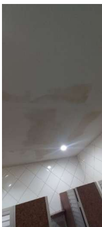
Fotografia 23 – Manchas amareladas no forro do banheiro feminino devido a presença de umidade (Cor no gráfico: eflorescência).
