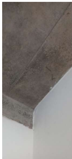
Fotografia 78 – Armadura exposta na laje da sala de dança (Cor no gráfico: amarelo queimado).
