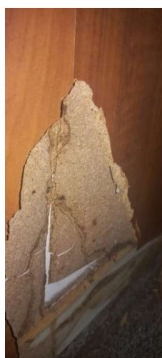
Fotografia 49 – Deterioração do revestimento em madeirite da lateral da plateia inferior do Teatro (Cor no gráfico: cinza)
