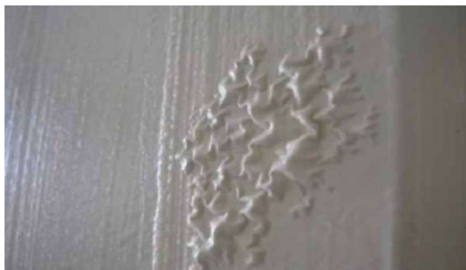
Figura 28 – Enrugamento da superfície pintada.
