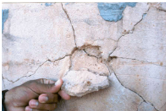
Figura 45 – Destacamento do reboco devido baixo consumo de aglomerantes.
