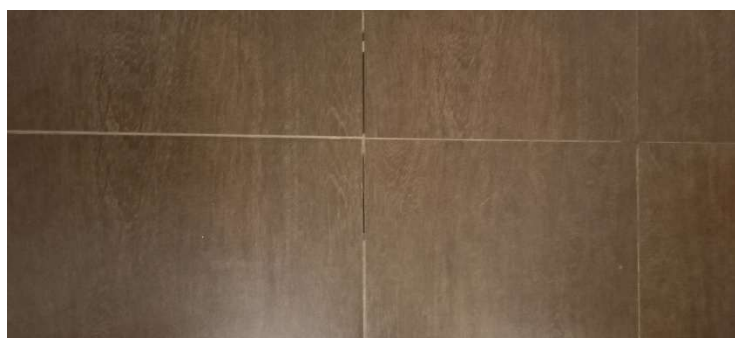
Fotografia 28 – Ausência de rejunte e presença de som cavo no piso cerâmico do banheiro masculino (Cor no gráfico: vermelho).
