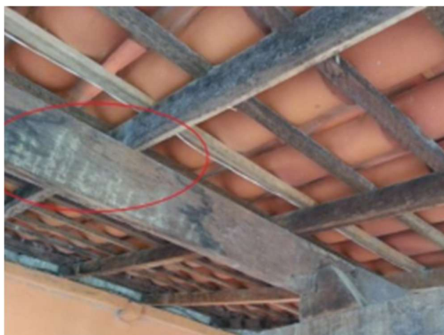
Figura 49 – Manchas na madeira devido a umidade.
