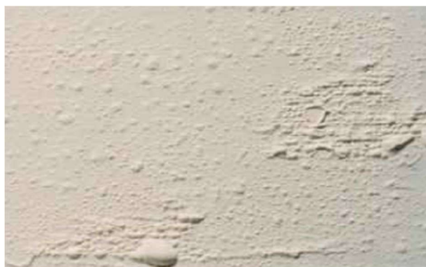
Figura 29 – Bolhas pela perda de adesão da pintura.
