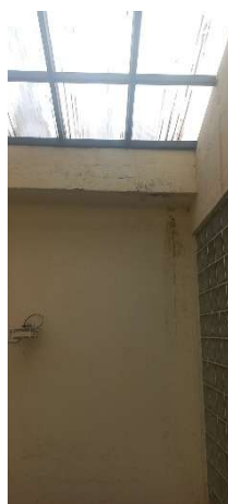
Fotografia 75 – Fissuras horizontais e verticais na viga e presença de manchas (Cor no gráfico: verde claro e azul).
