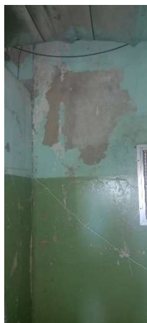
Fotografia 67 – Destacamento/Descascamento da pintura da sala de pressurização (Cor no gráfico: rosa).
