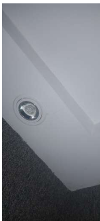
Fotografia 52 – Fissuras em volta da iluminação da Antecâmara Teatro (Cor no gráfico: verde claro).
