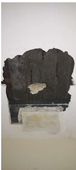
Fotografia 09 – Placa de gesso deteriorada e com manchas amareladas pela presença de umidade (Cor no gráfico: rosa claro).
