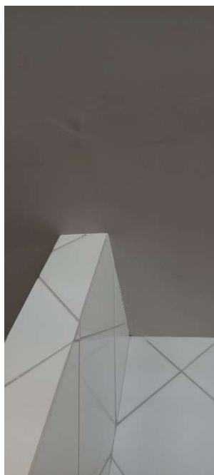
Fotografia 26 – Fissuras no forro do banheiro masculino devido ao esforço mecânico (Cor no gráfico: verde claro).
