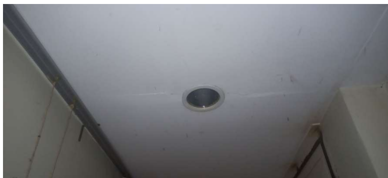
Fotografia 62 – Fissura no forro, em toda a extensão na direção da luminária (Cor no gráfico: verde claro).
