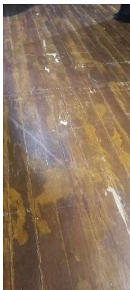
Fotografia 56 – Descascamento do piso de madeira do palco do Teatro (Cor no gráfico: roxo).
