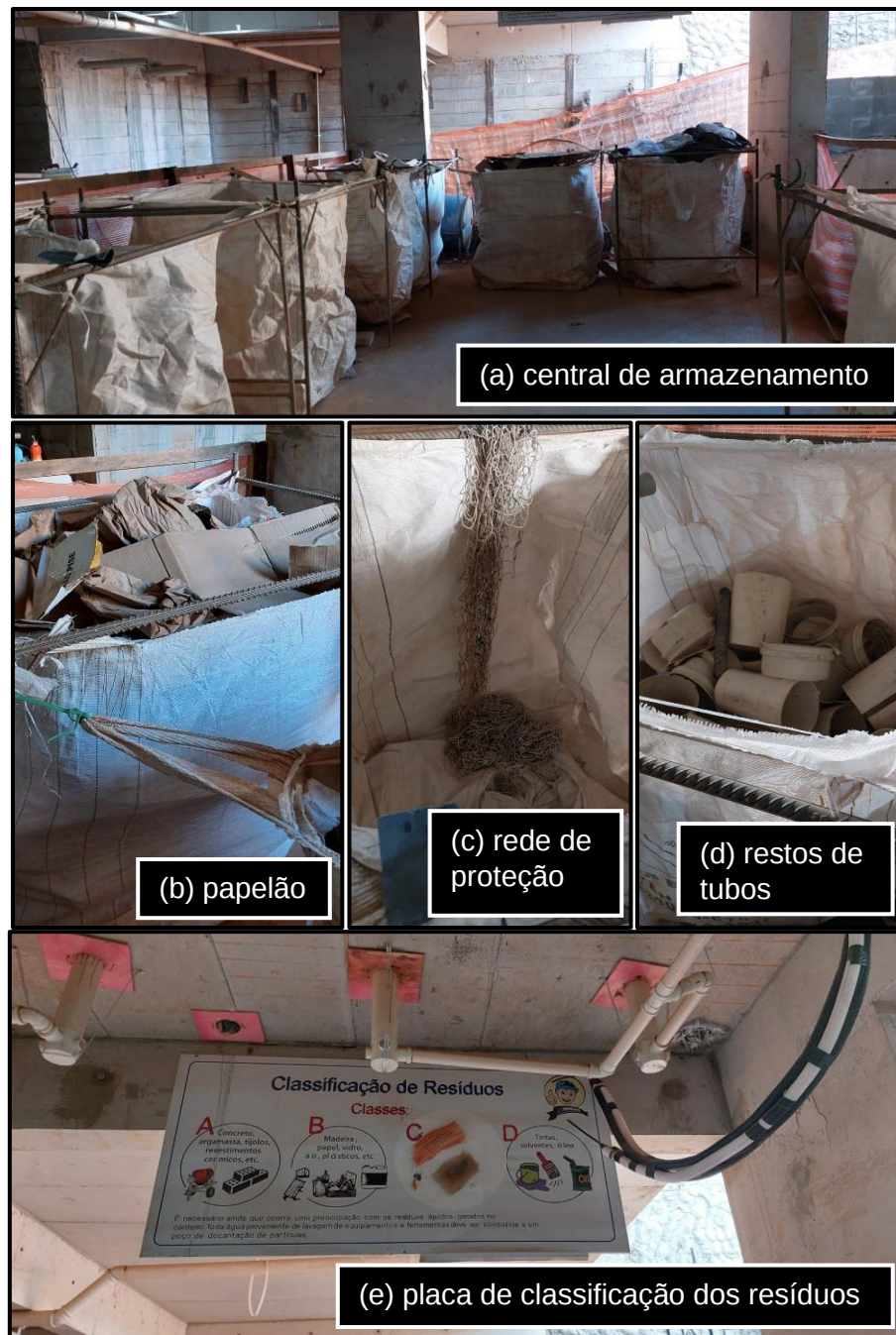
Figura 3 - Central de armazenamento dos resíduos da construção civil (a); bag para armazenamento de papelão (b), rede de proteção (c), restos de tubos (d); placa de classificação dos resíduos (e)
