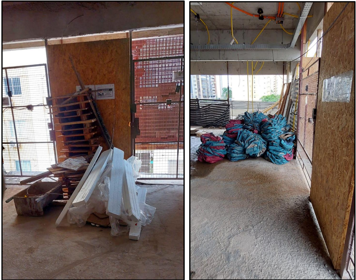
Figura 7 – Resíduos próximo à cremalheira
