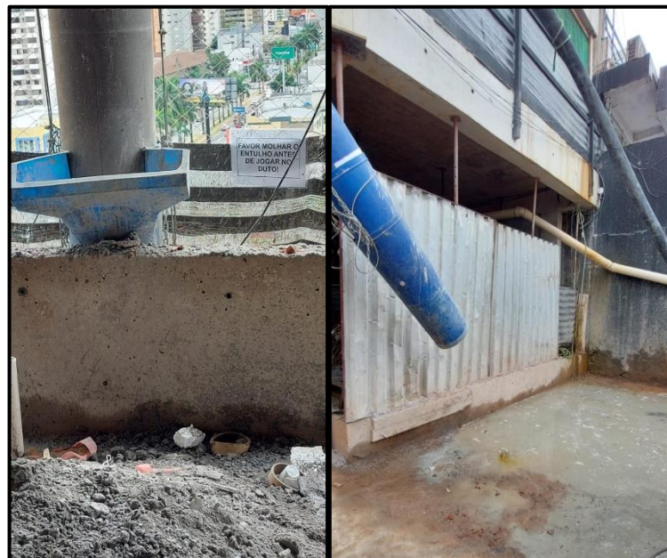
Figura 10 - Duto para resíduos Classe A
