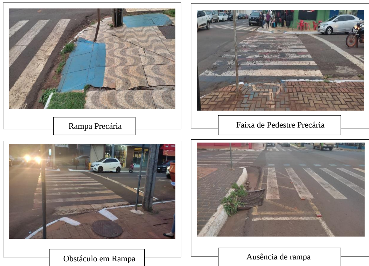
Figura 4.8 – Problemas encontrados nas travessias
