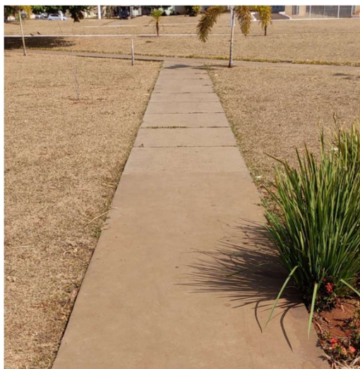
Figura 4.10: Material presente no piso da calçada
