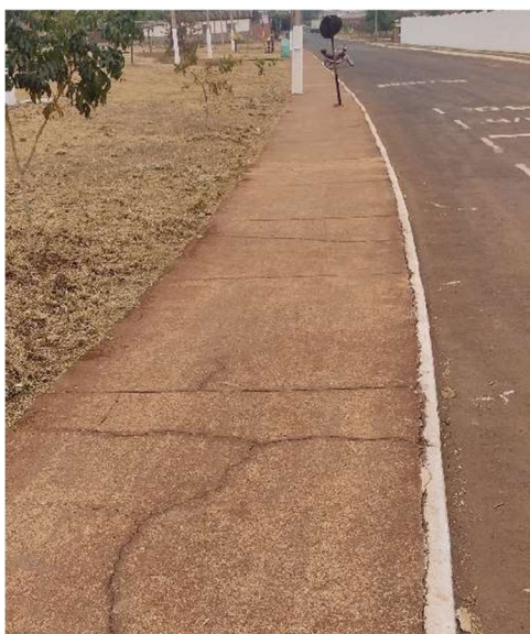
Figura 4.28: Falta de Sinalização na calçada
