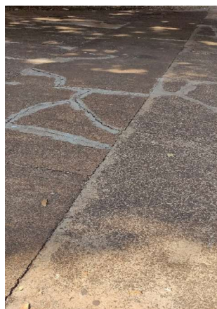
Figura 4.53: Rachaduras devido a raízes
