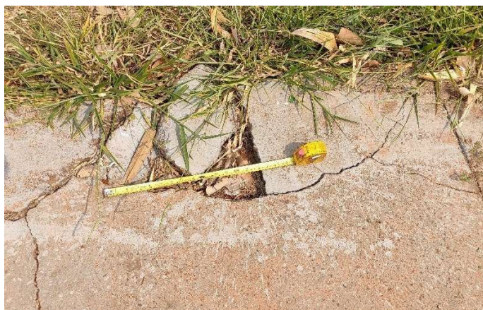
Figura 4.44: Exemplo de buraco encontrado na calçada
