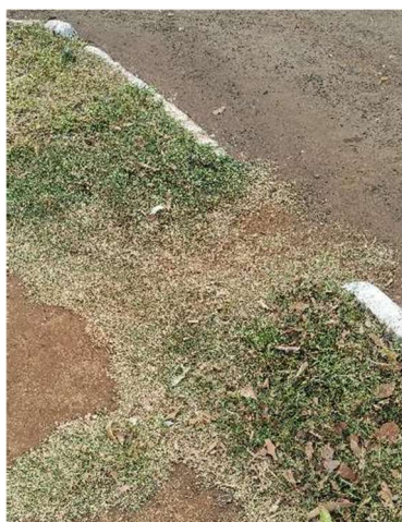
Figura 4.63: Rampa de acesso irregular
