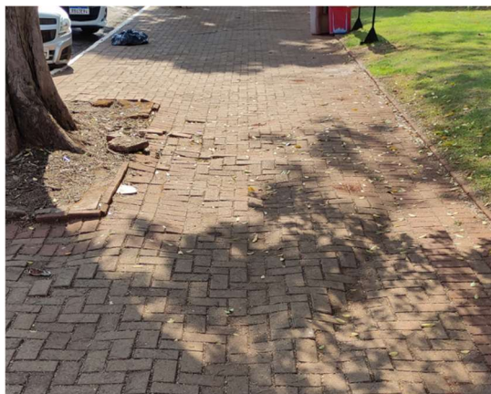
Figura 4.19: Patologia presente na calçada
