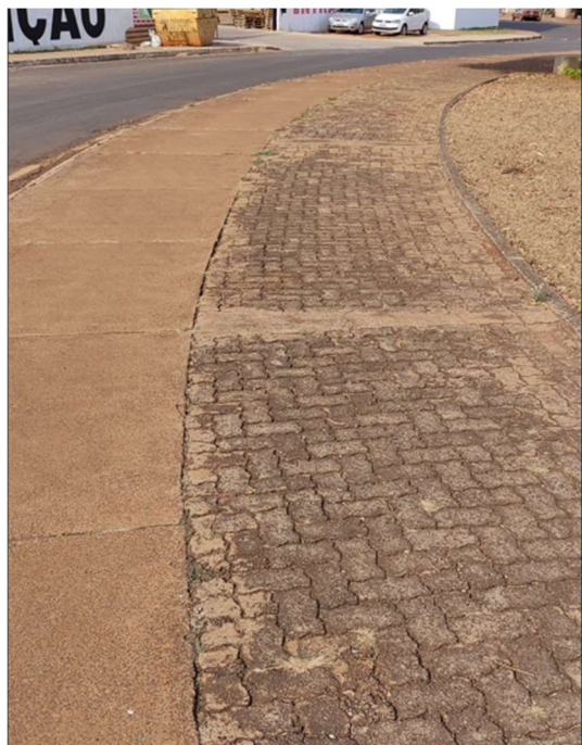
Figura 4.2: Material presente no piso da calçada
