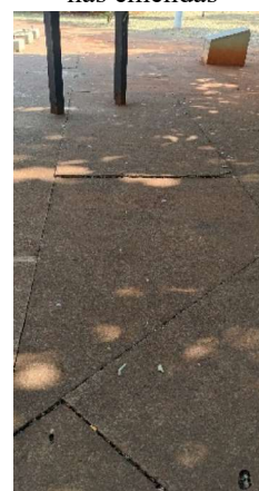
Figura 4.54: Trepidação nas emendas
