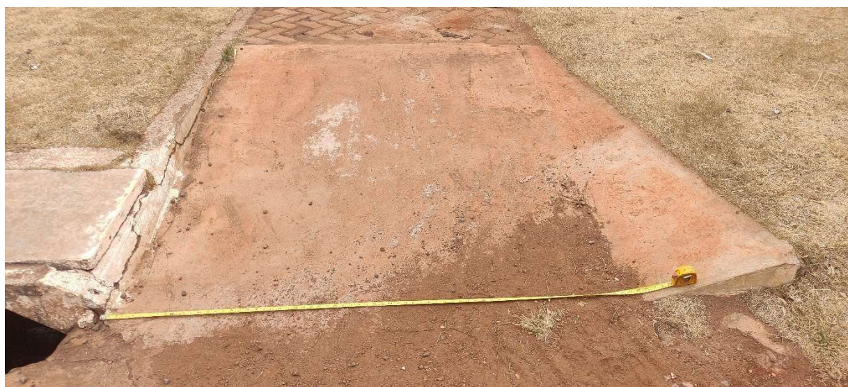
Figura 4.36: Rampa de acesso em desconformidade a norma
