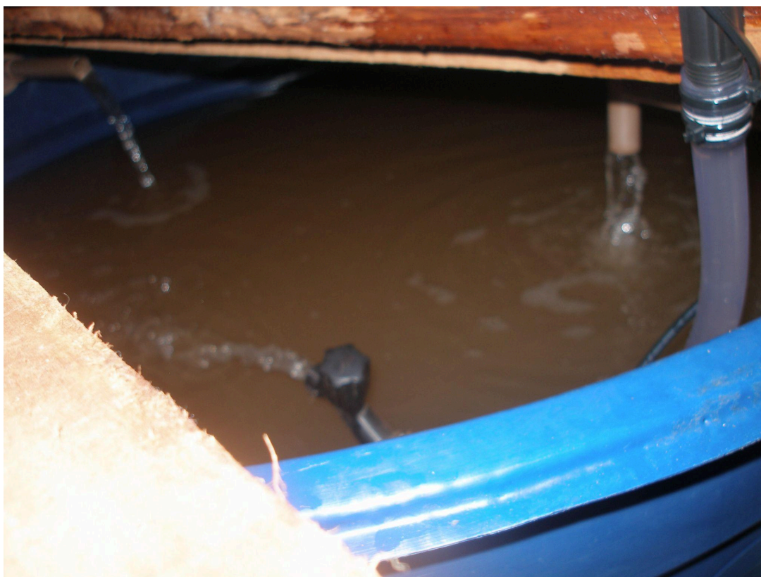
Figura 9 - Tanque de água de PBDL (Polietileno de Baixa Densidade Linear) com capacidade de 500L.
