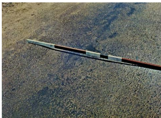
Figura 6 - Afundamento de consolidação
