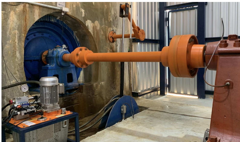
Figura 3.8 – Turbina Francis ligada ao gerador.
