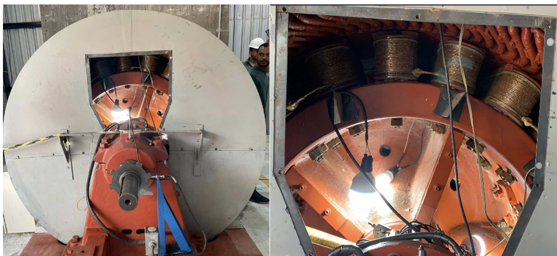
Figura 3.11 – Bobinas do rotor de um gerador síncrono de uma usina PGH.
