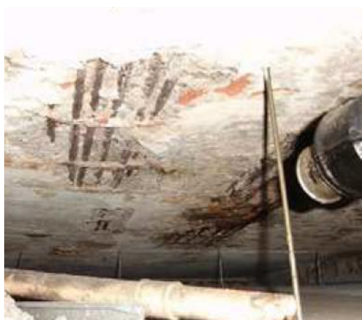
Figura 6: Armadura exposta devido à má impermeabilização.
