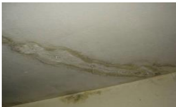
Figura 1: Patologia devido à umidade.
