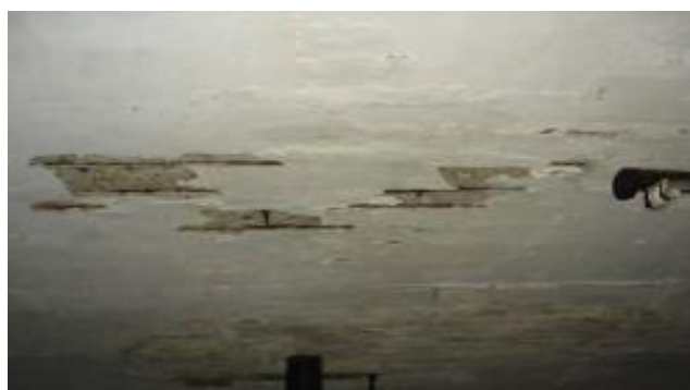
Figura 2: Patologia decorrente à umidade.
