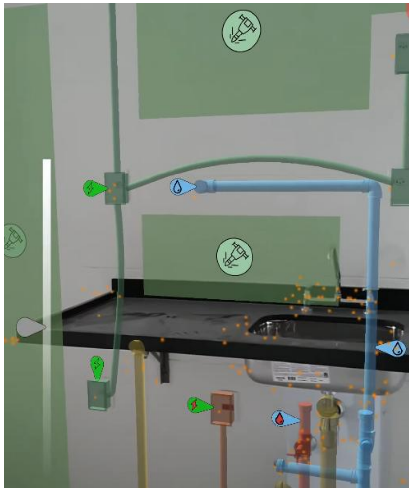
Figura 3.20 – O aplicativo mostra as instalações com etiquetas e as áreas que permitem furações marcadas em verde
