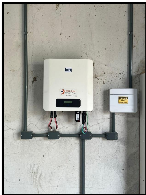
Figura 21 – Inversor - SFCR I – Mineiros-GO Fonte: [Autoria Própria]
