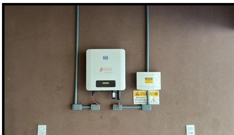
Figura 33 – Inversor - SFCR III – Alto Araguaia-MT Fonte: [Autoria Própria]
