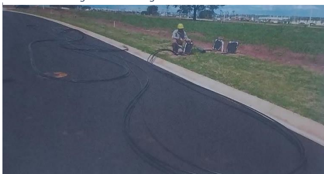
Figura 22: Passagem de Cabos Elétricos
