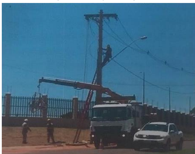
Figura 27: Instalação de Religador
