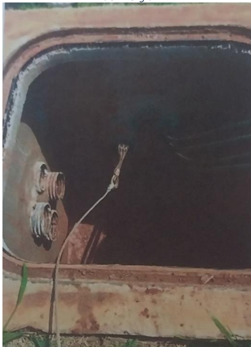
Figura 21: Caixa de Passagem - Rede Subterrânea de Energia
