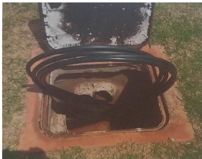
Figura 23: Passagem de Cabos Elétricos
