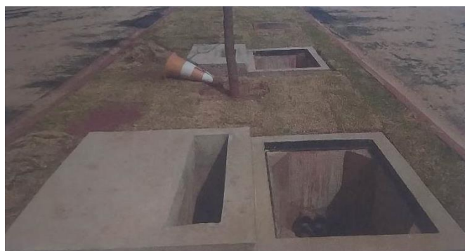
Figura 24: Bases dos Transformadores e Quadros de Distribuição
