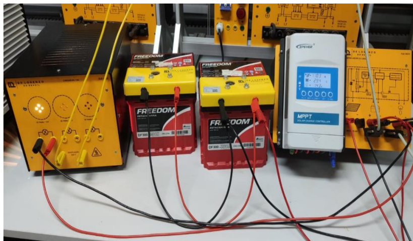
Fig.33 – Baterias ligadas em paralelo e carga de 50 Watts que foi conectada ao controlador de carga.
