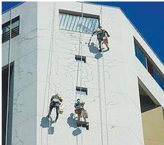
Figura 17 - Fissura mapeada causada por retração de secagem da argamassa
