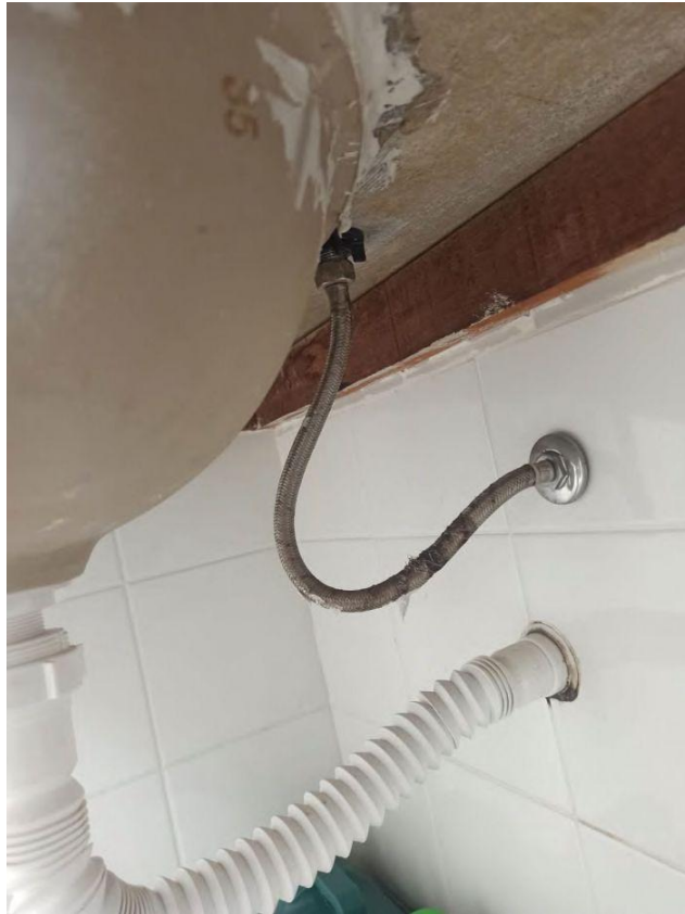
Figura 29 –Danos na Parte Hidráulica-Agência X
