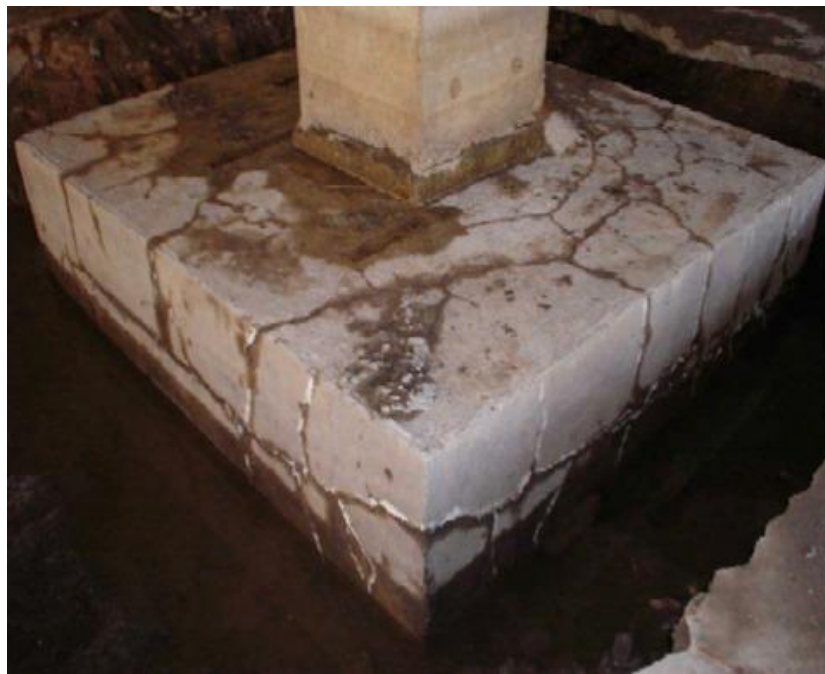
Figura 11 - Fissura em bloco de concreto por reação álcali-agredado
