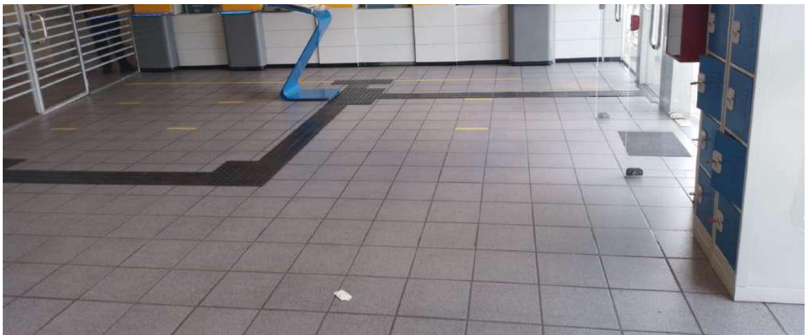
Figura 27 –Piso danificado por má utilização-Agência Z
