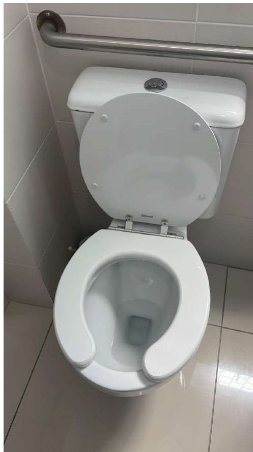
Figura 32 –Vaso instalado fora de norma-Agência Y
