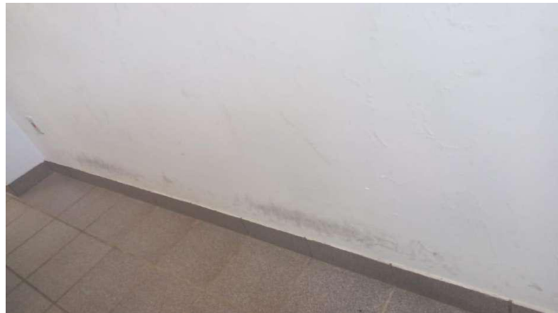
Figura 24 –Parede sendo danificada por má utilização-Agência Z
