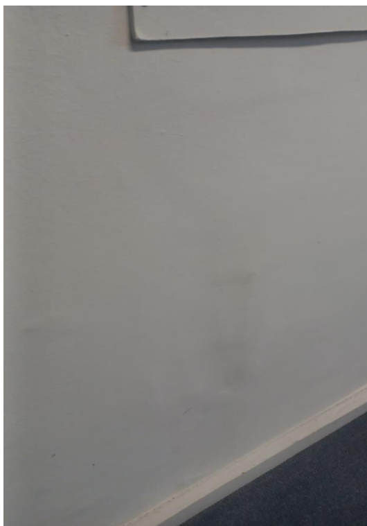
Figura 22 – Parede manchada-Agência X
