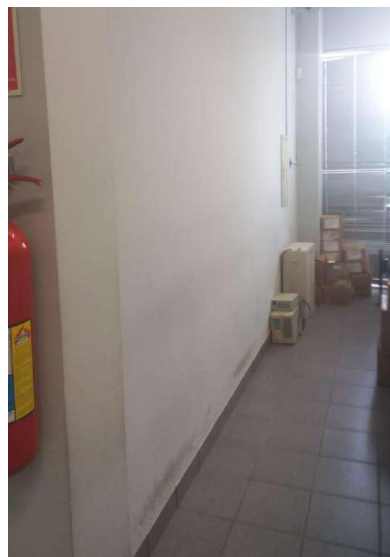
Figura 25 –Parede sendo danificada por má utilização-Agência Z
