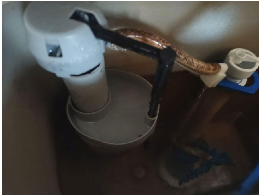
Figura 30 –Válvula de descarga Danificada -Agência X
