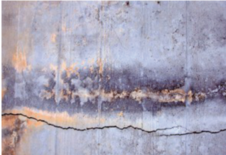
Figura 12 - Fissura em bloco de concreto por sulfato
