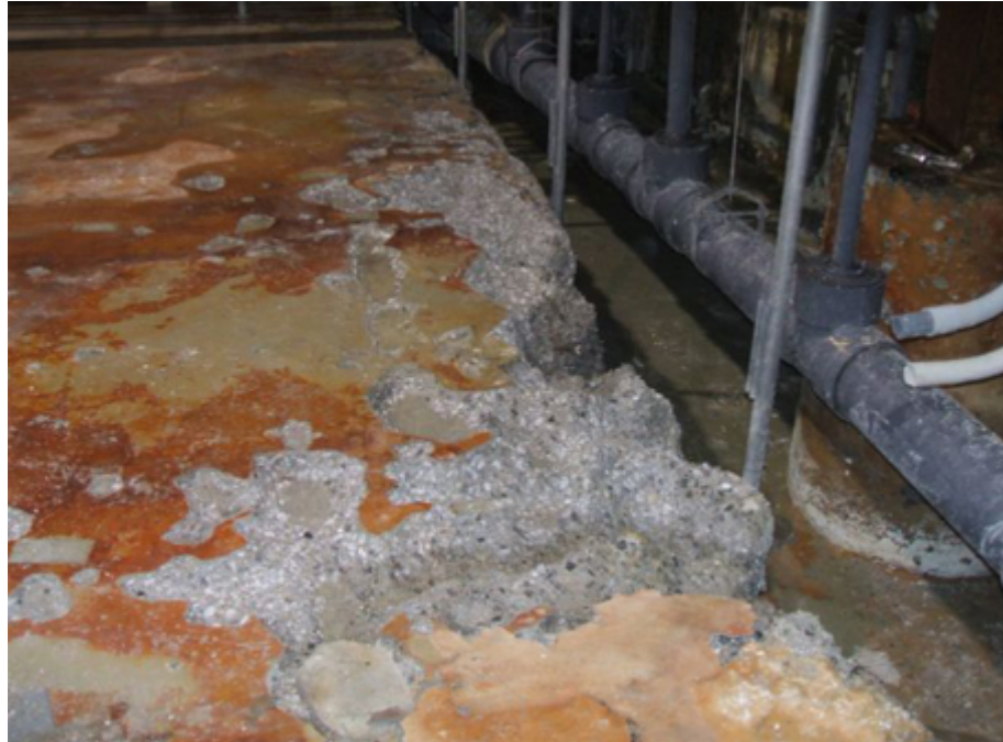
Figura 13 - Lixiviação do concreto causada por águas ácidas de um reservatório
