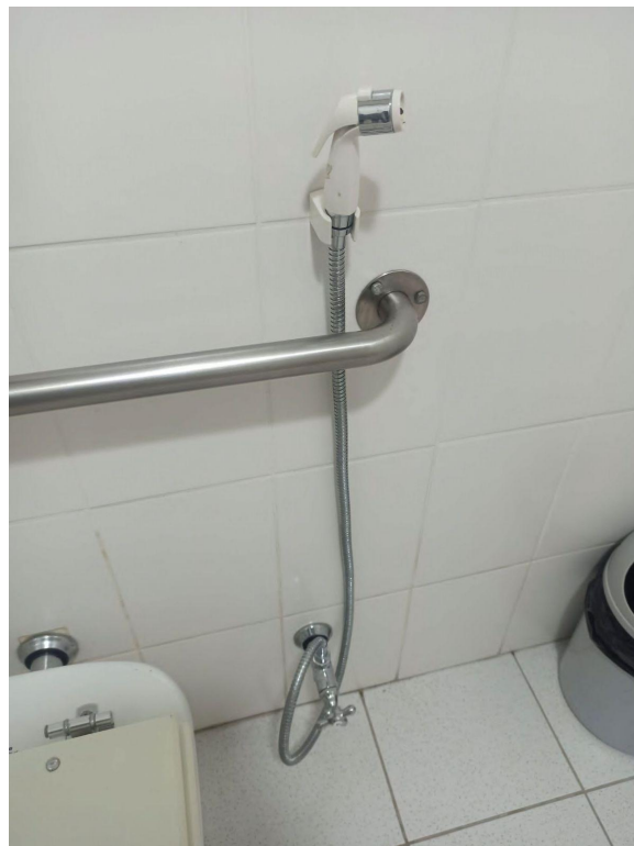
Figura 31 –Falha de instalação -Agência X
