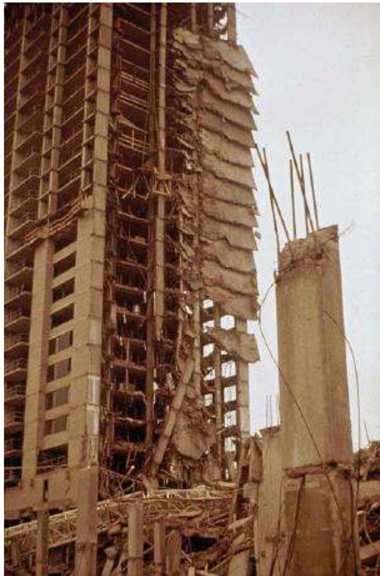
Figura 10 - Skyline Plaza Apartments, Virgínia, 1973. A estrutura composta por lajes lisas de concreto armado sofreu colapso progressivo durante a construção do 24º pavimento.
