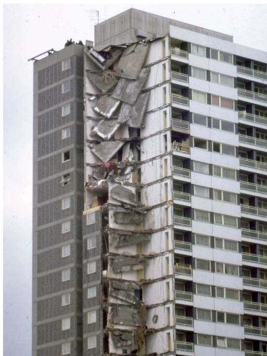
Figura 1 – Edifício Ronan Point em Londres, 1968. Destruição causada pela explosão.
