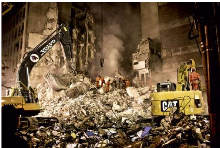
Figura 2 – Edifício Liberdade, escombros após desabamento.
