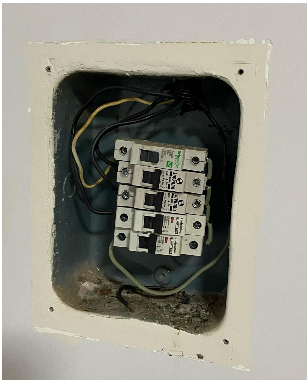
Figura 4.2: Quadro Elétrico Original
