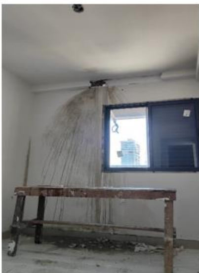
Figura 4 – Quebra da moldura de gesso em placa e furo na alvenaria para passagem de rede frigorífica para o dreno
