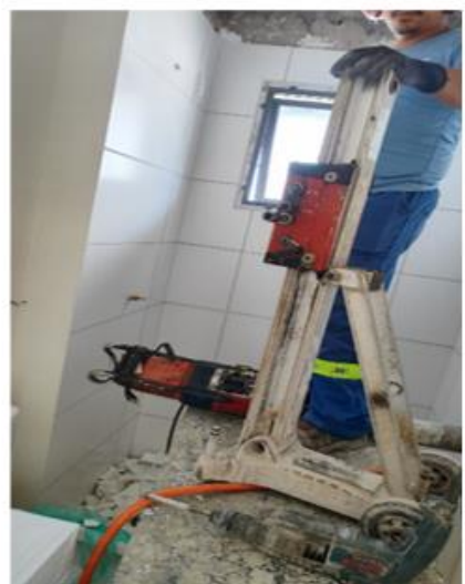
Figura 3 – Furo na viga para passagem de rede frigorífica
