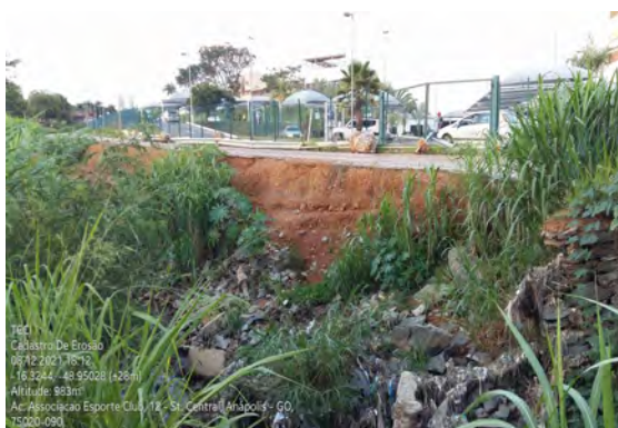
(c) A erosão destruiu a metade da pista.
