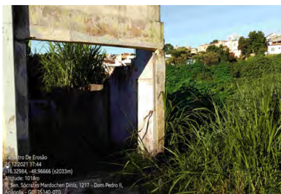
(c) Edificação dentro da erosão.
