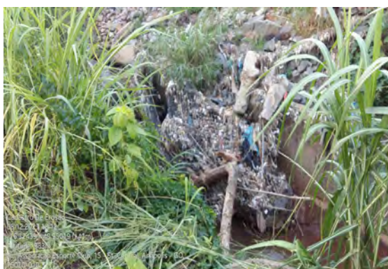
(a) Desmoronamento do muro de gabião.
