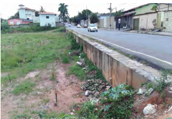
(c) Não existe calçada entre o muro e a rua Leopoldo de Bulhões.
