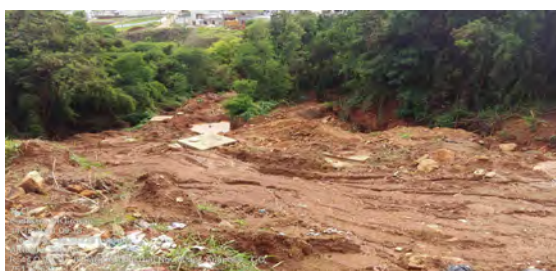
(c) Inclinação do terreno e entulho.
