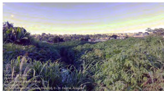
(b) Erosão de margem fluvial com desnível de aproximadamente 6 m.
