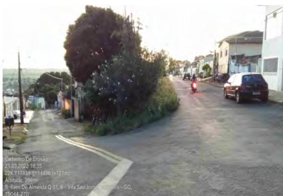
(c) Inclinação da pavimentação ao redor da voçoroca.
