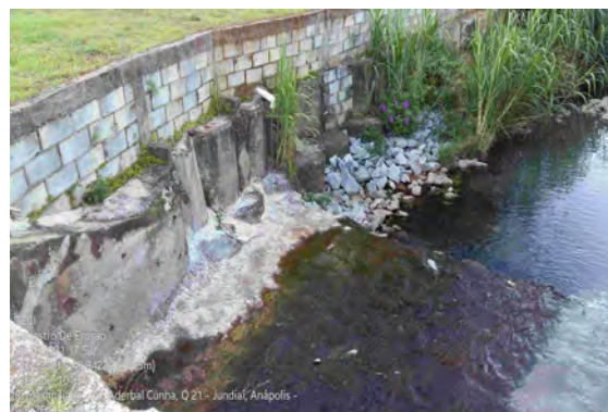
(b) Erosão de margem fluvial com desnível de aproximadamente 5 m.
