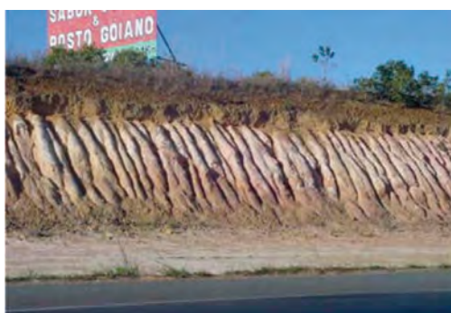
(a) Erosão em sulcos, BR 060.
