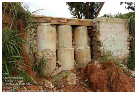
(d) Tentativa de conter a erosão da rua 127.
