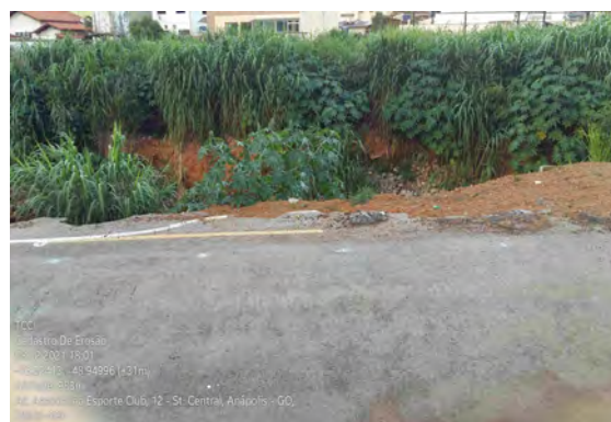
(b) Detalhe da erosão na pista.
