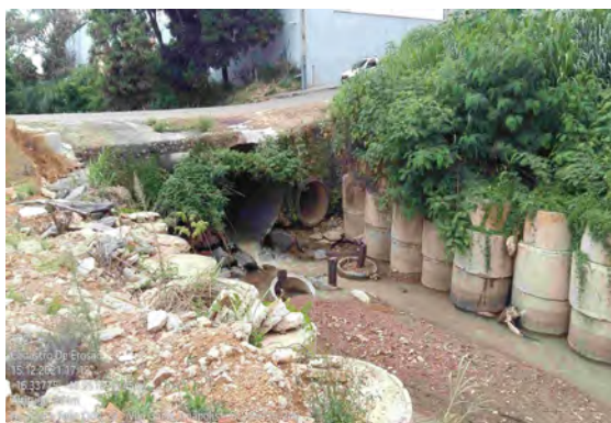
(c) Inclinação do terreno e entulho.
