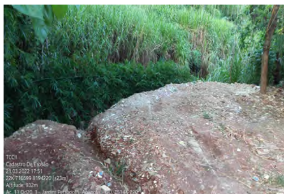
(c) Muito entulho e sem pavimentação.
