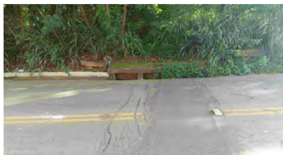
(b) Entrada de água fluvial esconde a erosão.
