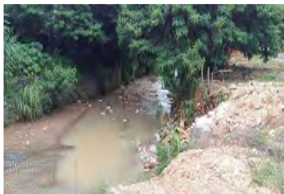
(b) Erosão de margem fluvial com desnível de aproximadamente 7 m.
