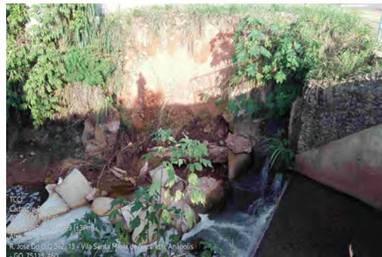
(b) Voçoroca com desnível de aproximadamente 15 m.
