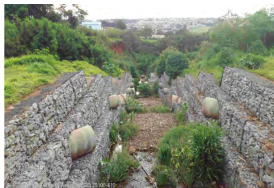
(b) Erosão com desnível de aproximadamente 40 m.
