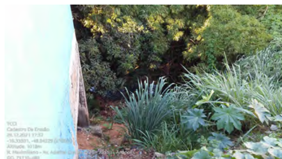
(d) Terreno ingreme com edificação dentro da erosão.
