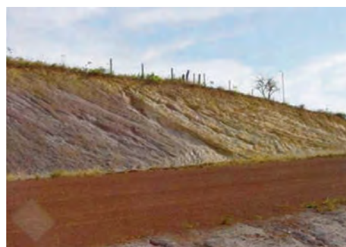
(b) Erosão em sulcos, BR 060.
