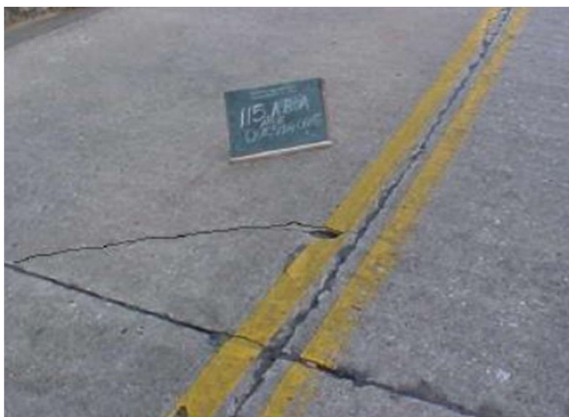
Figura 6 - Fissuração em pavimento de concreto simples
