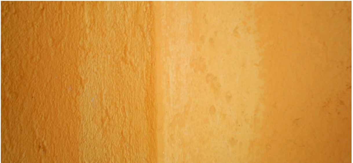
Figura 2.11 – Eflorescências na tinta
