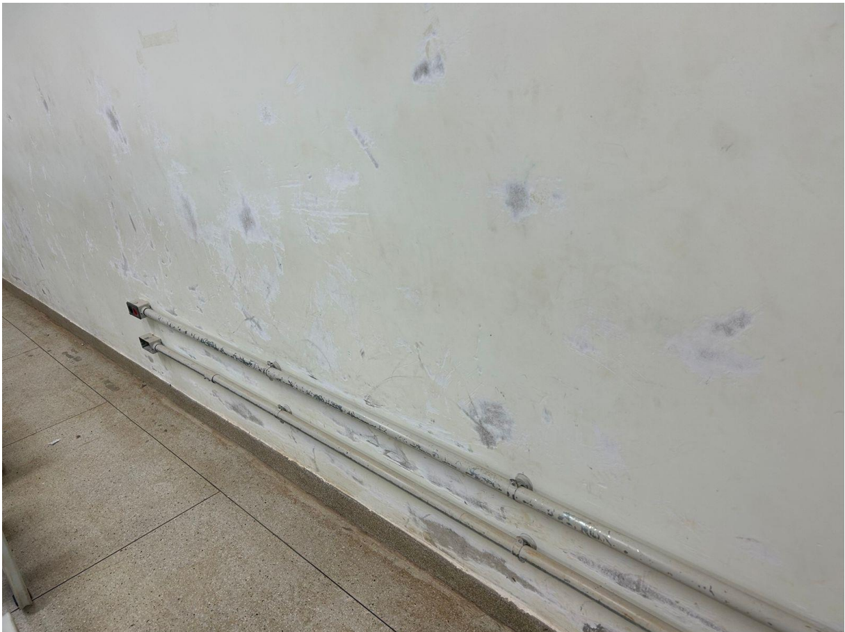
Figura 4.4 – Manifestação patológica em parede interna: desgaste
