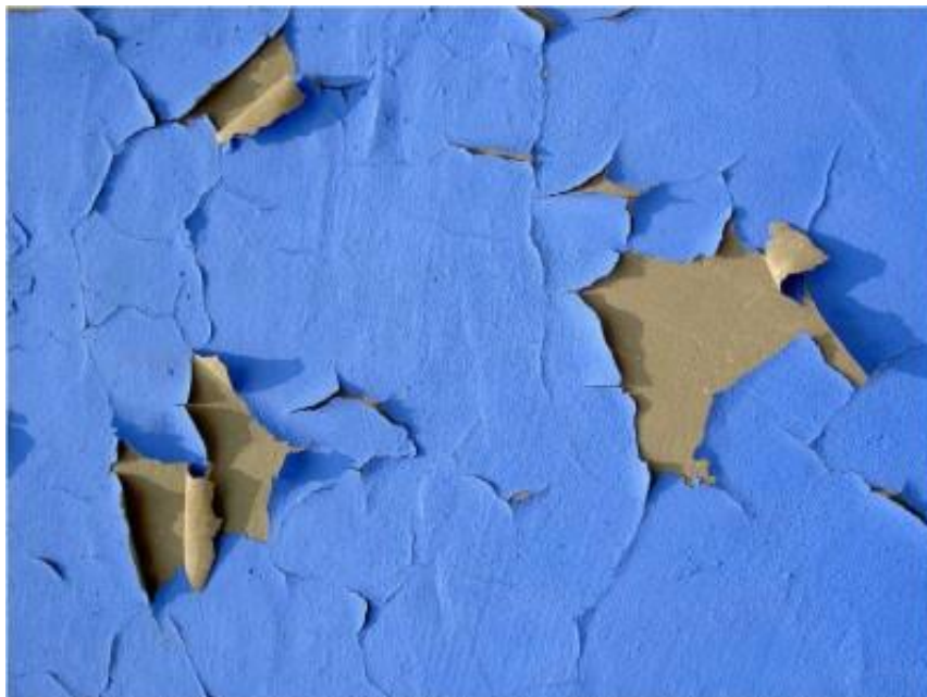
Figura 2.9 – Descascamento da pintura
