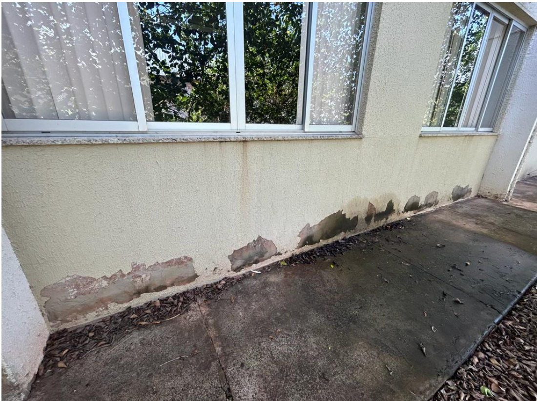
Figura 4.23 – Mofo devido respingos de chuva e dreno de ar condicionado nas partes inferiores da parede
