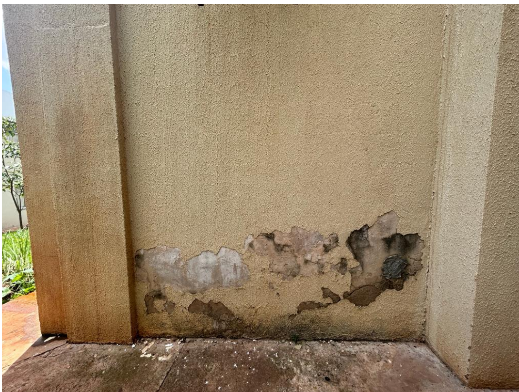
Figura 4.29 – Desagregamento em parede externa
