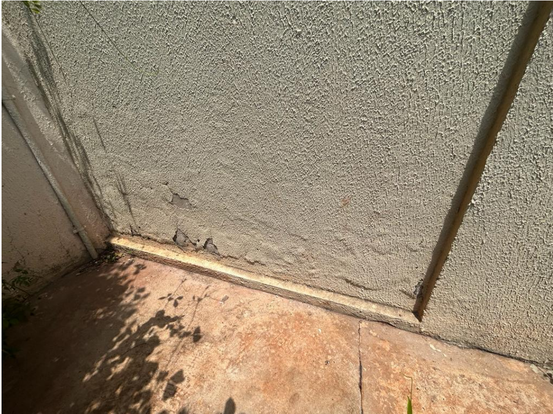
Figura 4.26 – Estufamento da textura por umidade em parede externa
