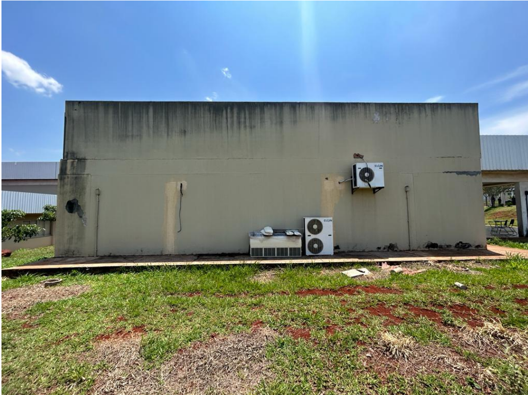
Figura 4.22 – Mofo devido infiltração nas partes inferiores e superiores da parede
