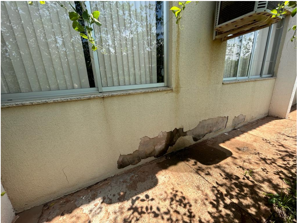
Figura 4.18 – Descascamento por respingos de chuva, dreno do ar condicionado e infiltração por capilaridade
