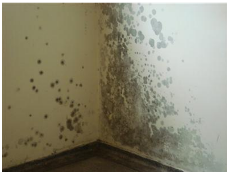
Figura 2.14 – Manchas de mofo ou bolor
