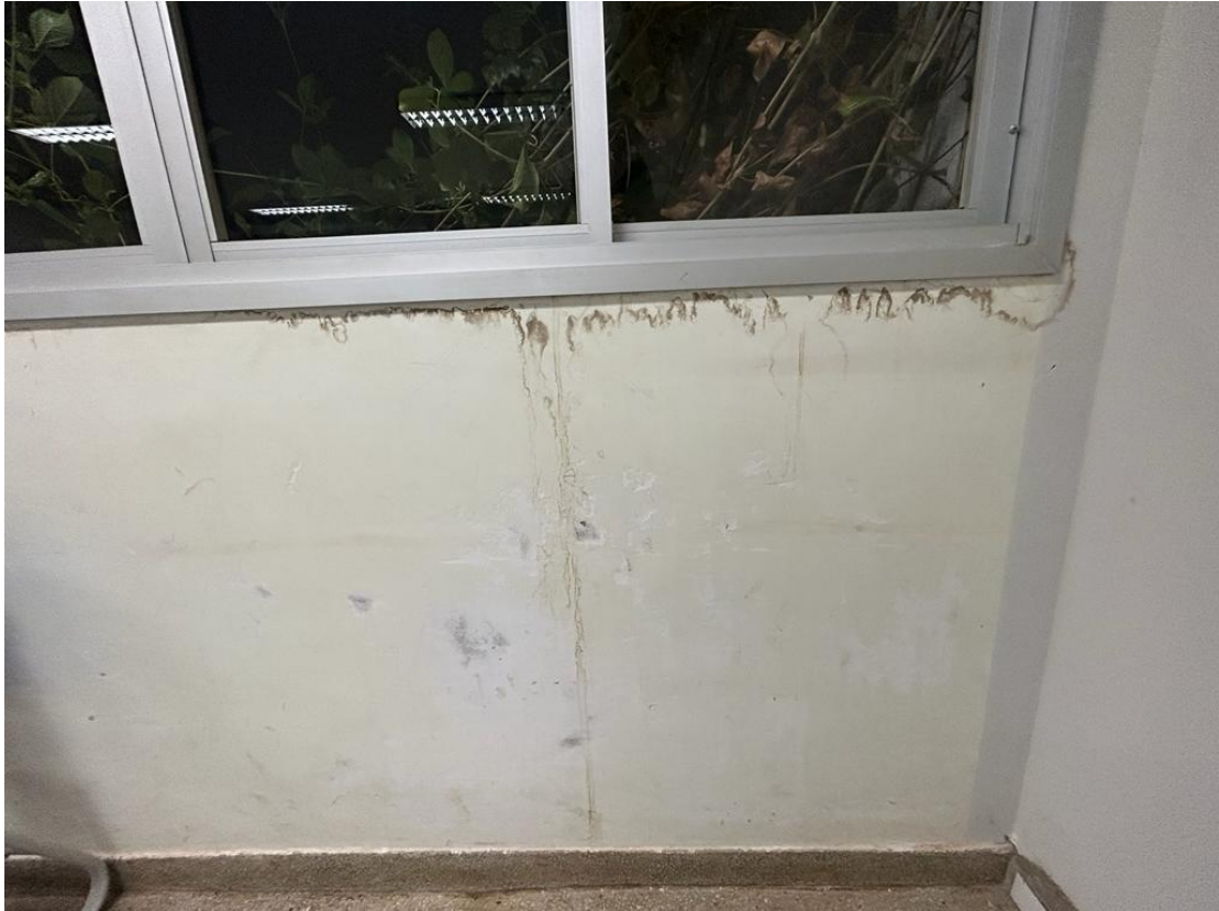
Figura 4.24 – Manchas de umidade devido a infiltração em janela
