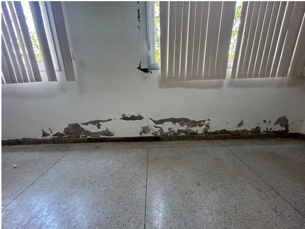
Figura 4.5 – Manifestação patológica em parede interna: descascamento
