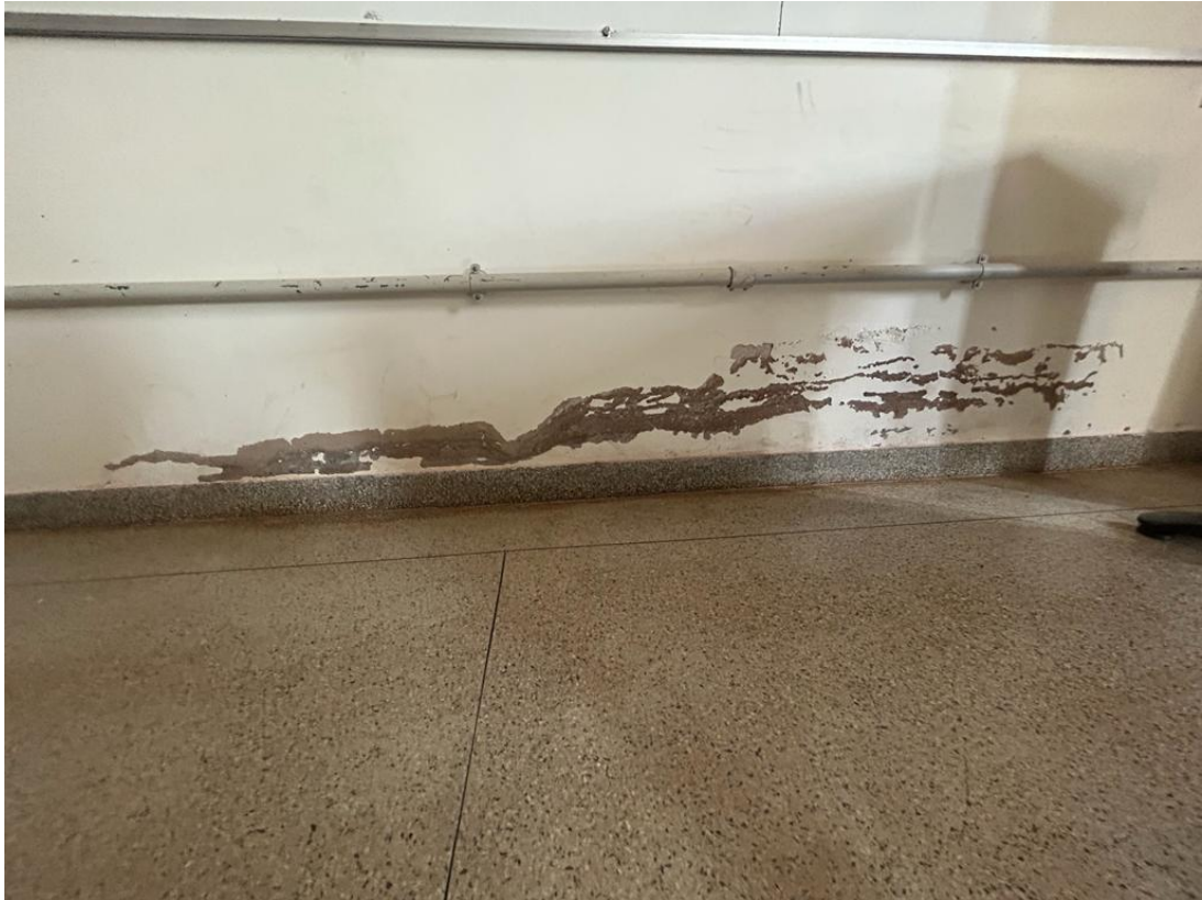
Figura 4.16 – Descascamento por infiltração por capilaridade
