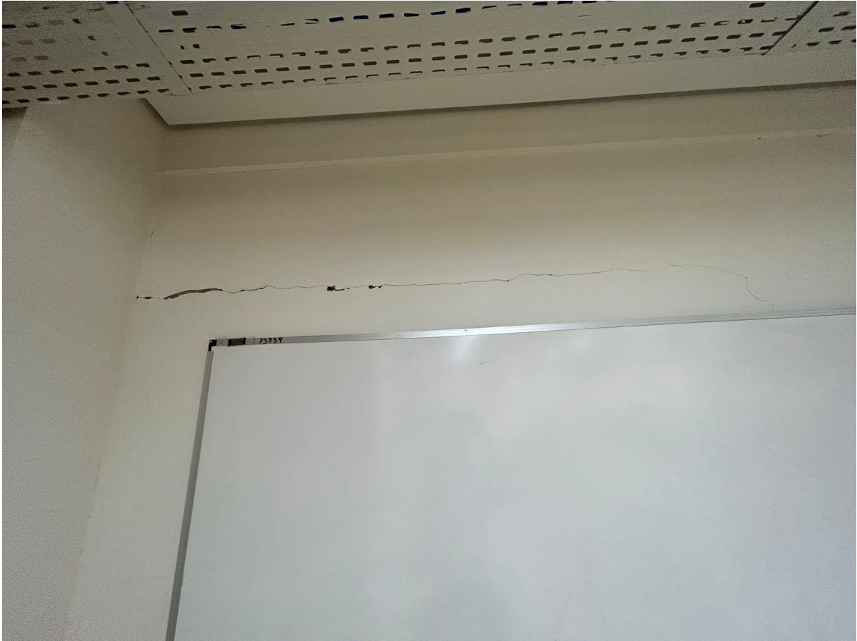
Figura 4.7 – Manifestação patológica em parede interna com origem não relacionada a pintura: fissura
