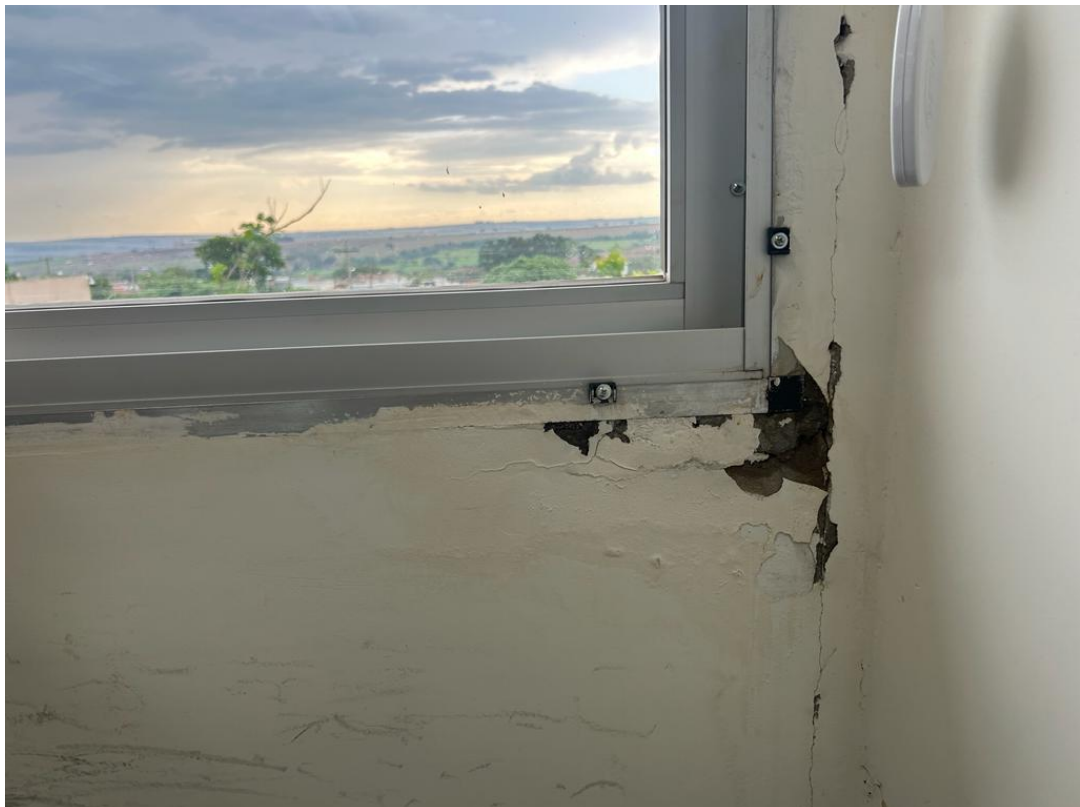
Figura 4.17 – Descascamento por infiltração na parte inferior da abertura (janela)
