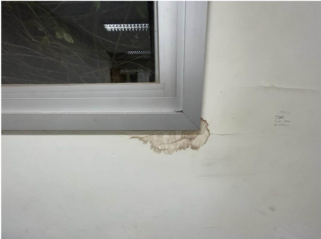
Figura 4.25 – Manchas de umidade devido a infiltração em janela
