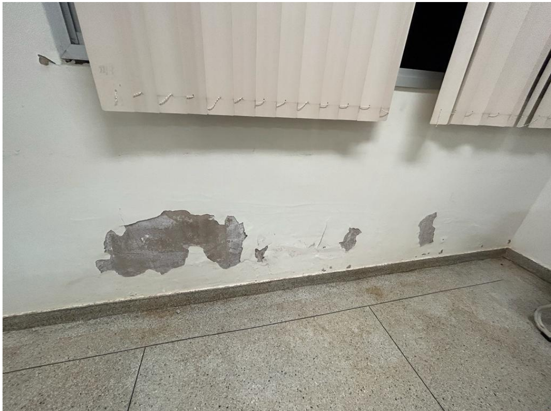
Figura 4.31 – Eflorescência em parede interna com descascamento devido a presença de umidade
