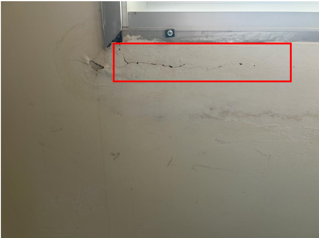
Figura 4.21 – Fissura evidente na pintura próximo a janela por falta ou má execução de contra-verga
