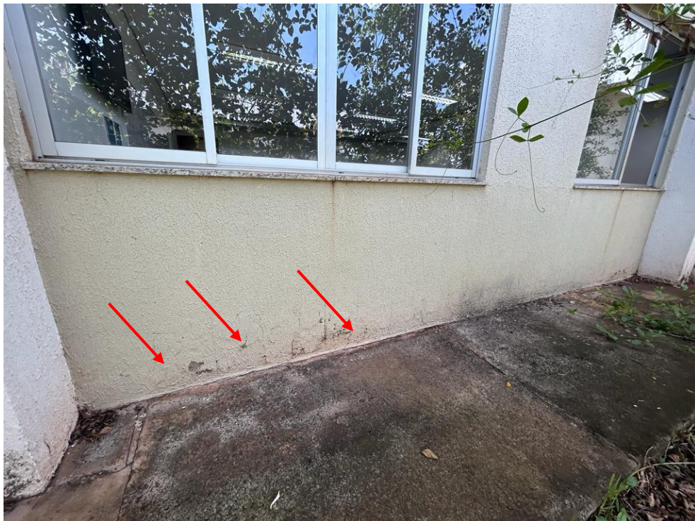
Figura 4.19 – Fissura na textura externa por perda da flexibilidade
