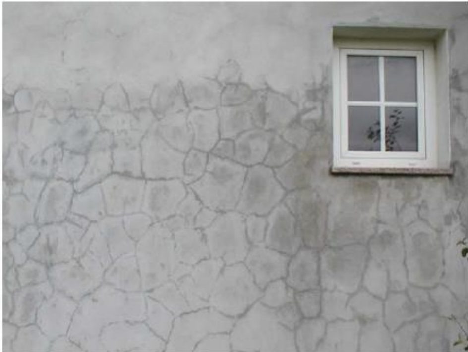
Figura 2.15 – Fissuras mapeadas evidente na pintura
