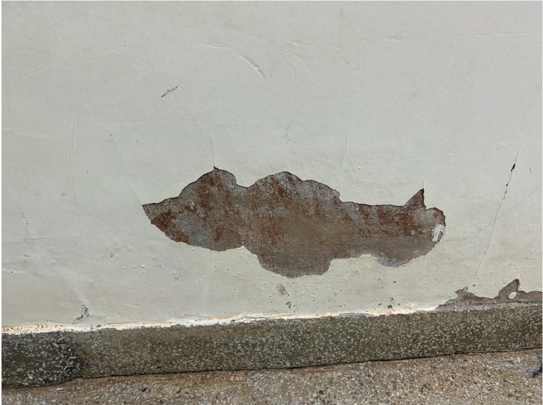
Figura 4.30 – Eflorescência em parede interna com descascamento devido a presença de umidade
