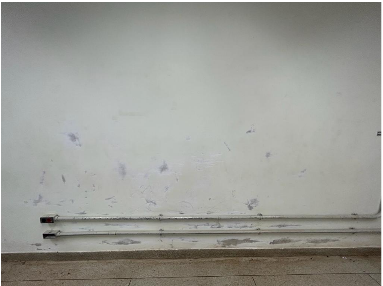
Figura 2.16 – Desgaste em pintura por atrito e sujidades
