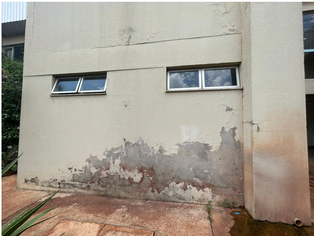
Figura 4.6 – Manifestação patológica em parede externa: descascamento por infiltração
