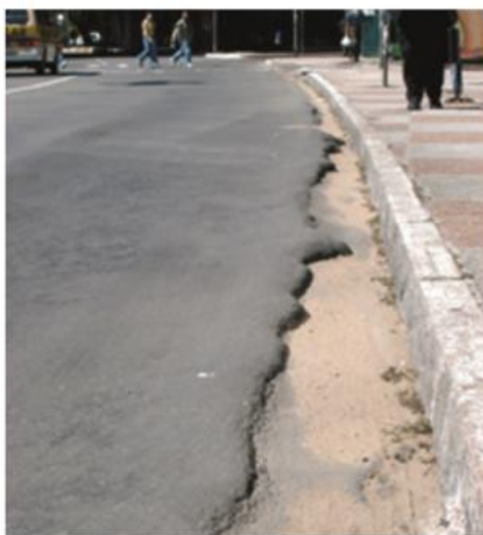
Figura 16 - Escorregamento de massa
