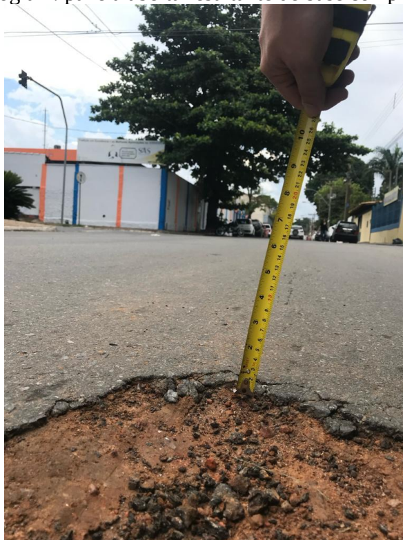
Figura 58 - Patologia 2: panela aberta resultante de base comprometida - 5ª etapa
