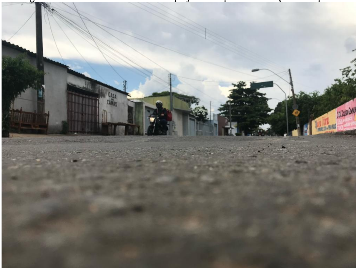
Figura 69 - Nível de rolamento da via prejudicado pela manutenção inadequada
