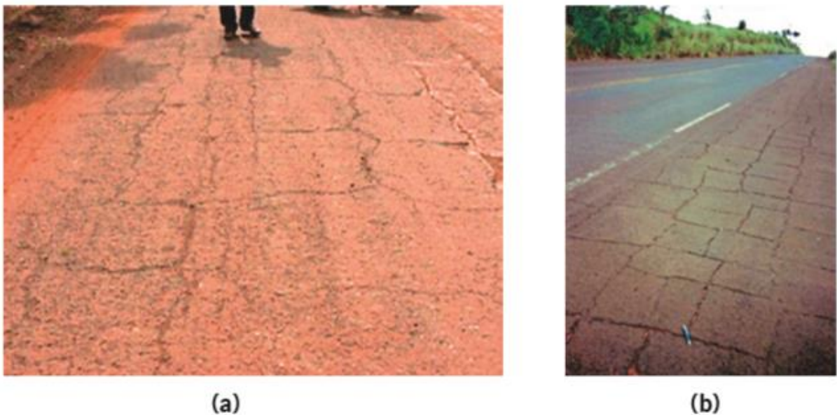
Figura 9 - Trinca em bloco– (a) com erosão da borda e (b) sem erosão
