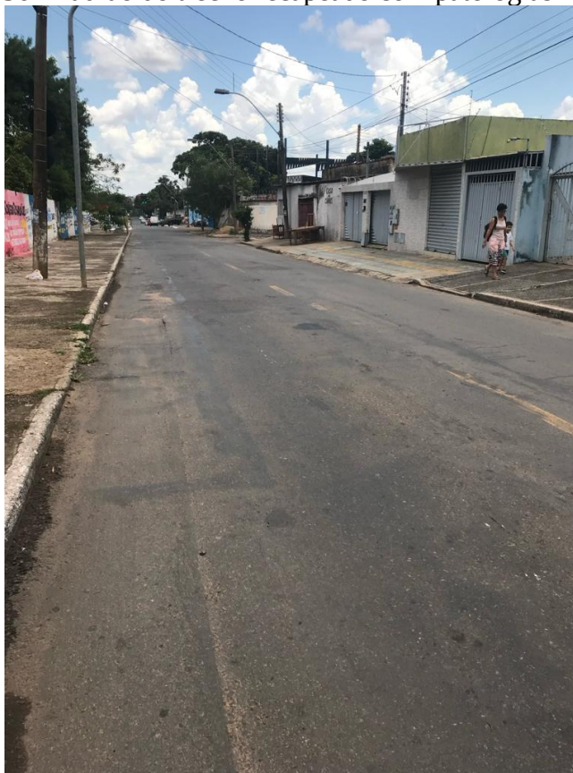
Figura 56 - Padrão do trecho recapeado com patologias - 5ª etapa
