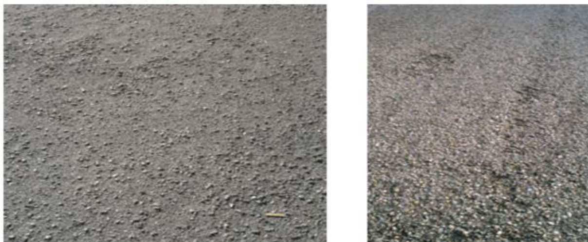
Figura 19 - Desgaste ou desagregação
