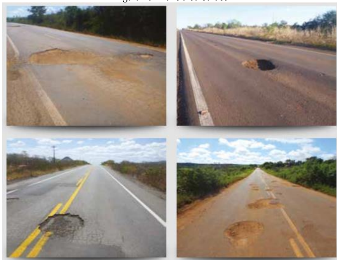
Figura 20 - Panela ou buraco
