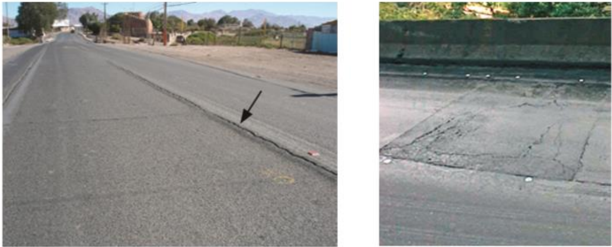
Figura 10 - Trinca de retração
