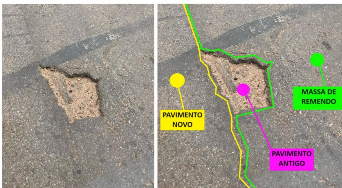
Figura 59 - Patologia 3: início de panela resultante de base comprometida - 5ª etapa
