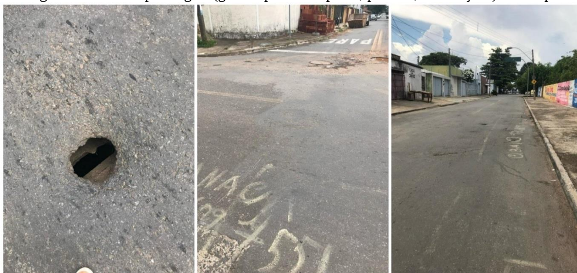
Figura 60 - Outras patologias (galeria pluvial exposta; panelas; ondulações) - 5ª etapa
