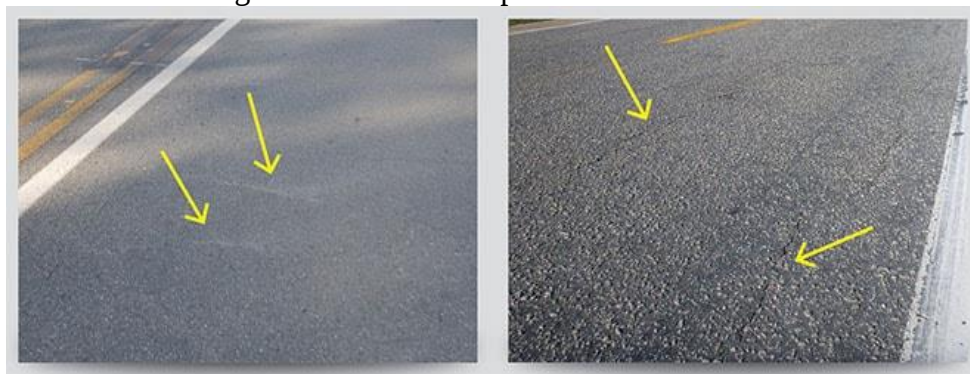
Figura 5 – Fissura nos pavimentos asfálticos
