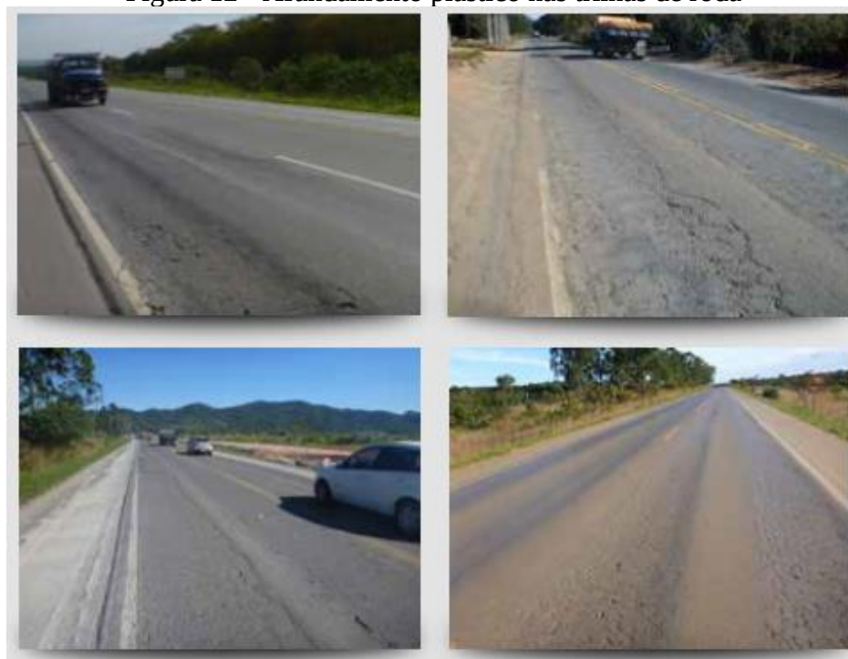
Figura 12 - Afundamento plástico nas trilhas de roda
