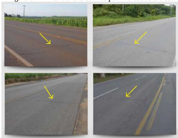
Figura 6 - Trinca transversal nos pavimentos asfálticos
