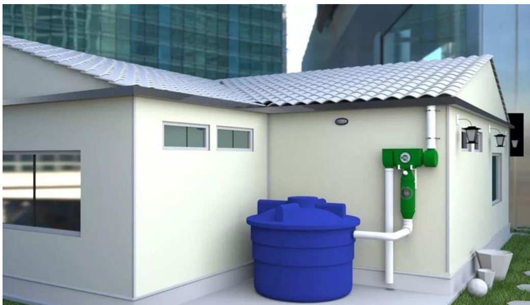
Figura 6 - Reservatório de armazenamento
