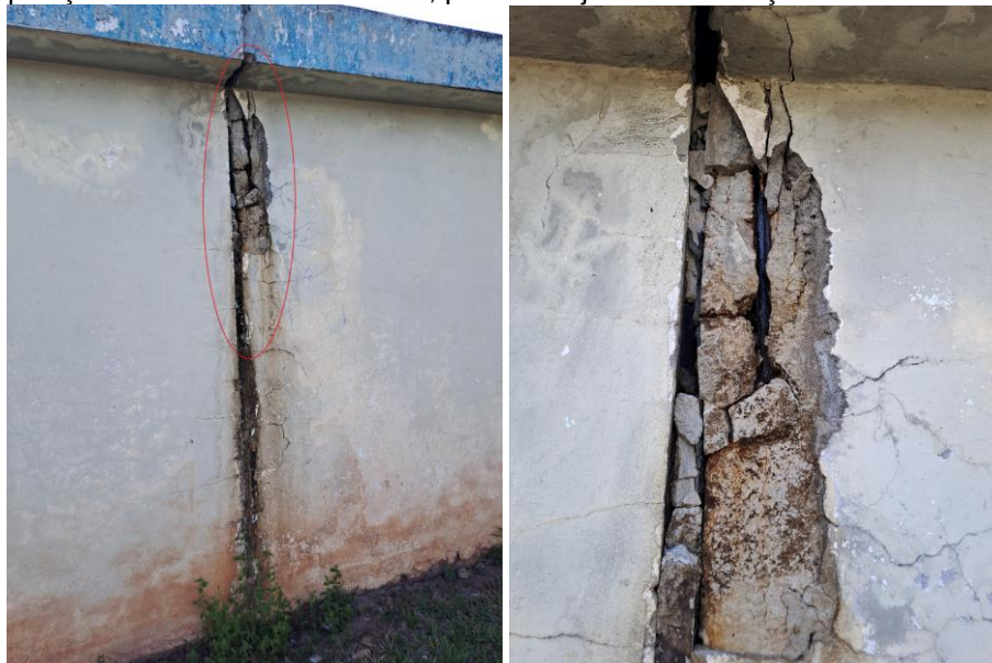
Figura 105 – Fissura do revestimento, com deslocamento do concreto, exposição e corrosão da armadura, próximo a junta de dilatação.
