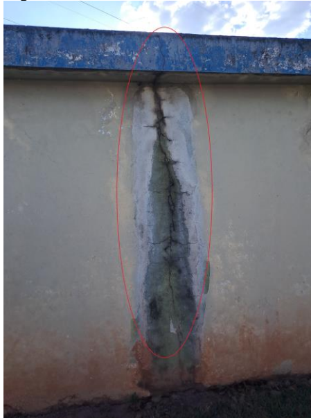
Figura 101 – Fissura do revestimento.
