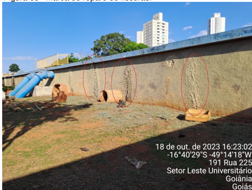
Figura 83– Marca de reparo de fissuras.
