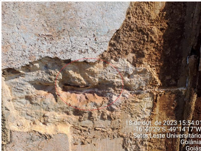
Figura 74 –Desplacamento do revestimento com exposição e corrosão da armadura.
