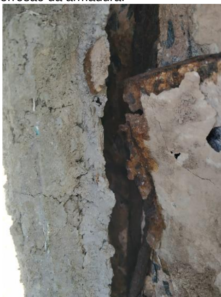
Figura 71 – Detalhe do Desplacamento do revestimento com exposição e corrosão da armadura.
