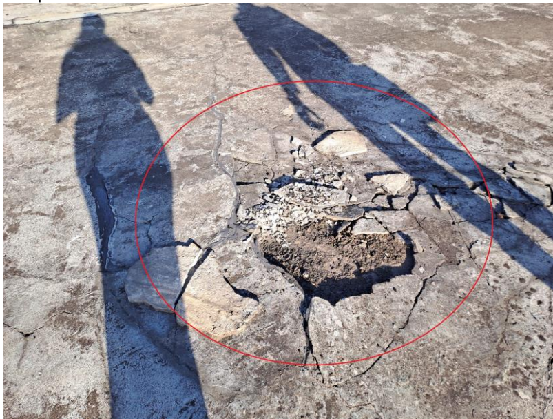
Figura 111– Vista externa da laje de cobertura, com presença de deslocamento do revestimento.
