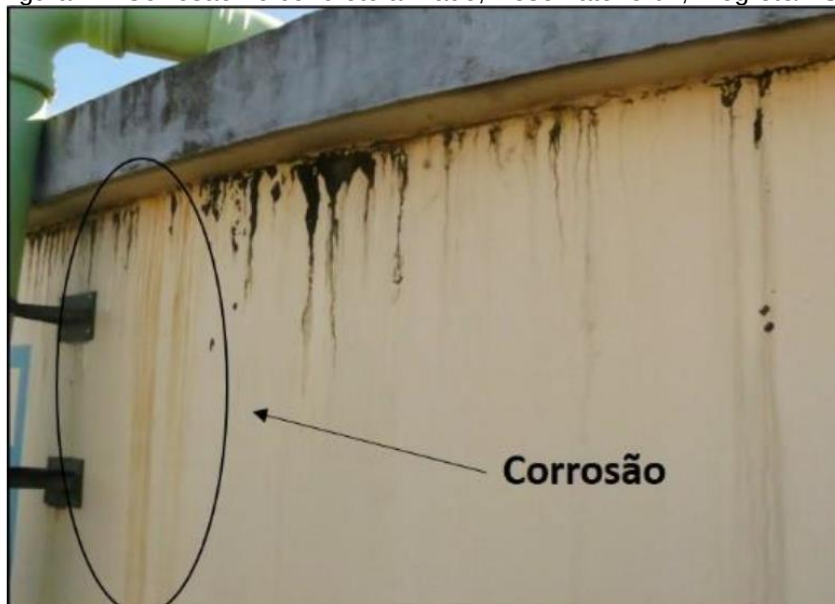
Figura 22. Corrosão no concreto armado, Reservatório 01, Alegrete/RS.
