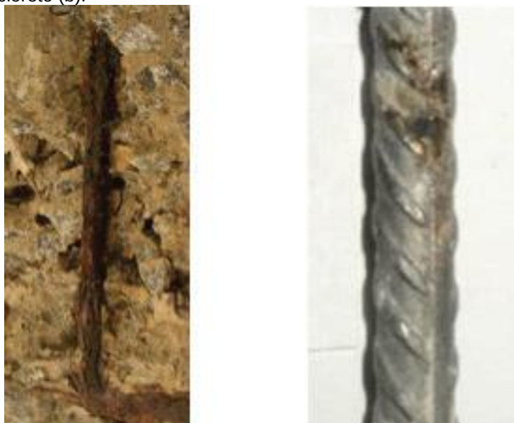
Figura 20. Aparência superficial da corrosão generalizada desencadeada pela carbonatação do concreto (a) e da corrosão puntiforme desencadeada pela ação dos íons cloreto (b).
