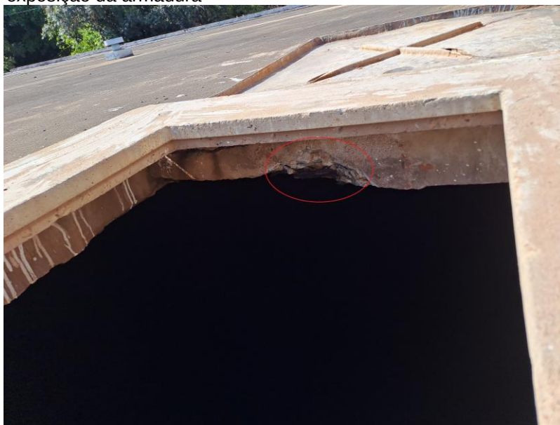
Figura 60 – Abertura na laje, com deslocamento do concreto e exposição da armadura
