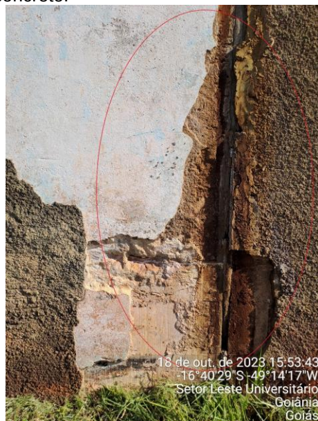
Figura 72 – Detalhe do Desplacamento do revestimento com exposição do concreto.
