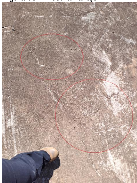
Figura 58 – Fissura na laje.
