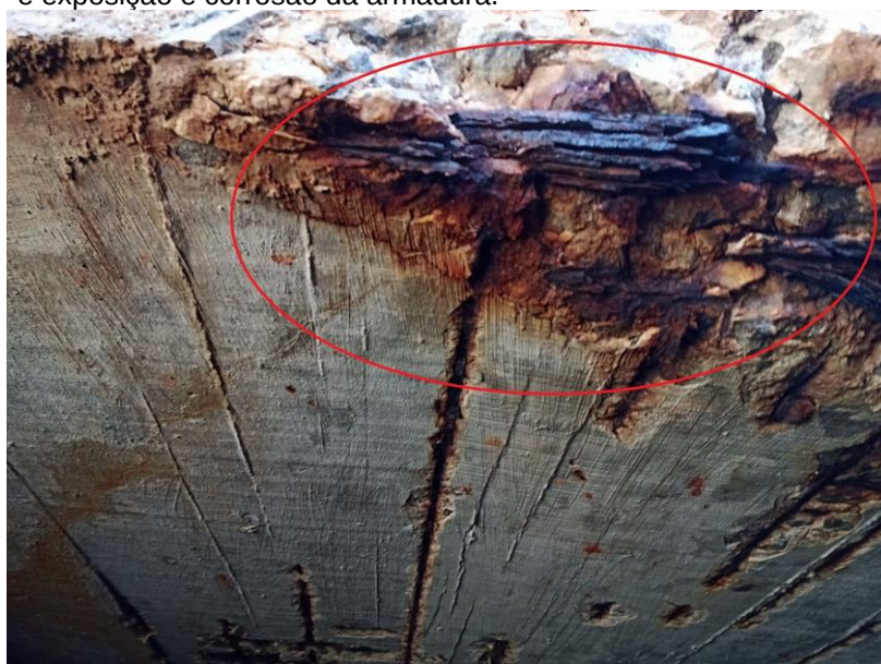
Figura 61 – vista interna da laje, com deslocamento do concreto e exposição e corrosão da armadura.
