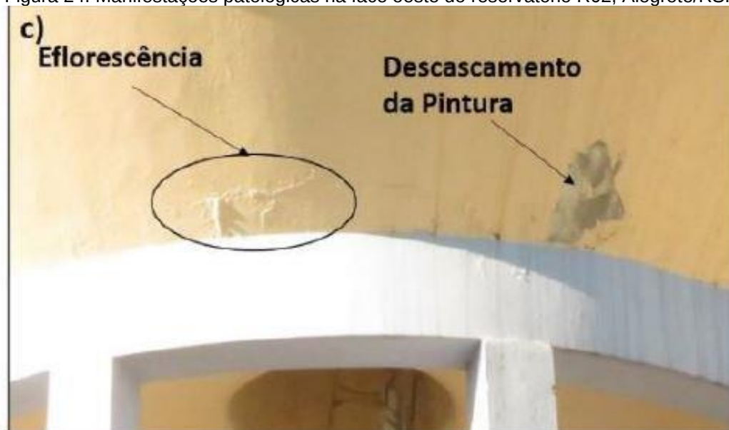
Figura 24. Manifestações patológicas na face oeste do reservatório R02, Alegrete/RS.
