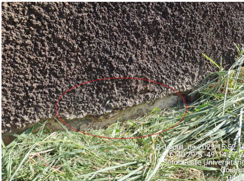
Figura 75 –Desplacamento do revestimento com exposição do concreto.
