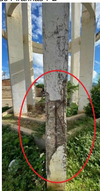
Figura 23. Desplacamento do concreto e exposição das armaduras no pilar. São José de Piranhas-PB
