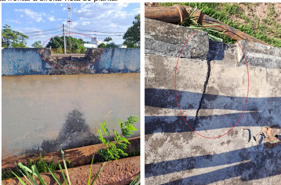
Figura 110 – Fissura com exposição e corrosão da armadura, a esquerda vista frontal a direita vista de planta.
