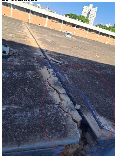
Figura 56 – Fissura na laje na junta de dilatação
