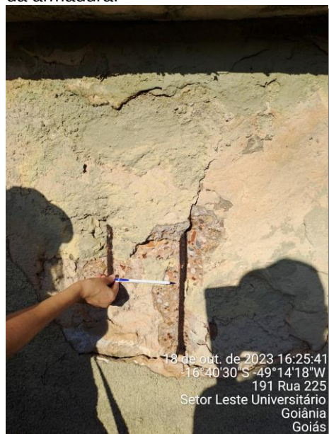
Figura 87 – Detalhe do deslocamento do revestimento e do concreto com exposição e corrosão da armadura.
