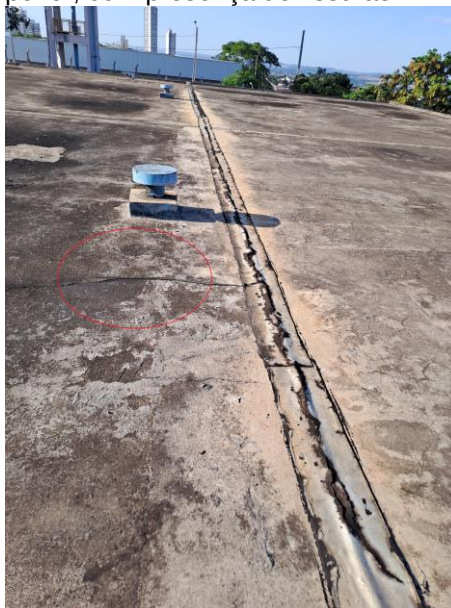
Figura 109 – Vista externa da laje superior, com presença de fissuras.
