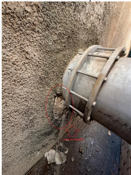
Figura 53 – Desplacamento do revestimento e do concreto no local da conexão com a tubulação.
