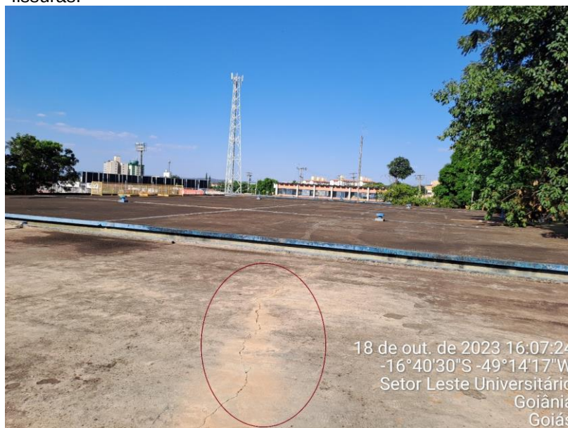
Figura 92 – Vista externa da laje de cobertura, com presença de fissuras.
