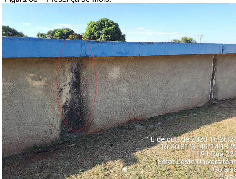
Figura 88 – Presença de mofo.
