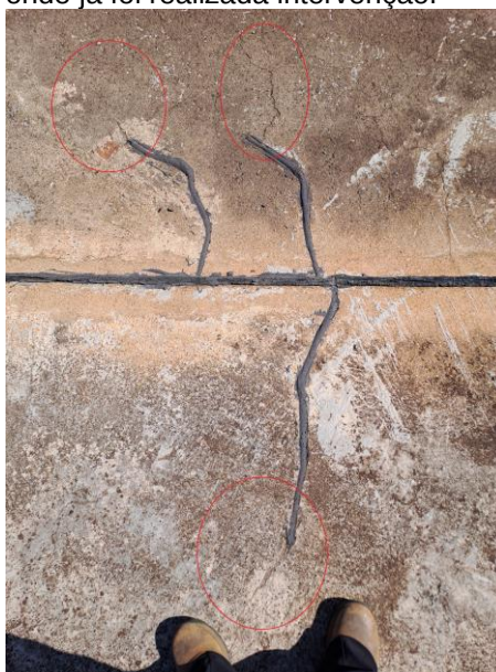
Figura 57 – Fissura na laje, em locais onde já foi realizada intervenção.
