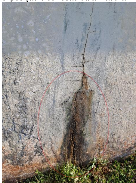
Figura 107 – Vazamento com exposição e corrosão da armadura.
