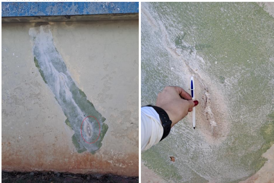
Figura 102 – Eflorescência onde já foi tratada fissura. A esquerda visão geral e a direita detalhamento.
