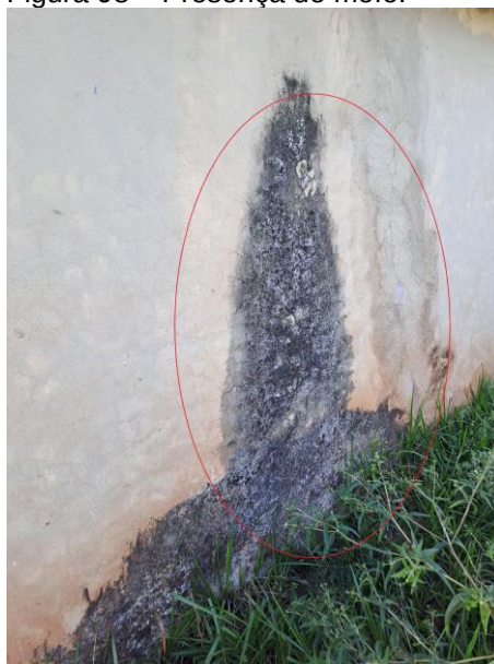
Figura 98 – Presença de mofo.
