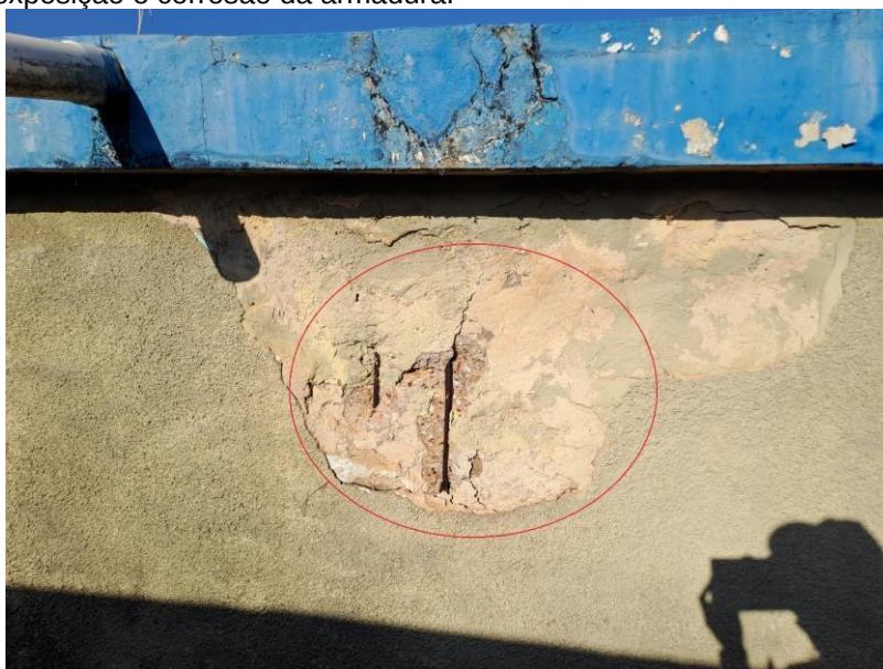
Figura 86 – Desplacamento do revestimento e do concreto com exposição e corrosão da armadura.
