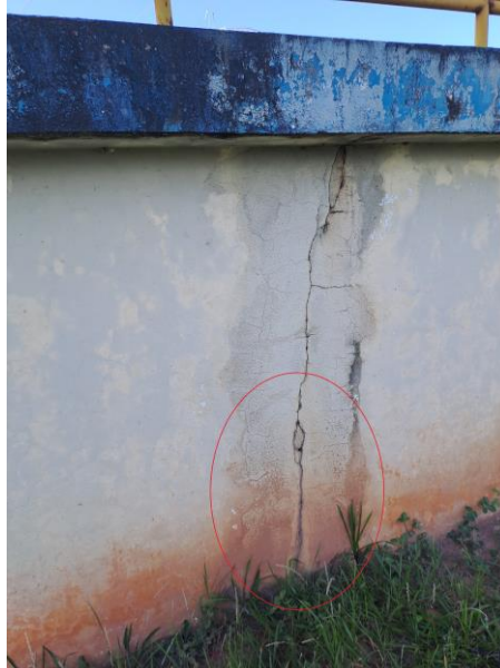
Figura 104 – Fissura do revestimento.
