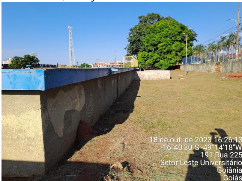
Figura 82 – Vista externa geral do RA 04 Reservatório semi-enterrado Senac, Saneago.
