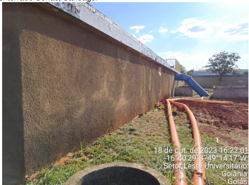
Figura 81 – Vista externa geral do RA 04 Reservatório semi-enterrado Senac, Saneago.
