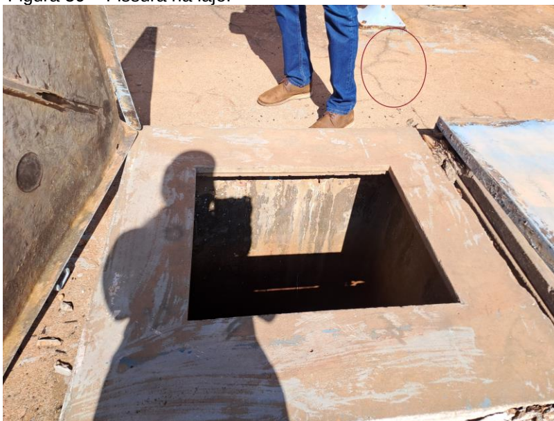
Figura 59 – Fissura na laje.
