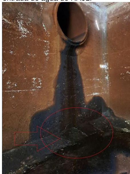
Figura 43 – Erosão na primeira entrada de água do RA01.
