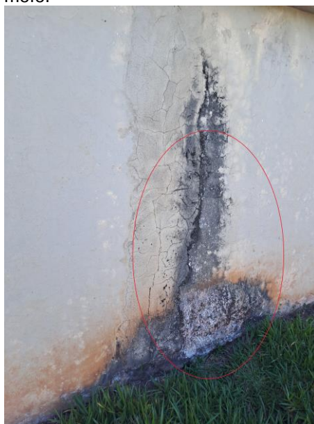
Figura 99 – Fissura com presença de mofo.
