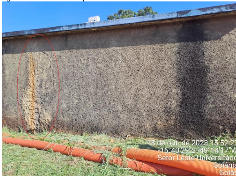
Figura 67 – Marca de reparo de fissuras.
