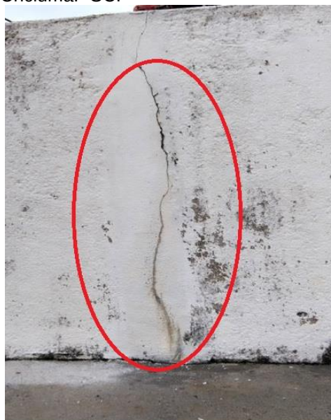
Figura 27. Fissura no Reservatório R0, Criciúma. -SC.
