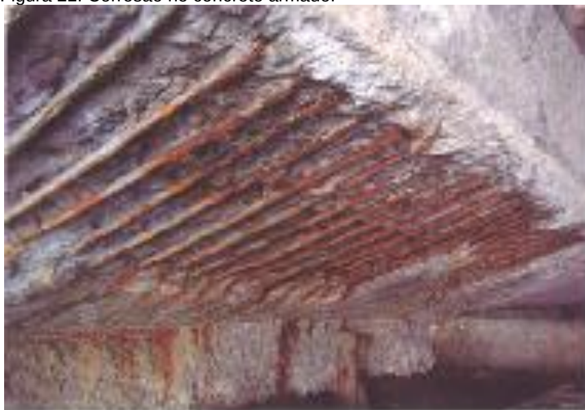
Figura 21. Corrosão no concreto armado.
