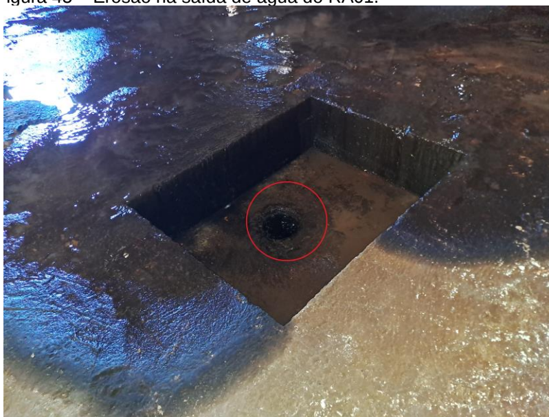
Figura 45 – Erosão na saída de água do RA01.
