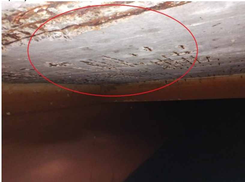
Figura 76 – Vista interna da laje, com deslocamento do concreto e exposição e corrosão da armadura.
