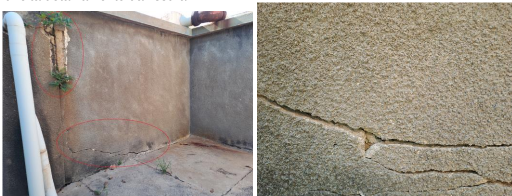
Figura 51– A esquerda revestimento com fissura, deslocamento e presença de plantas, a direita detalhamento da fissura.
