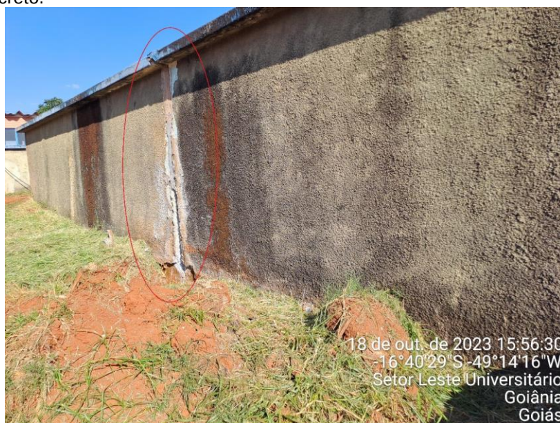
Figura 73 –,Desplacamento do revestimento com exposição do concreto.
