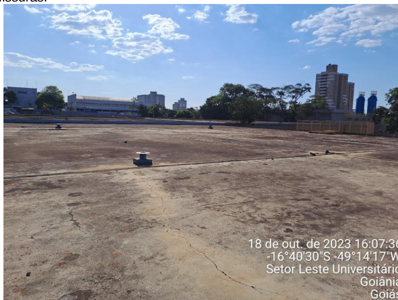
Figura 91 – Vista externa da laje de cobertura, com presença de fissuras.
