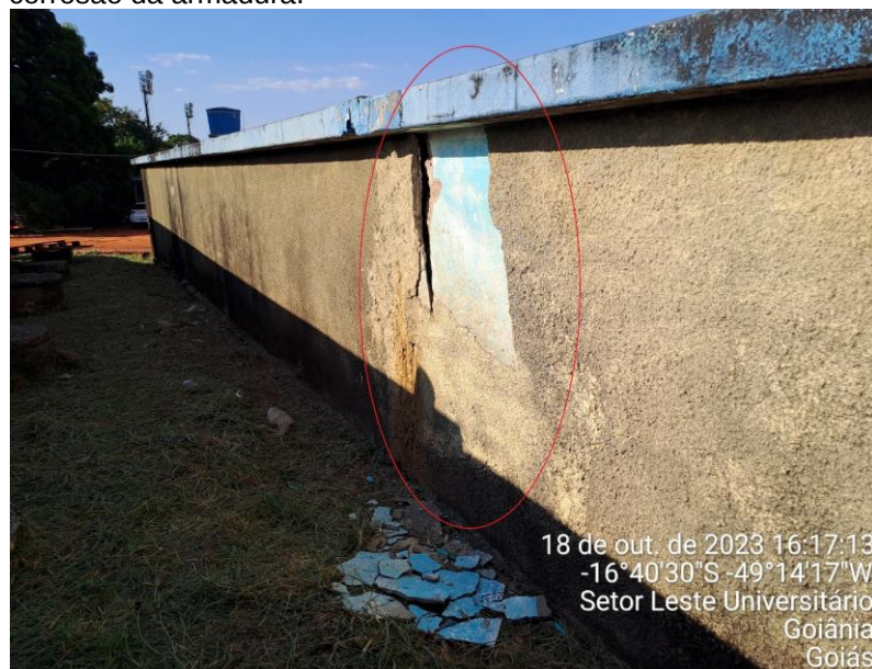
Figura 70 –Desplacamento do revestimento com exposição e corrosão da armadura.
