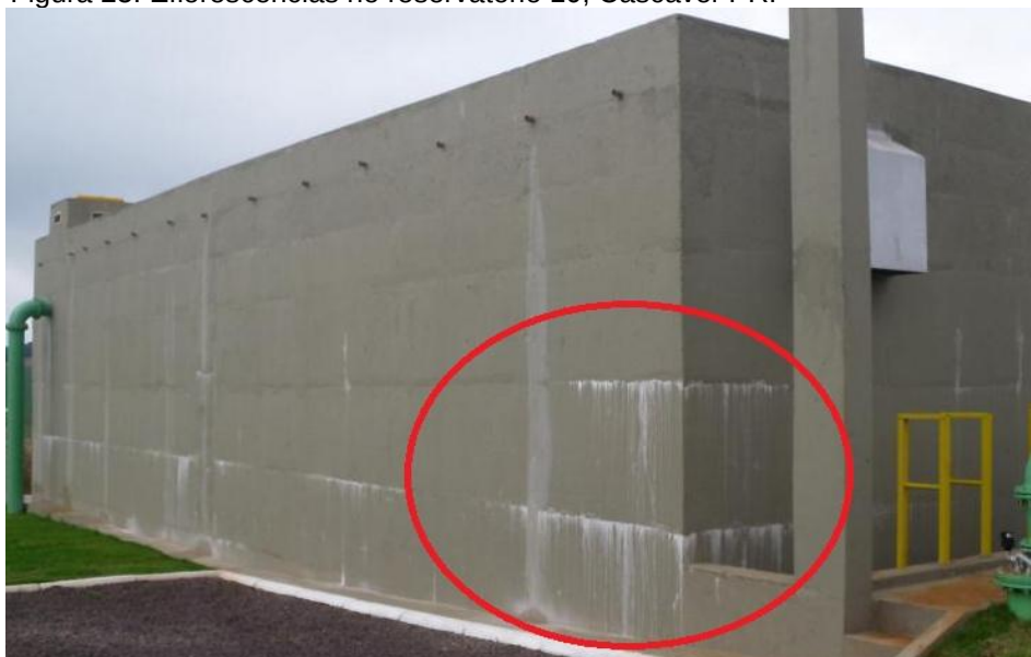
Figura 25. Eflorescências no reservatório 10, Cascavel-PR.
