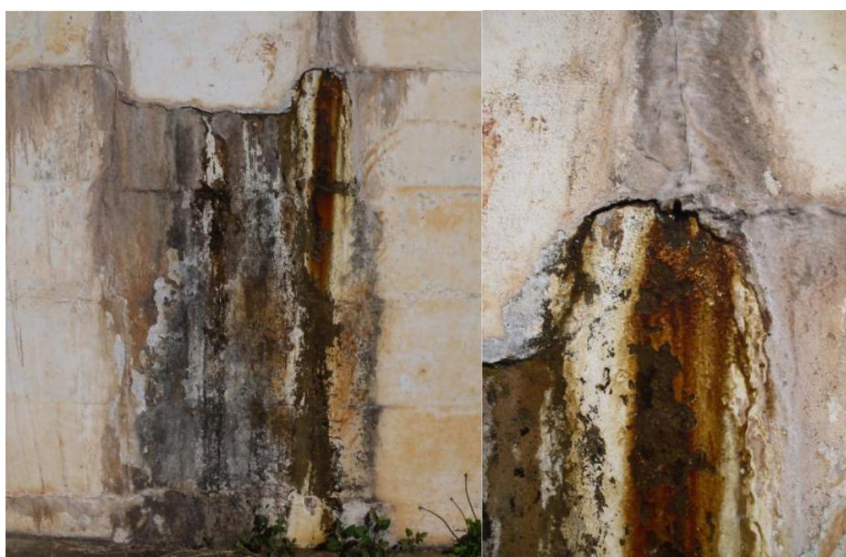
Figura 4 – Patologia perto da base no reservatório 01- Cascavel-PR.
