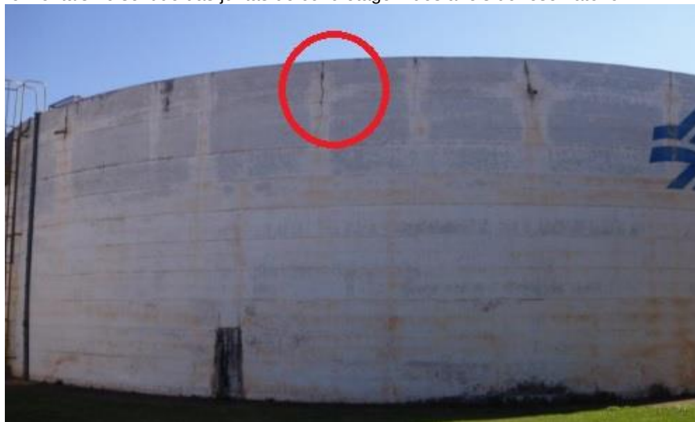
Figura 3 – Manifestações Patológicas no reservatório 01 Cascavel-PR - fissuras horizontais no sentido das juntas de concretagem dos anéis do reservatório.
