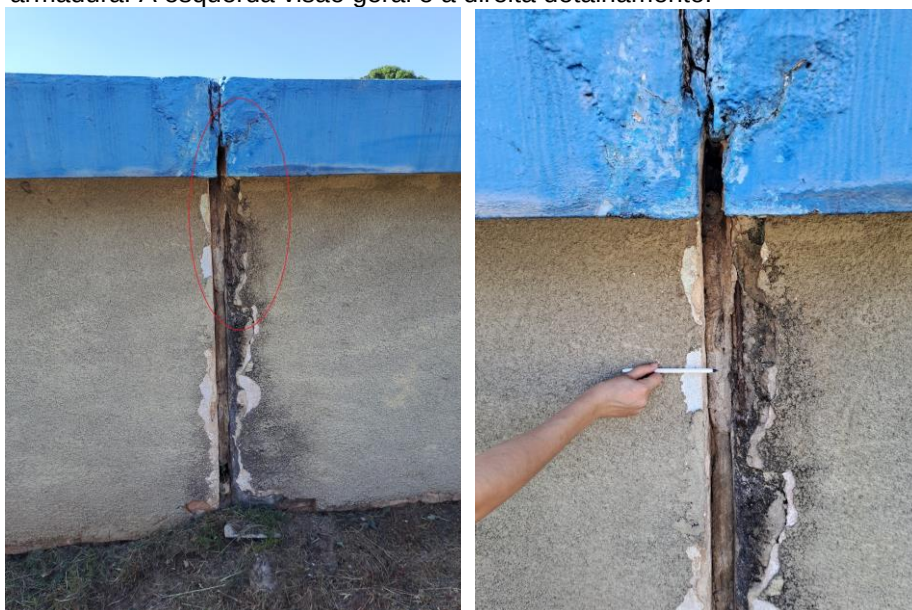
Figura 85 – Desplacamento do revestimento com exposição e corrosão da armadura. A esquerda visão geral e a direita detalhamento.
