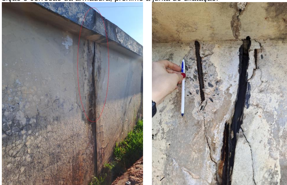
Figura 106 – Fissura do revestimento, com deslocamento do concreto, exposição e corrosão da armadura, próximo a junta de dilatação.
