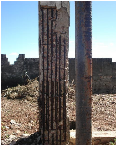
Figura 2: – Pilar de reservatório do município de São Tomé-RN, também apresentando corrosão nas armaduras, perda de seção e intenso deslocamento de concreto.
