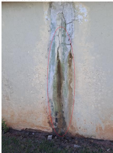
Figura 100 - Fissura do revestimento, com marcas de umidade.
