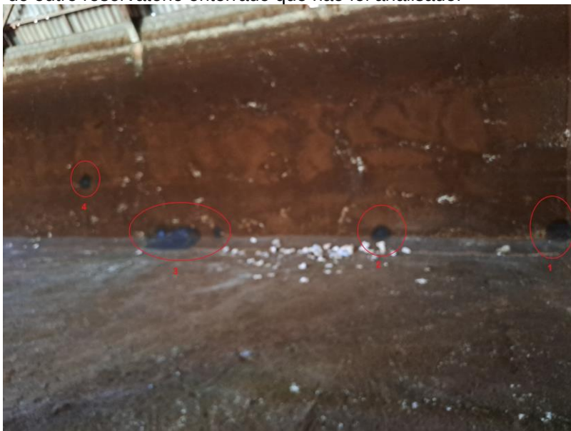
Figura 38 – Marcas de umidade na parede RA01 que fica ao lado do outro reservatório enterrado que não foi analisado.
