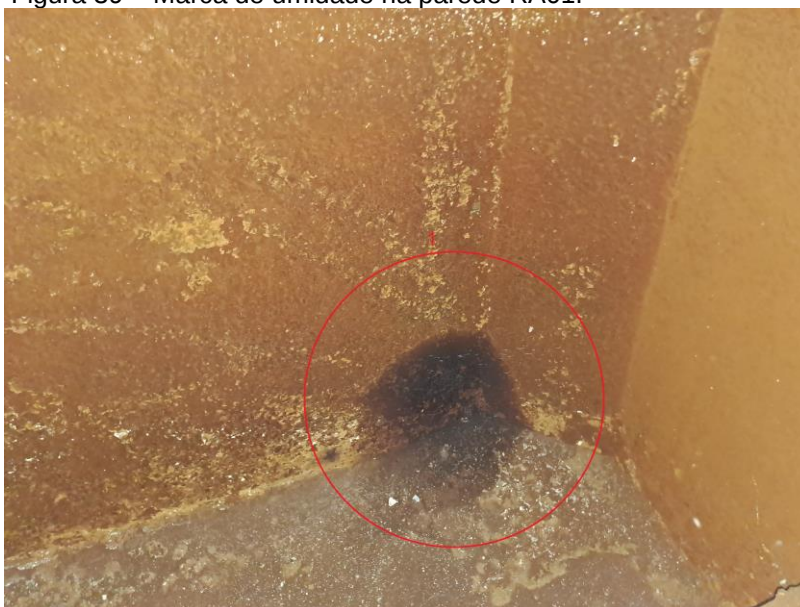
Figura 39 – Marca de umidade na parede RA01.
