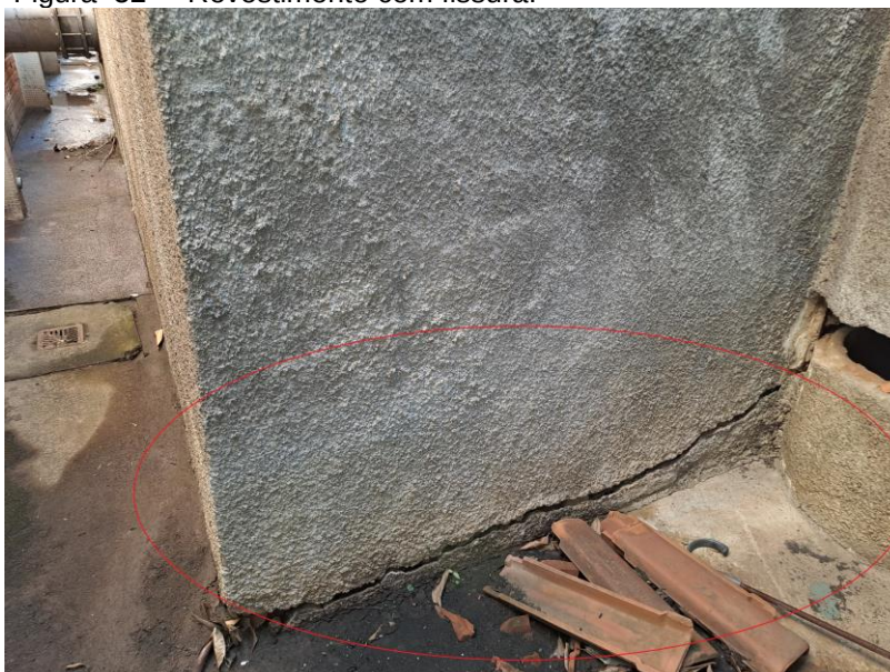
Figura 52 – Revestimento com fissura.
