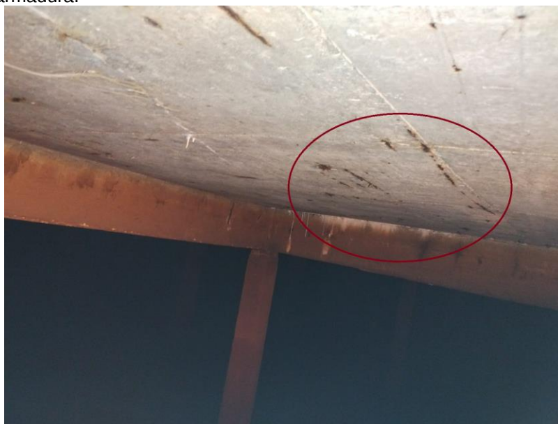
Figura 112 – Vista interna da laje, com exposição e corrosão da armadura.
