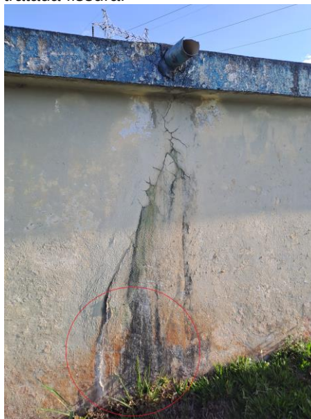
Figura 103– Eflorescência onde já foi tratada fissura.
