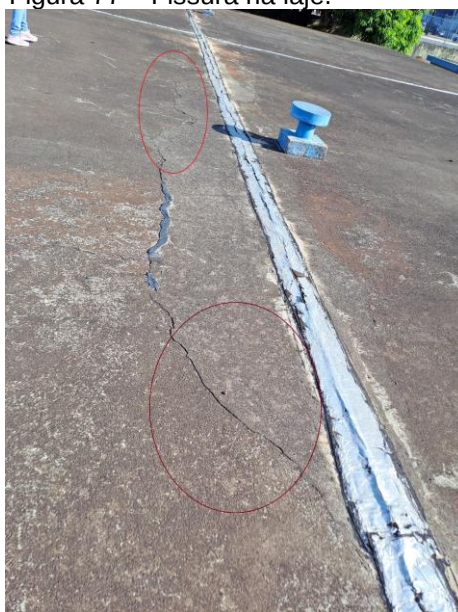
Figura 77 – Fissura na laje.
