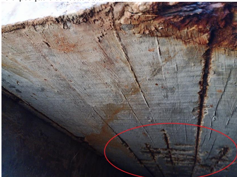
Figura 62 – vista interna da laje, com deslocamento do concreto e exposição e corrosão da armadura.
