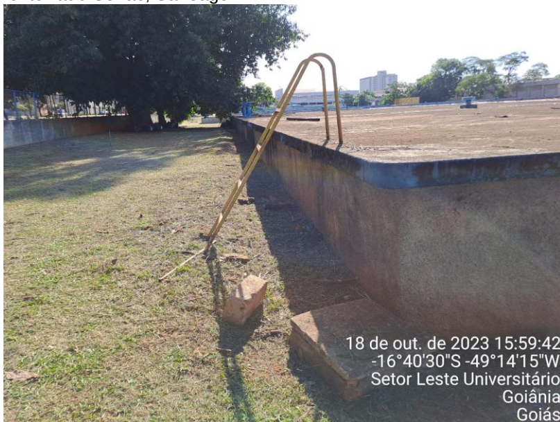
Figura 66 –Vista externa geral do RA 03 Reservatório semi-enterrado Senac, Saneago.
