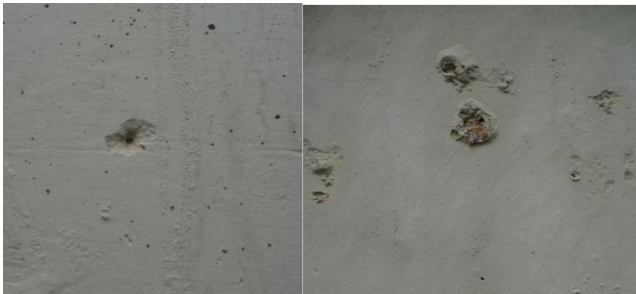
Figura 26. Criptoflorescências no reservatório 02, Cascavel-PR.
