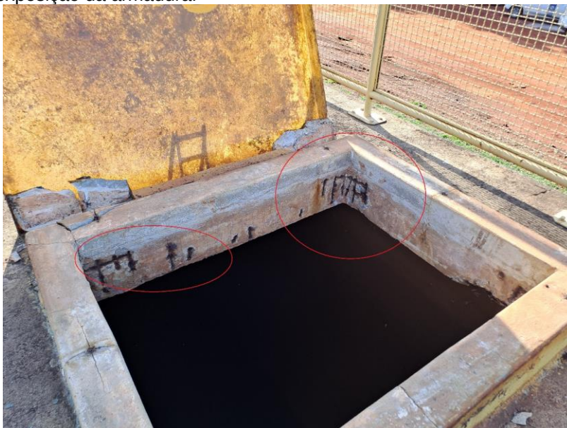
Figura 89 – Abertura na laje, com deslocamento do concreto e exposição da armadura.
