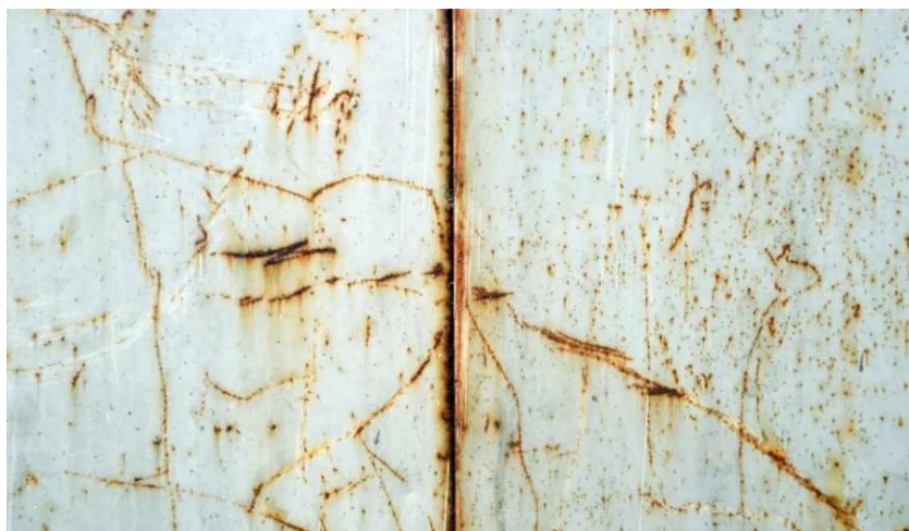
Figura 8 - Corrosão filiforme em superfície metálica
