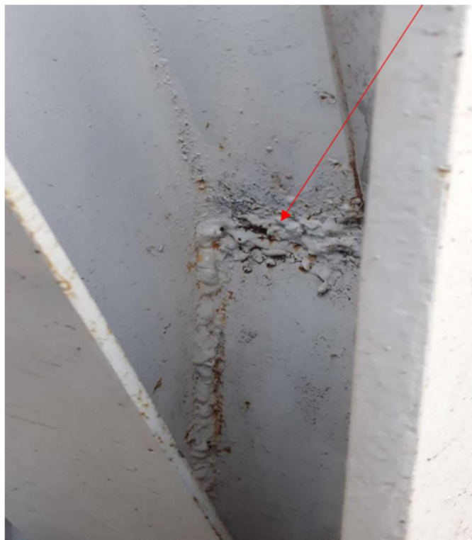
Figura 25 - Solda - Presença de porosidade na solda
