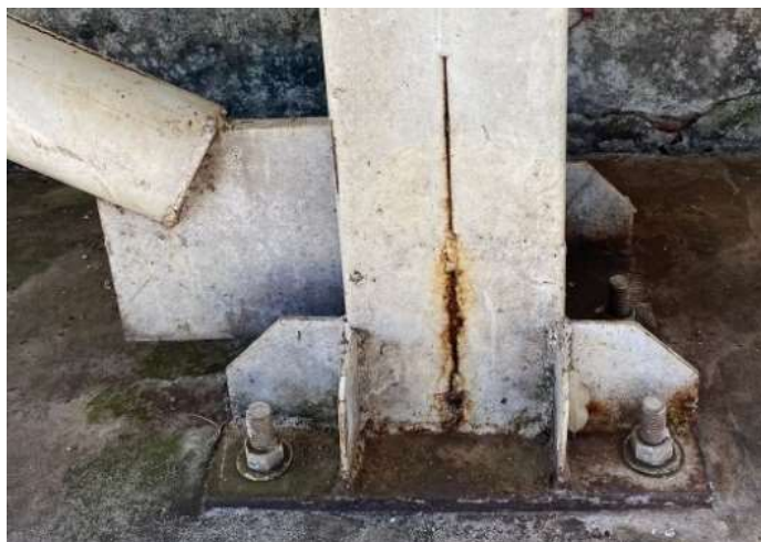
Figura 37 - Base do pilar 2 - Galpão - corrosão uniforme e puntiforme
