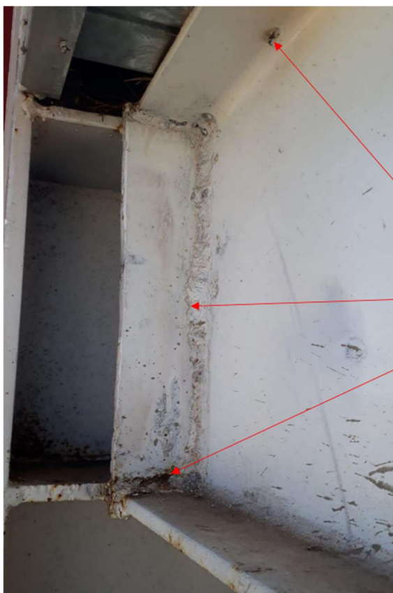
Figura 28 - Solda - Sobreposições e falta de fusão
