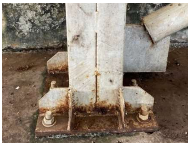
Figura 36 - Base do pilar 1 - Galpão - corrosão uniforme e puntiforme
