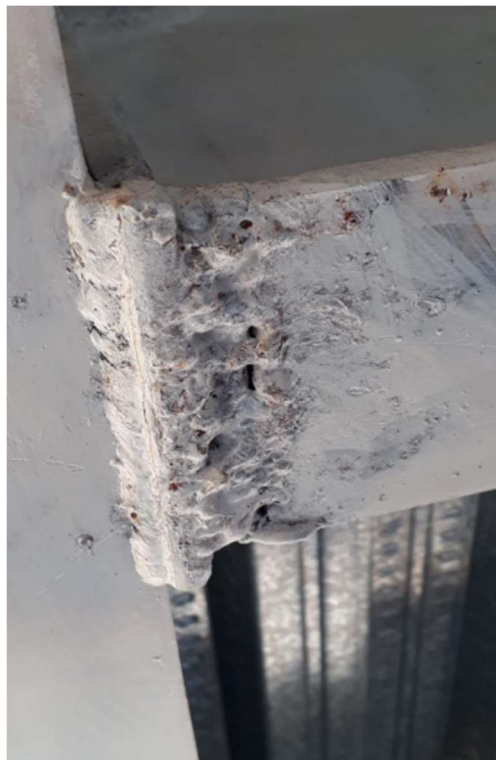
Figura 32 - Solda - Presença de porosidade
