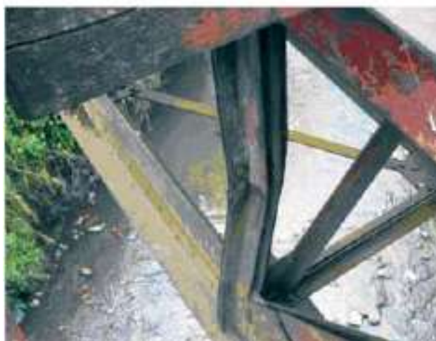
Figura 16 - Flambagem Global - Montante de uma treliça
