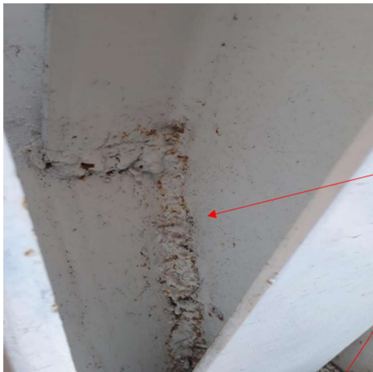
Figura 27 - Solda - Presença de porosidade
