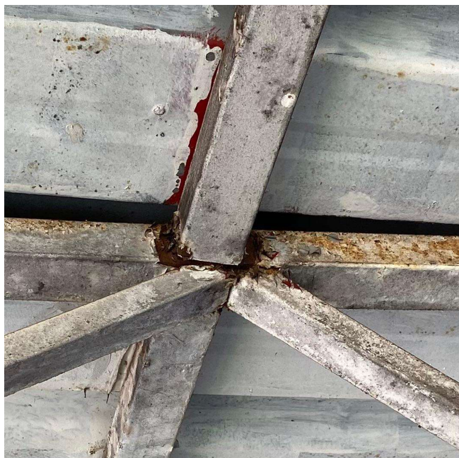
Figura 41 – Cobertura do ponto de ônibus – Enrugamento da tinta
