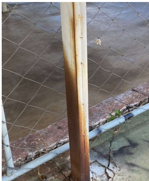
Figura 39 – Pilar 1 - ponto de ônibus - corrosão uniforme
