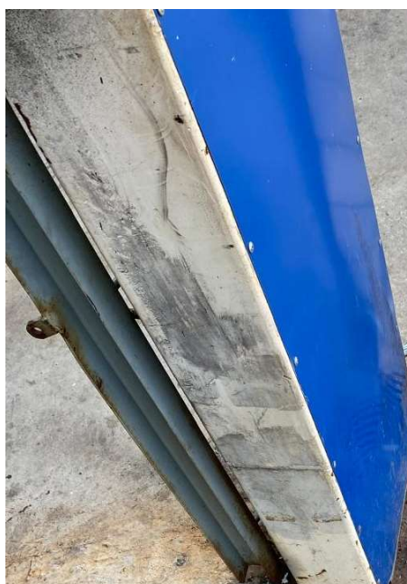
Figura 42 – Pilar da entrada do galpão – Sangramento da tinta
