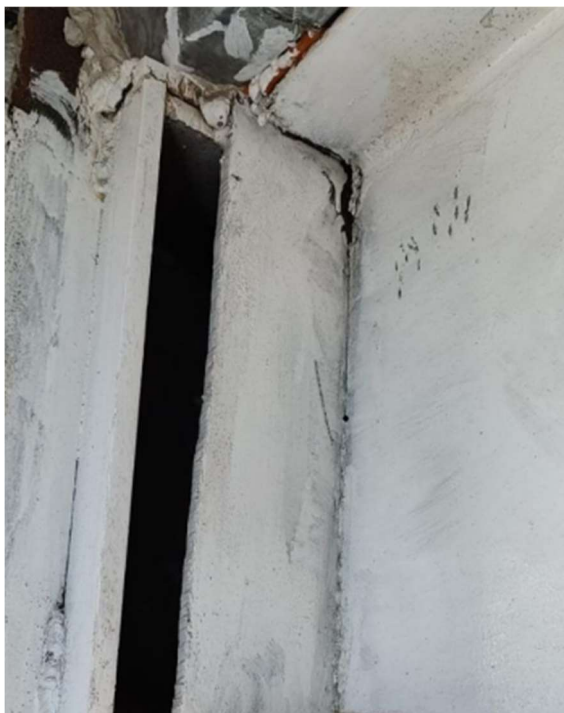
Figura 24 - Falhas na pintura – Porosidade – Impregnação
