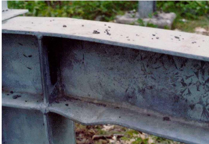
Figura 15 - Flambagem local em um perfil metálico
