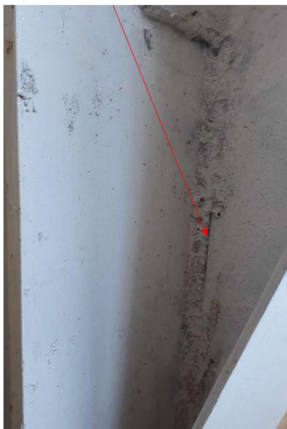
Figura 26 - Solda - Falta de penetração
