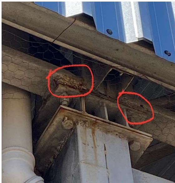
Figura 44 – Ligação no galpão – Solda – presença de porosidade
