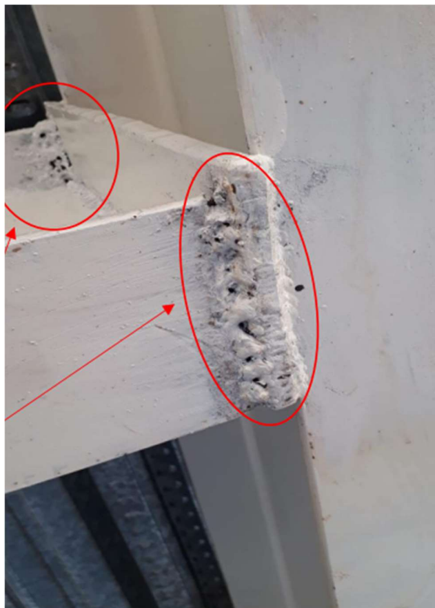
Figura 29 - Solda - Presença de porosidade
