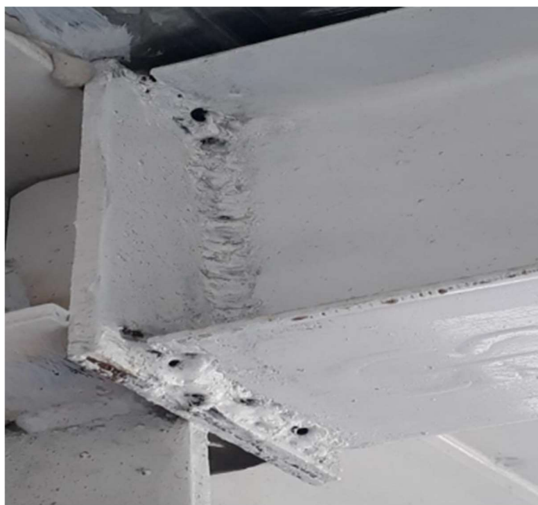
Figura 30 - Solda - Presença de porosidade
