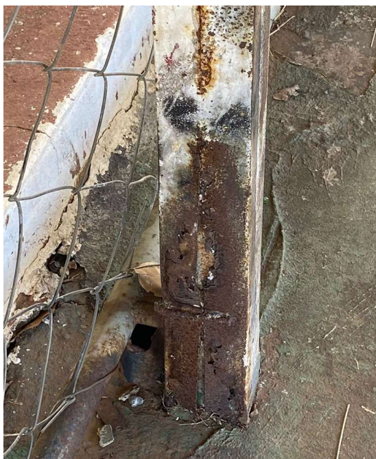
Figura 40 – Pilar 2 - ponto de ônibus - corrosão em placas
