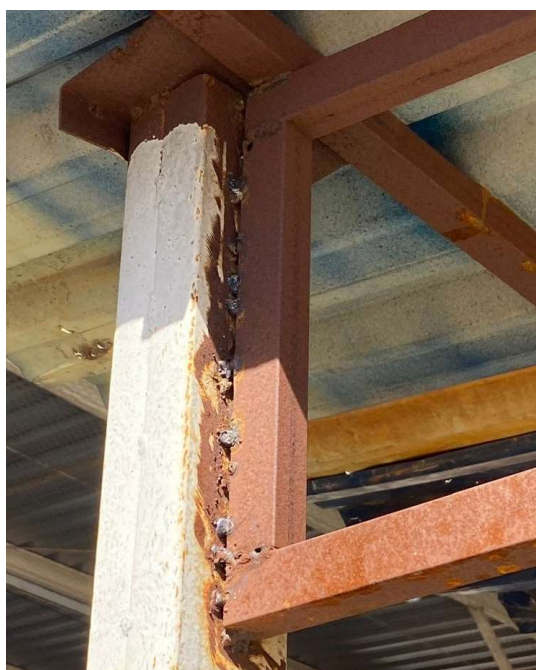
Figura 45 – Treliça - ponto de ônibus – Solda - Falta de penetração e fusão
