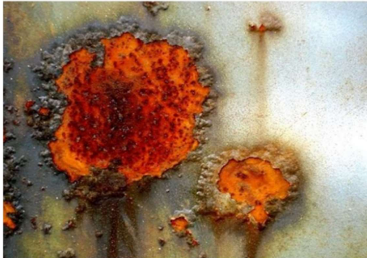
Figura 9 - Corrosão em placas na superfície metálica
