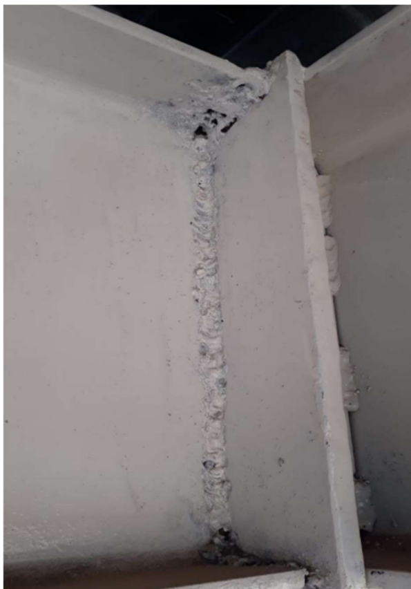
Figura 31 - Solda - Presença de porosidade
