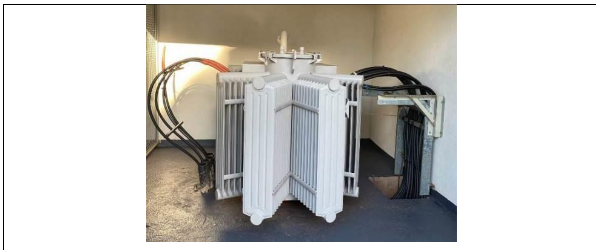
Figura 9 – Transformador de potência.
