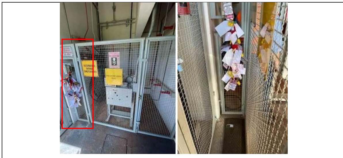
Figura 47 – Bloqueio realizado na seccionadora de alimentação de todo o circuito.
