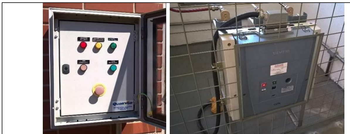
Figura 44 – Pannel de acionamento remoto do disjuntor de média tensão.
