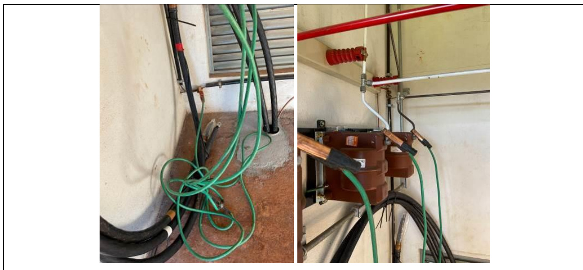
Figura 48 – Aterramento temporário acoplado no sistema.
