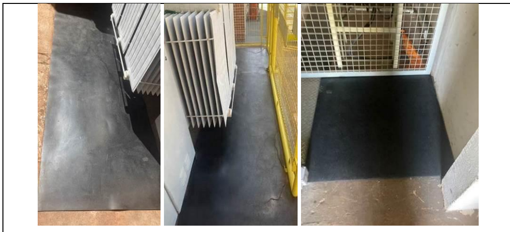
Figura 35 – Tapete de isolamento para cargas de alta tensão.
