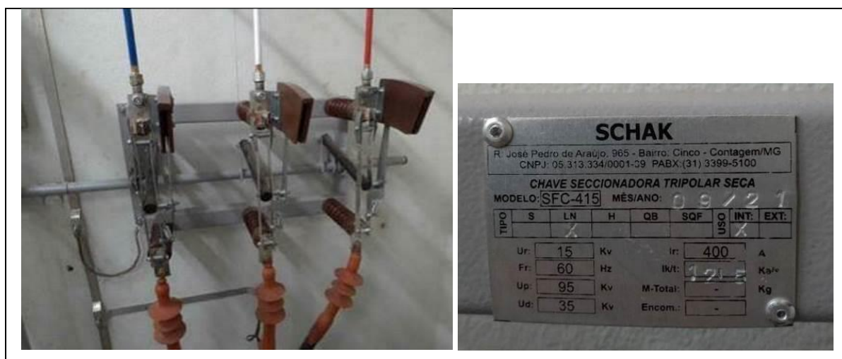
Figura 11 – Chave seccionadora sem fusível.
