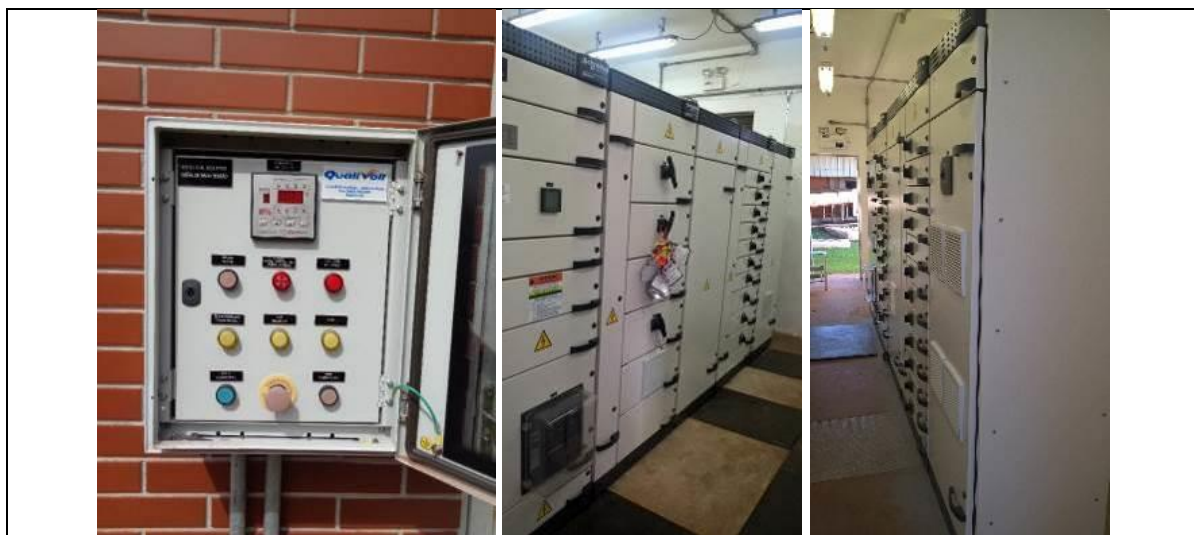
Figura 43 – Pannel de acionamento remoto do Quadro Geral De Baixa Tensão (QGBT).
