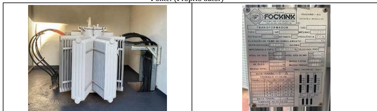
Figura 68 - Transformador de 750 KVA e sua placa de informação.
