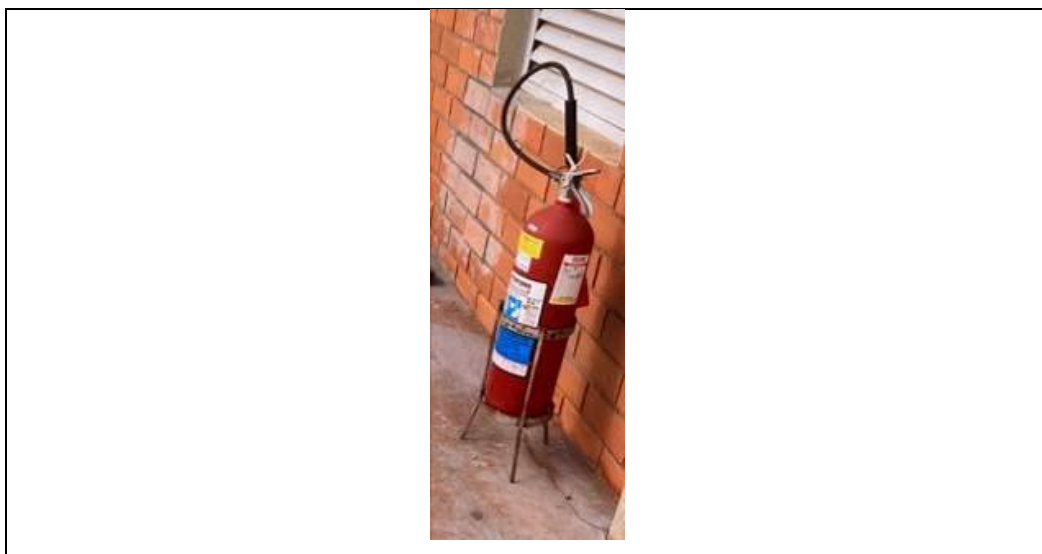
Figura 29 – Extintor de incêndio.
